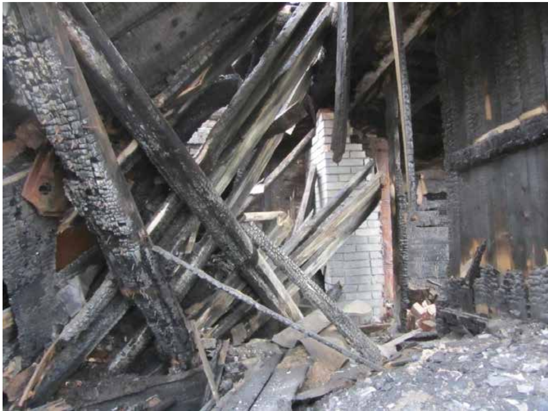
15. ОКН РЗ «Дача Гербель» по адресу: г. Санкт-Петербург, ул. Межозёрная, дом 4, литера А. на помещения здания, повреждённые пожаром. Дата съёмки: 06.04.2016 г.
