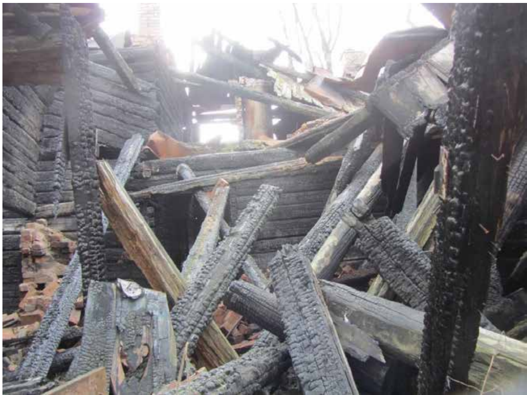
16. ОКН РЗ «Дача Гербель» по адресу: г. Санкт-Петербург, ул. Межозёрная, дом 4, литера А. Вид на помещения здания, повреждённые пожаром. Дата съёмки: 06.04.2016 г.
