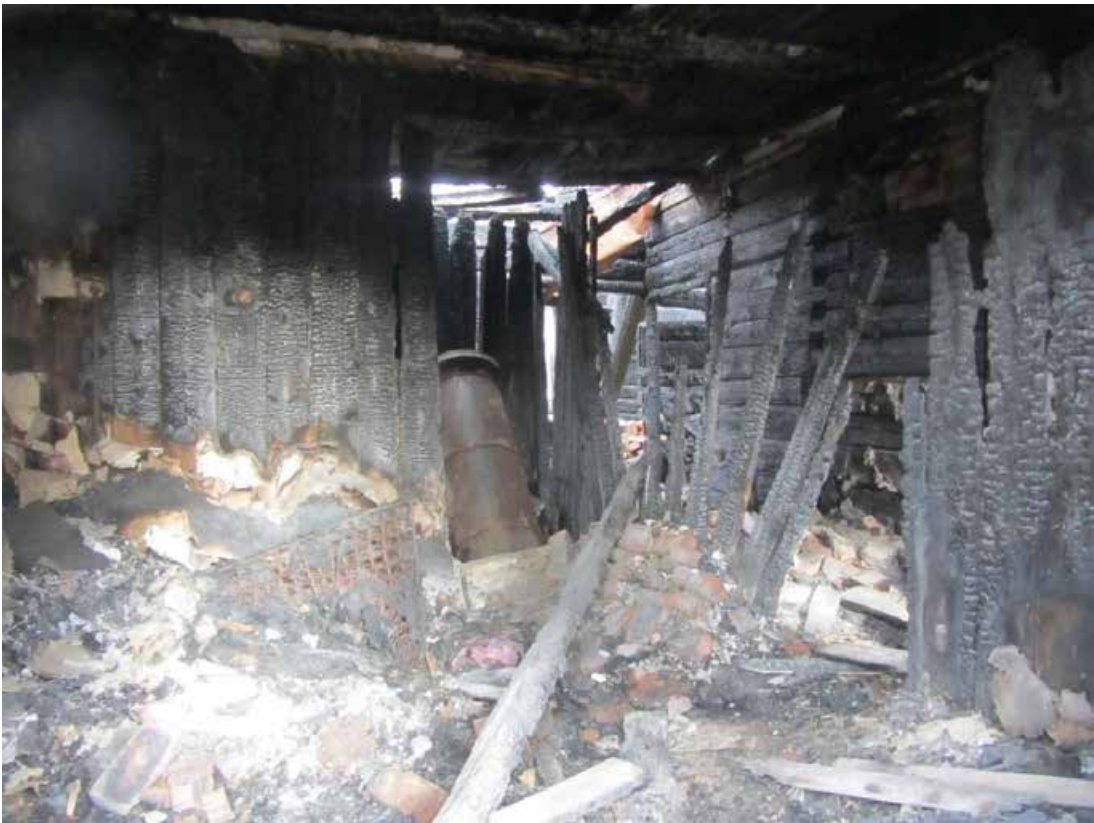
13. ОКН РЗ «Дача Гербель» по адресу: г.Санкт-Петербург, ул. Межозёрная, дом 4, литера А. Вид на помещения здания, повреждённые пожаром. Дата съёмки: 06.04.2016 г.
