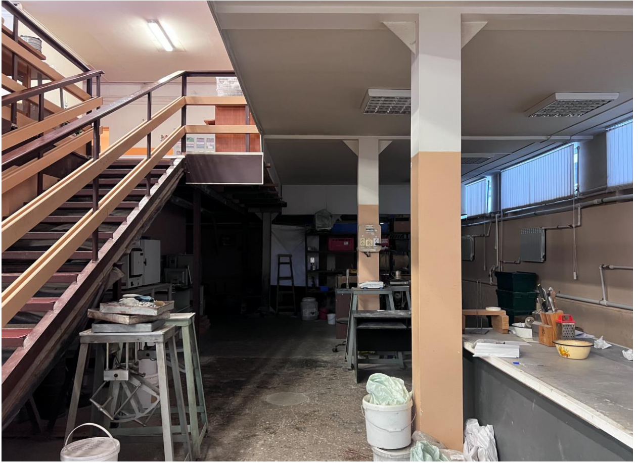
Фото 10. Объект культурного наследия регионального значения «Гидротехнический институт им. Б.Е. Веденеева (лицевой корпус с примыкающими дворовыми флигелями)», расположенный по адресу: Санкт-Петербург, Гжатская д. 21, лит. А. Помещение 143. Съёмка 01.04.2026 г.
