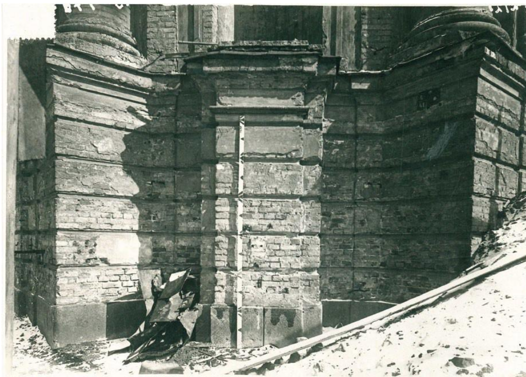
27. Сектор хранения документированной информации (архив) КГИОП. Фото №24090. Окружной суд после пожара. Ведется разборка здания.
