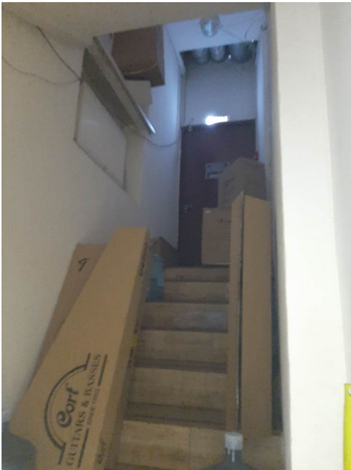
Фото 10. Выявленный объект культурного наследия «Дом М.А. Стенбок-Фермор» (г. Санкт-Петербург, Звенигородская ул., д.2/44, лит. А, помещение 3-Н). Подвал. Пом. №7 (нумерация по ПИБ): лестничный марш, ведущий во внутренний двор.
