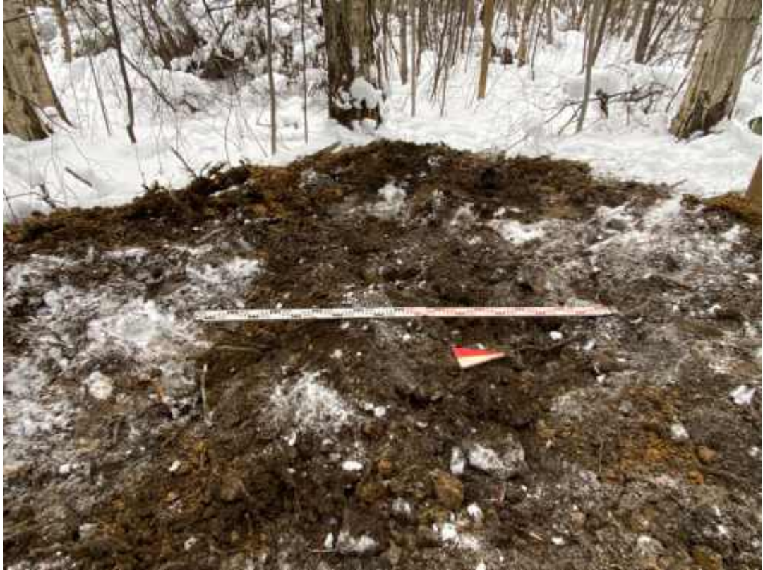
Рис. 65. Санкт-Петербург, земельный участок по объекту: «Проектирование строительства автомобильной дороги № 2 на участке от автомобильной дороги № 1 до кругового движения продолжения проспекта Маршала Блюхера». Шурф №3. Рекультивация. Вид с востока.
