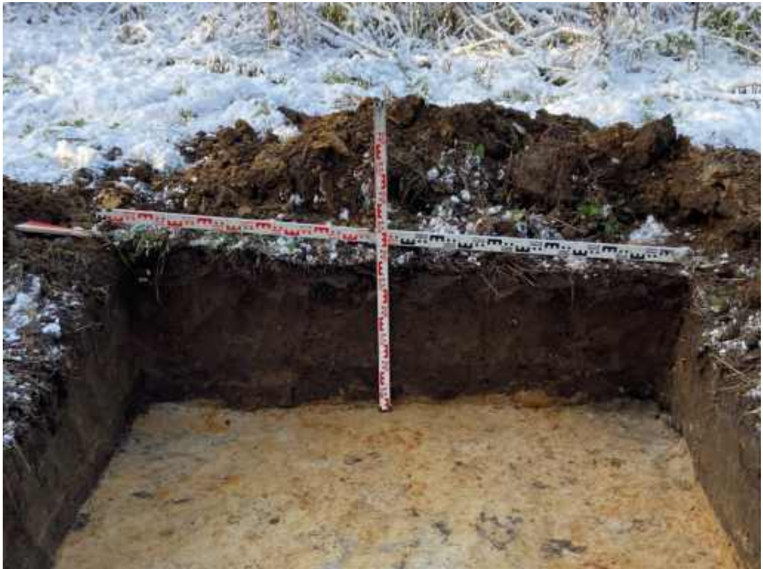
Рис. 51. Санкт-Петербург, земельный участок по объекту: «Проектирование строительства автомобильной дороги № 2 на участке от автомобильной дороги № 1 до кругового движения продолжения проспекта Маршала Блюхера». Шурф №1. Западная стенка. Вид с востока.
