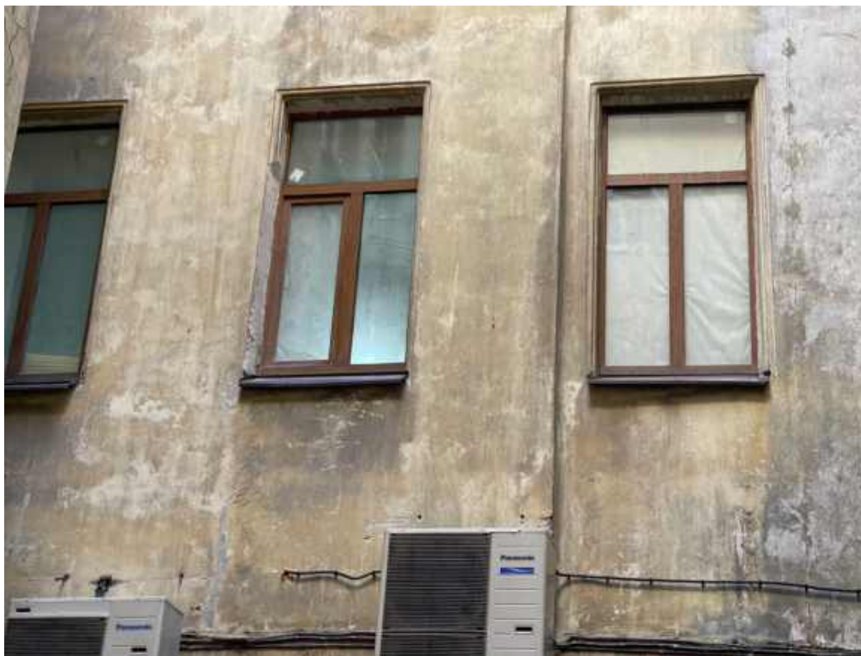
6. Оконные заполнения проемов помещения 41-Н со стороны дворового фасада в уровне 2 этажа.
