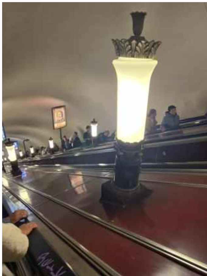
Фото м.1. Литые светильники в наклонной эскалаторной шахте.
