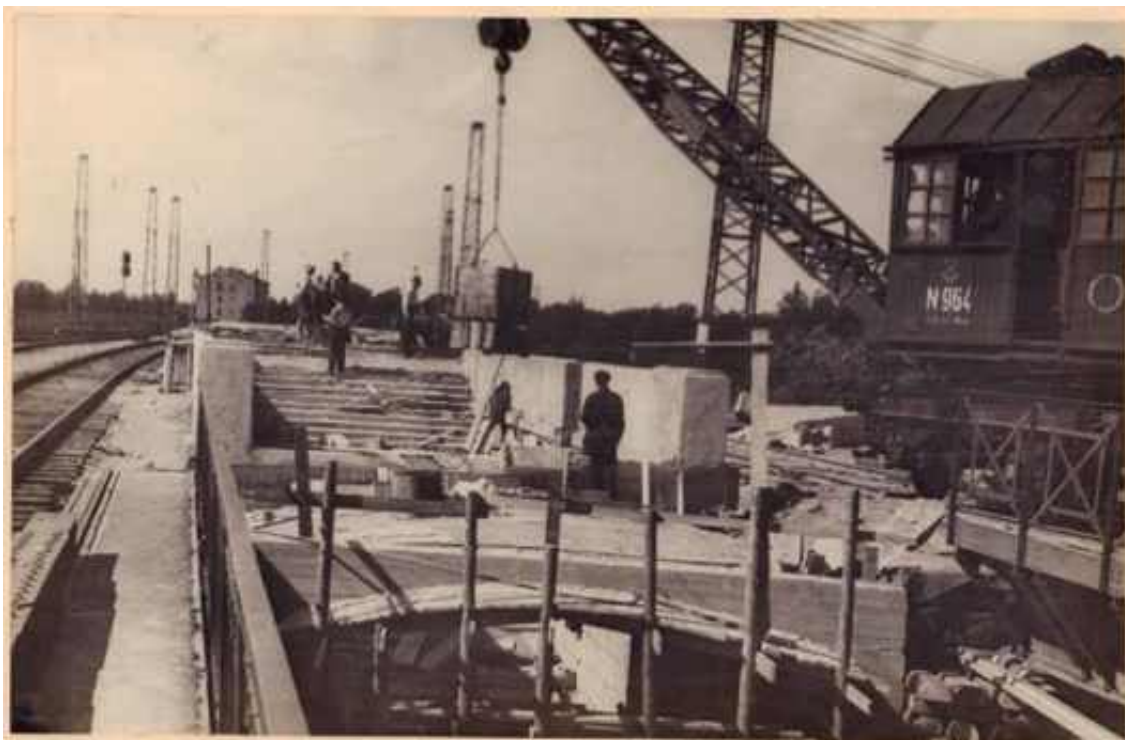
27. Станция Ланская. Строительство высокой пассажирской платформы №1 перед запуском движения электропоездов на участке Ленинград-Зеленогорск в 1951 году. // URL: https://terijoki.spb.ru/%2F/photos/picture.php?/105351/category/2082 (дата обращения: 10.02.2026).
