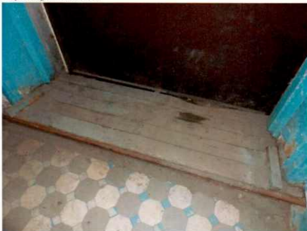
14. Порог парадного входа
