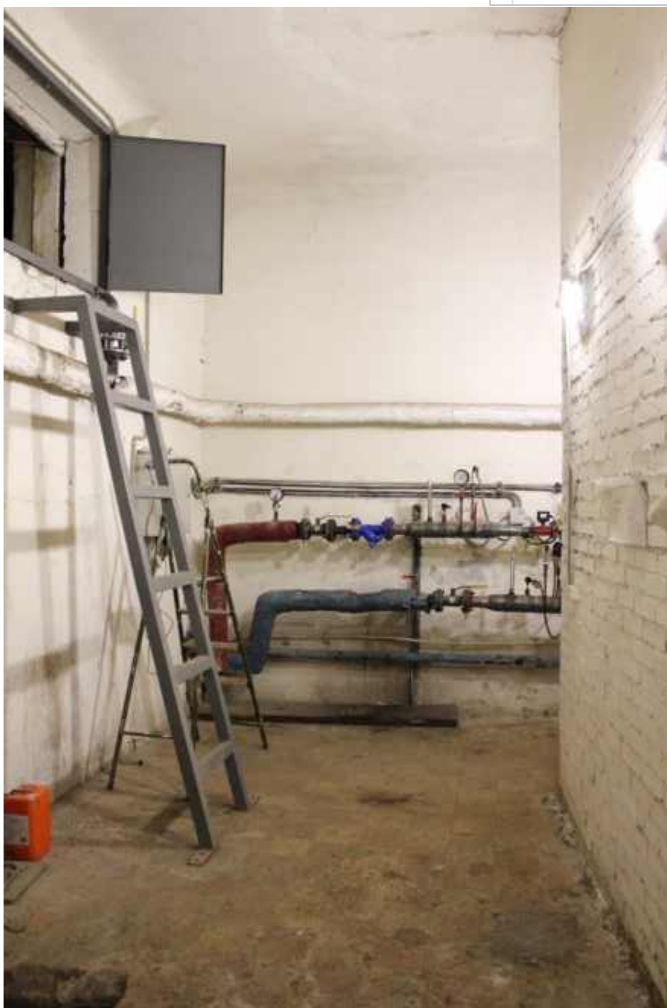
54. Объект культурного наследия регионального значения «Вокзал железнодорожной станции Ланская». 1 этаж, пом. 1-Н(14), общий вид. Помещение, расположенное в железнодорожной насыпи. Дата фотофиксации: 23 апреля 2026 года.
