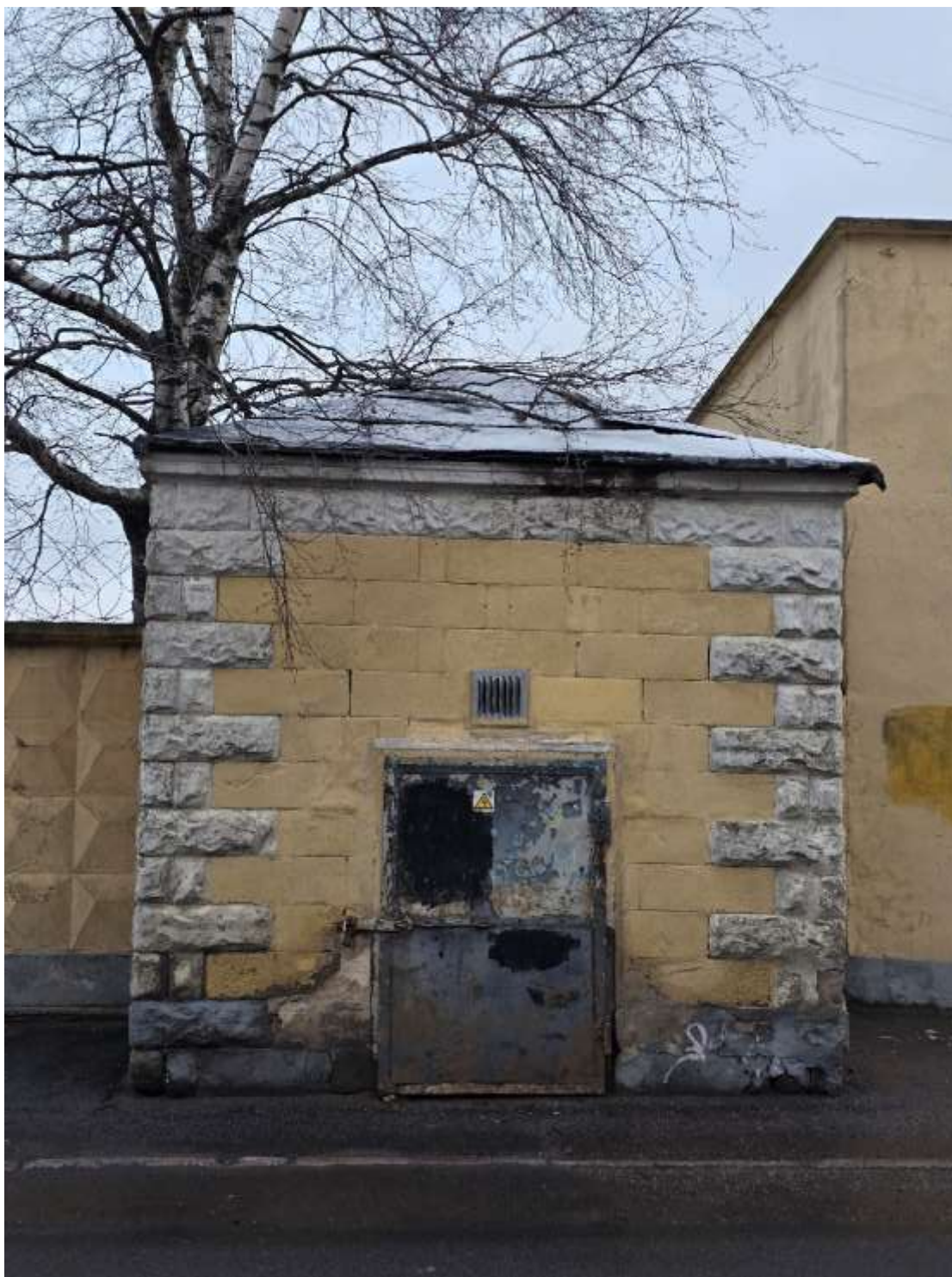
Фото 6. Выявленный объект культурного наследия «Комплекс зданий электромеханической фирмы «Бодо-Эгесторф» (контора, электростанция)», по адресу: Санкт-Петербург, Петровская коса, 3/6. Лицевой фасад «электростанции» (трансформаторной будки).
