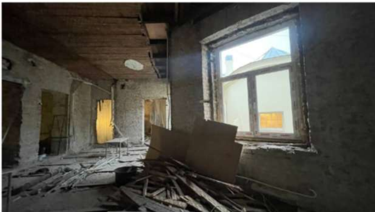
Илл. 32. Объект культурного наследия регионального значения «Особняк Л.Н. Симонова (Столыпиных)», расположенный по адресу: Санкт-Петербург, Гагаринская ул., 5, лит. А. Общий вид помещения в осях Б-В/4-5 с демонтированными перегородками и отделочными слоями.
