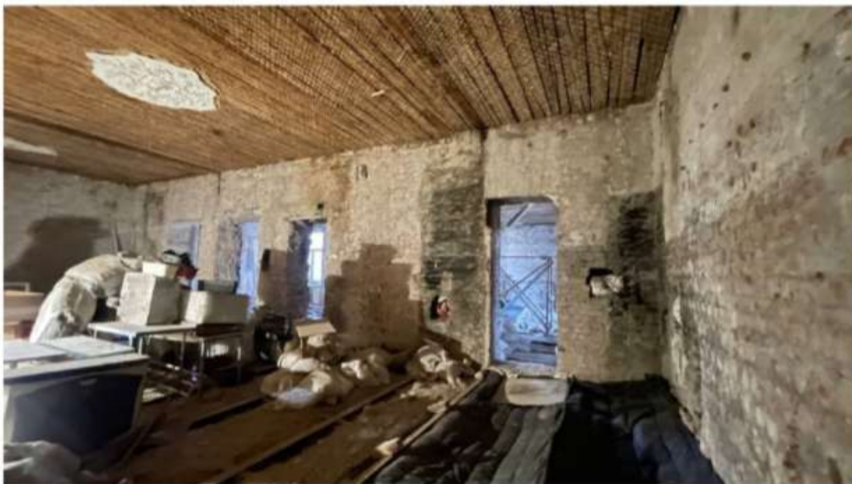
Илл. 30. Объект культурного наследия регионального значения «Особняк Л.Н. Симонова (Столыпиных)», расположенный по адресу: Санкт-Петербург, Гагаринская ул., 5, лит. А. Общий вид помещения в осях 3-5/А-Б с демонтированными перегородками и отделочными слоями.
