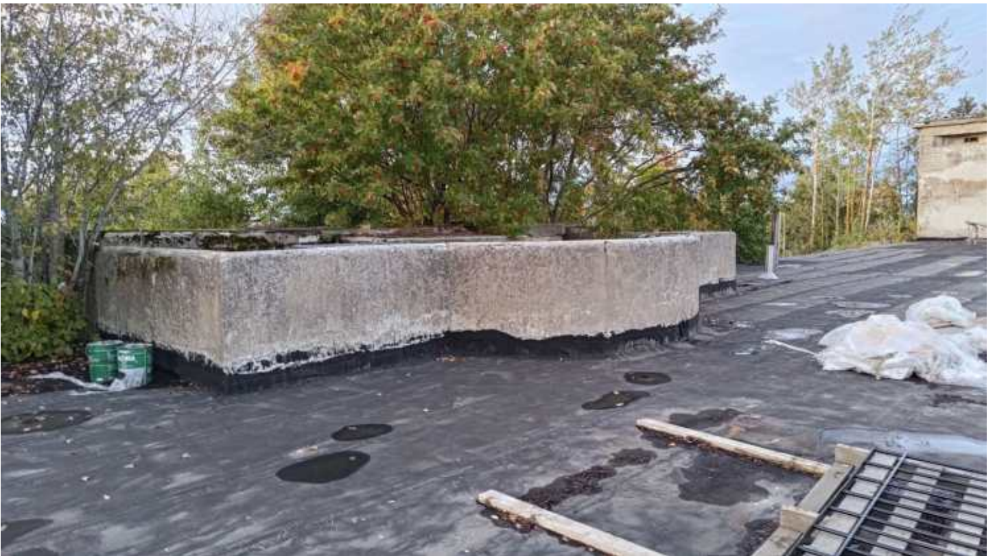
Фото 8. Крыша солдатских казарм. Фрагмент. Дата фотофиксации: 10.10.24
