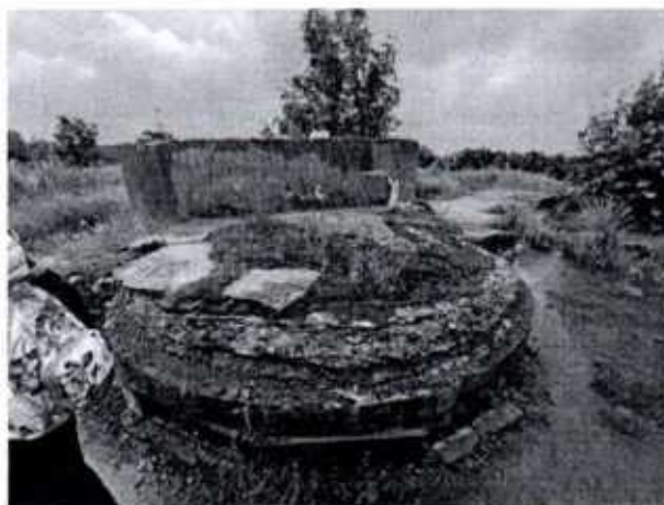
10. Дальномерный пост с галереей. Наблюдаются деструкции бетона.
