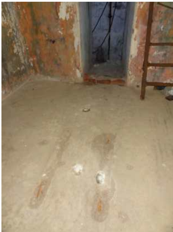
Фото 325. Фрагменты конструкций прожекторной шахты в бетонном полу помещения 18 правого фланга. Дата фотофиксации: 10.10.24
