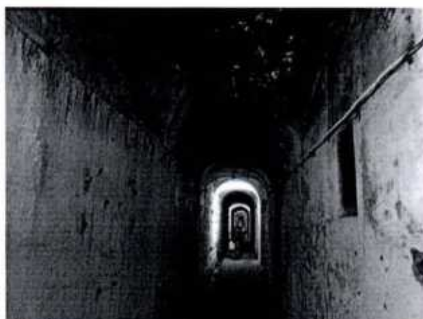
14. Подбрустверная галерея. Наблюдаются деструкции отделочных слоев.
