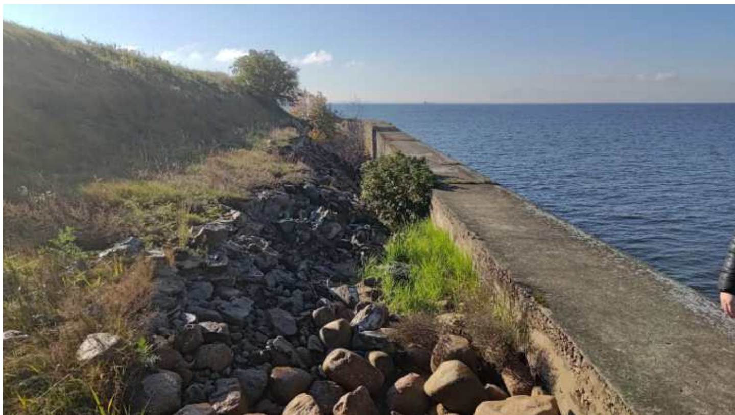
Фото 130. Конструкции основания форта – булыжная засыпка с бетонным ростверком в завершении и свайным основанием под подпорной стенкой. Правый фланг. Фрагмент. Дата фотофиксации: 10.10.24
