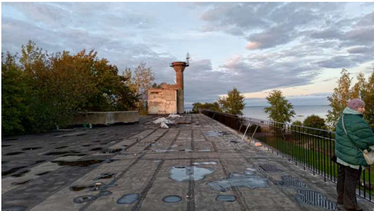
Фото 6. Крыша солдатских казарм. Фрагмент. Дата фотофиксации: 10.10.24
