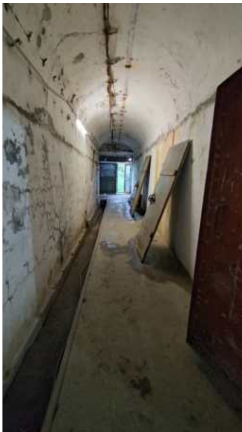
Фото 214. Коридор, соединяющий Главный калибр и опытные сооружения. Свод – коробовый. Фрагмент. Дата фотофиксации: 06.10.24
