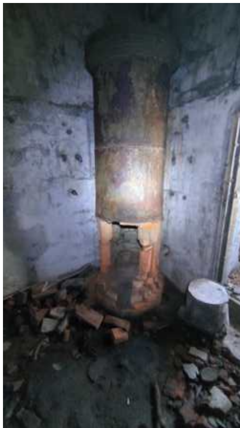
Фото 75. Интерьер помещения котельной в уровне крыши. Офицерские казармы. Фрагмент. Дата фотофиксации: 10.10.24
