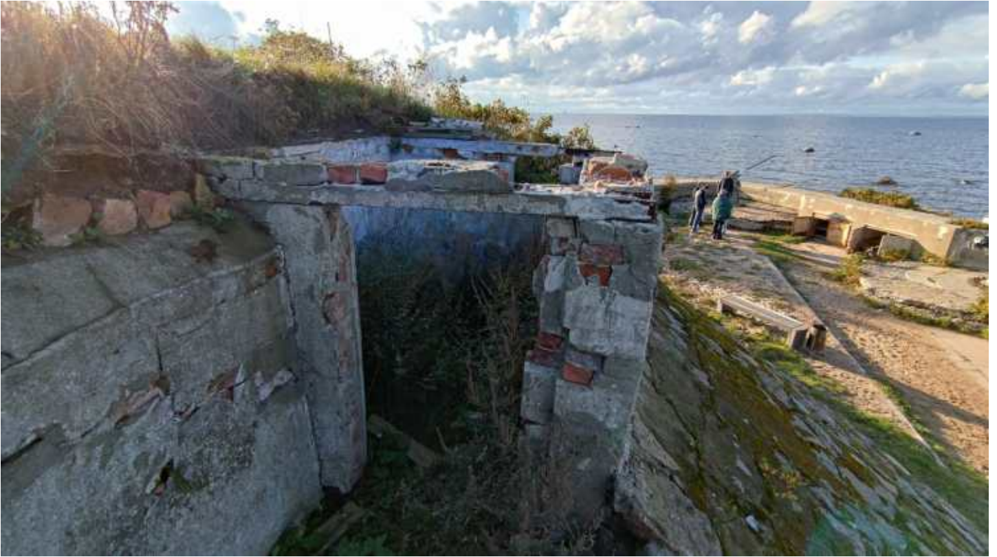
Фото 119. Руинированный дот правого фланга. Общий вид. Дата фотофиксации: 06.10.24
