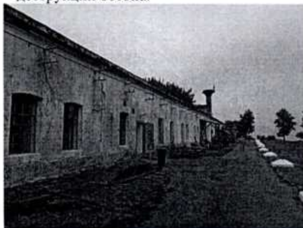
6. Солдатская казарма. Наблюдаются деструкции бетона.
