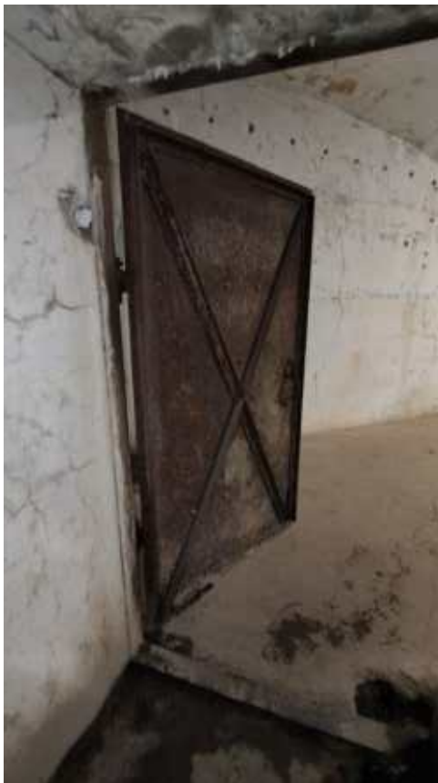
Фото 255. Металлическая прямоугольная одностворчатая дверь во входной галерее Левого Фланга. Общий вид. Дата фотофиксации: 06.10.24
