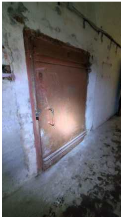
Фото 217. Одностворчатая прямоугольная металлическая дверь, соединяющая коридор и вспомогательные помещения. Общий вид. Дата фотофиксации: 06.10.24
