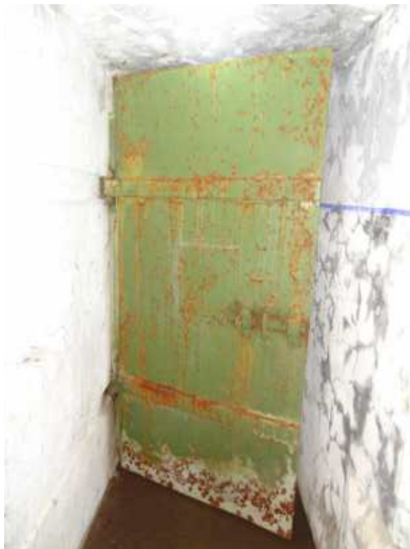
Фото 168. Металлическая одностворчатая дверь между галереей и вспомогательным помещением правого фланга. Дата фотофиксации: 06.10.24
