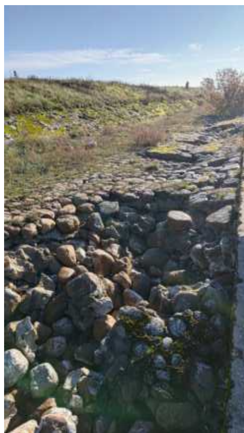
Фото 134. Конструкции основания форта – булыжная засыпка с бетонным ростверком в завершении и свайным основанием под подпорной стенкой. Правый фланг. Фрагмент. Дата фотофиксации: 10.10.24
