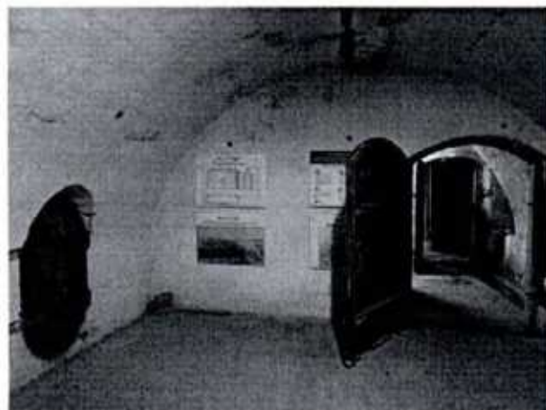
25. Дверное заполнение каземата. Наблюдаются коррозированные участки.
