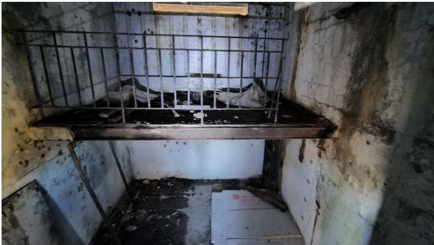
Фото 77. Интерьер помещения котельной в уровне крыши. Офицерские казармы. Фрагмент. Дата фотофиксации: 10.10.24
