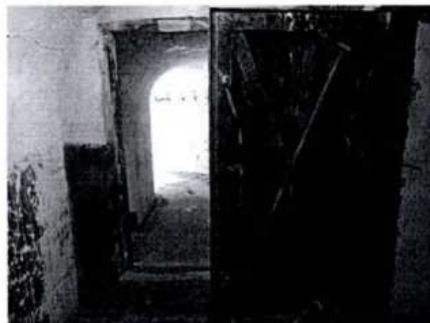
26. Дверное заполнение траверса. Наблюдаются коррозированные участки.
