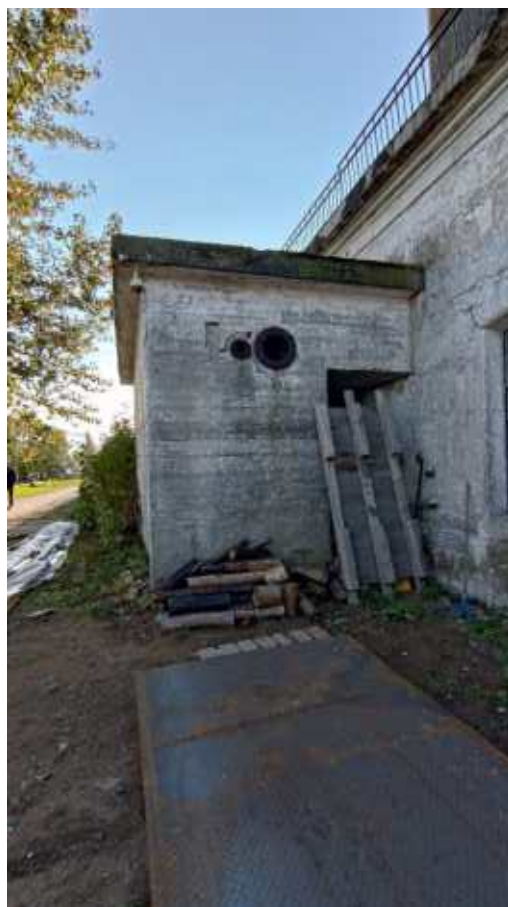
Фото 12. Технические отверстия, восточный фасад солдатских казарм. Дата фотофиксации: 10.10.24
