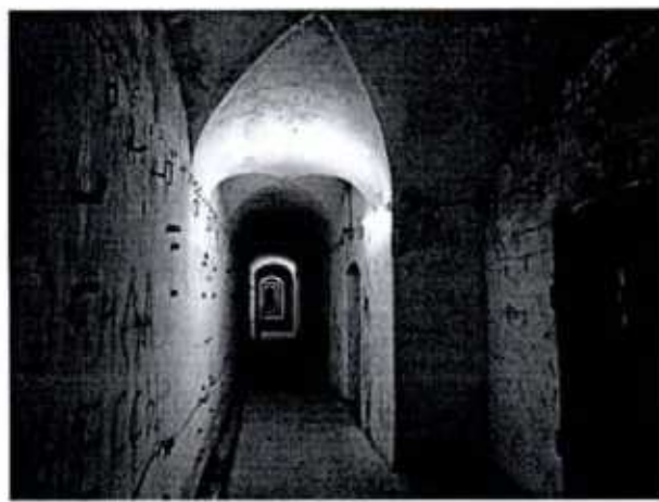
24. Коридор-галерея. Наблюдаются разрушения отделочных слоев.
