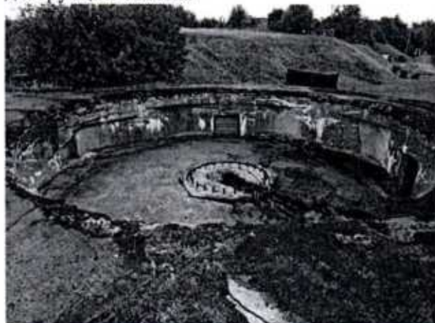
5. Открытая оружейная позиция. Наблюдаются деструкции бетона.
