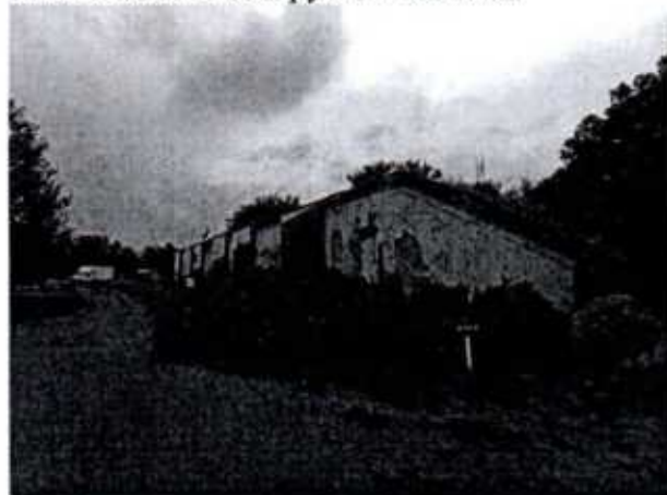
7. Офицерская казарма. Наблюдаются деструкции бетона.
