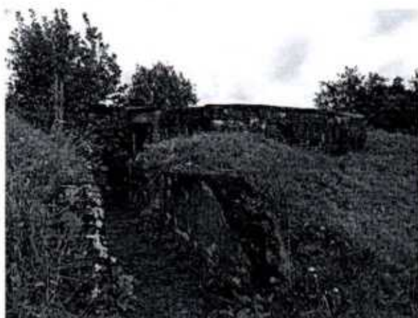
11. Орудийная позиция. Наблюдаются деструкции бетона.
