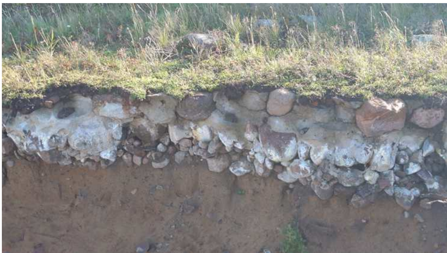
Фото 132. Конструкции основания форта – булыжная засыпка с бетонным ростверком в завершении и свайным основанием под подпорной стенкой. Правый фланг. Фрагмент. Дата фотофиксации: 10.10.24
