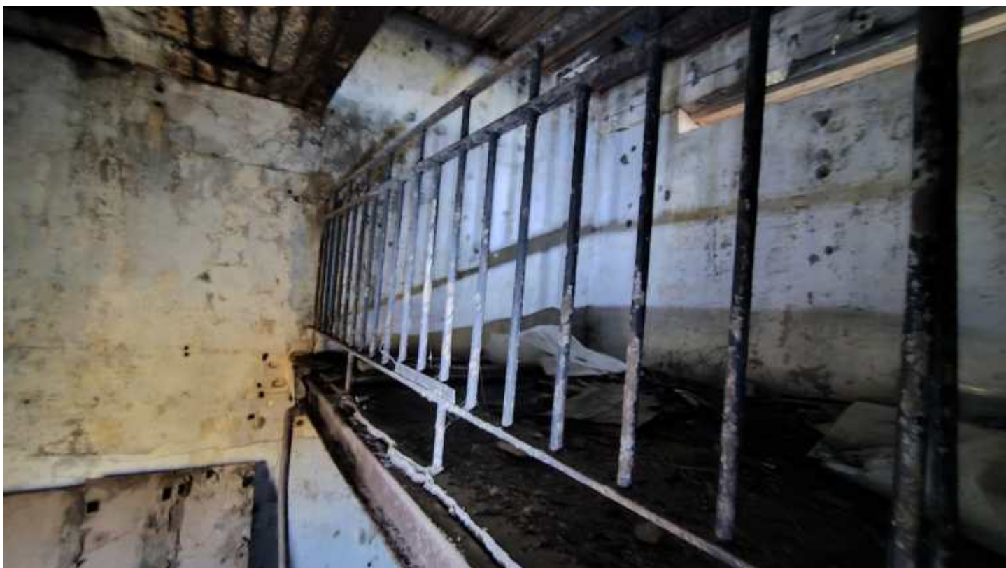
Фото 78. Интерьер помещения котельной в уровне крыши. Офицерские казармы. Фрагмент. Дата фотофиксации: 10.10.24
