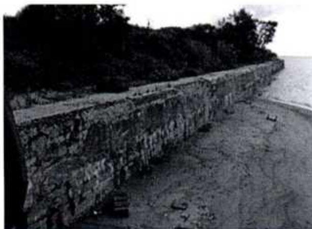
28. Подпорная стенка. Наблюдаются деструкции бетона.
