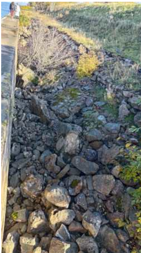
Фото 131. Конструкции основания форта – булыжная засыпка с бетонным ростверком в завершении и свайным основанием под подпорной стенкой. Правый фланг. Фрагмент. Дата фотофиксации: 10.10.24
