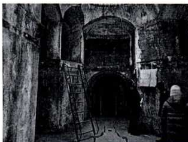
18. Бронебашня. Наблюдаются деструкции отделочных слоев.
