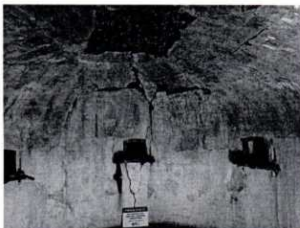
16. Капонир. Наблюдаются повреждения бетона.
