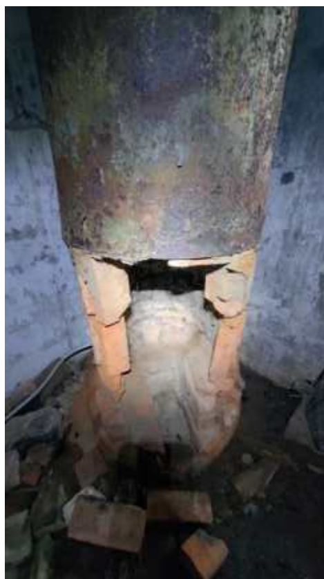
Фото 76. Труба в помещении котельной. Офицерские казармы. Фрагмент. Дата фотофиксации: 10.10.24
