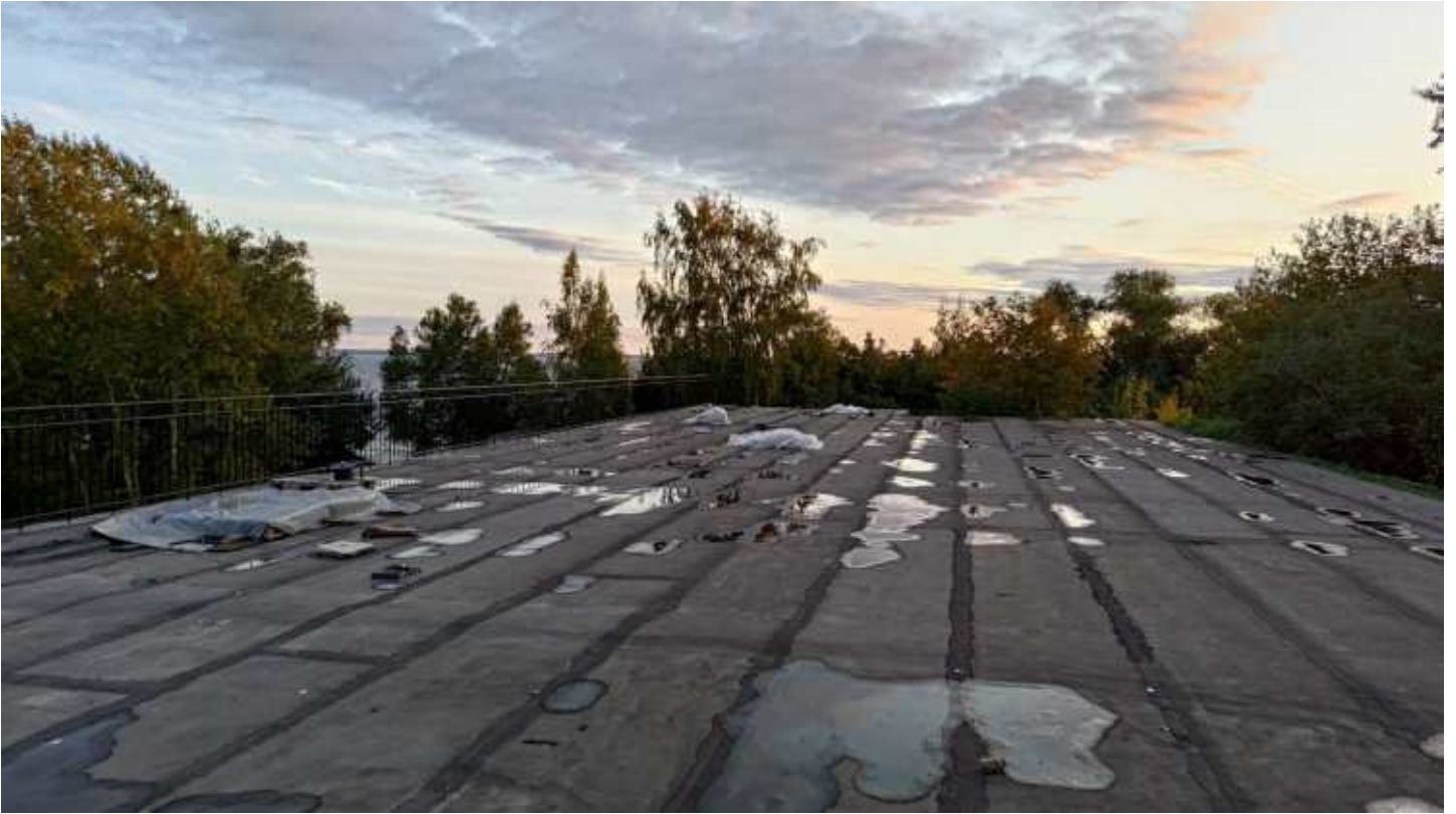
Фото 7. Крыша солдатских казарм. Фрагмент. Дата фотофиксации: 10.10.24
