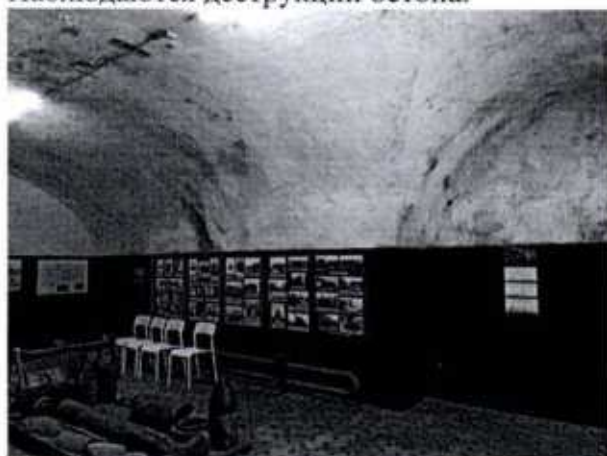
13. Солдатская казарма. Интерьер. Наблюдаются деструкции отделочных слоев.
