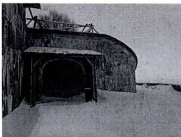
4. Казематированный траверс. Наблюдаются деструкции бетона.
