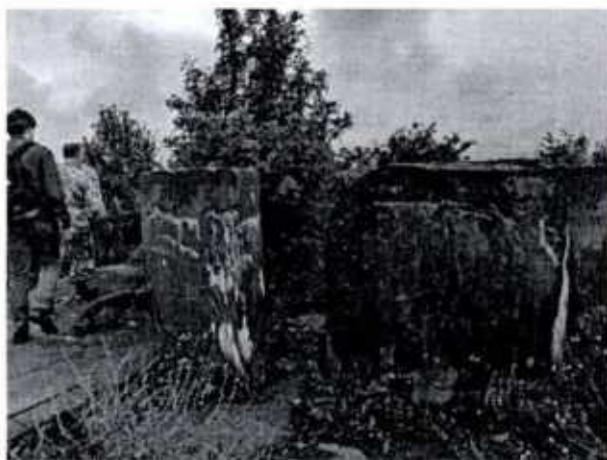
9. Орудийная позиция. Наблюдаются деструкции бетона.
