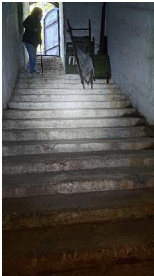
Фото 291. Бетонная лестница, ведущая в нижний уровень опытных построек. Общий вид. Дата фотофиксации: 10.10.24
