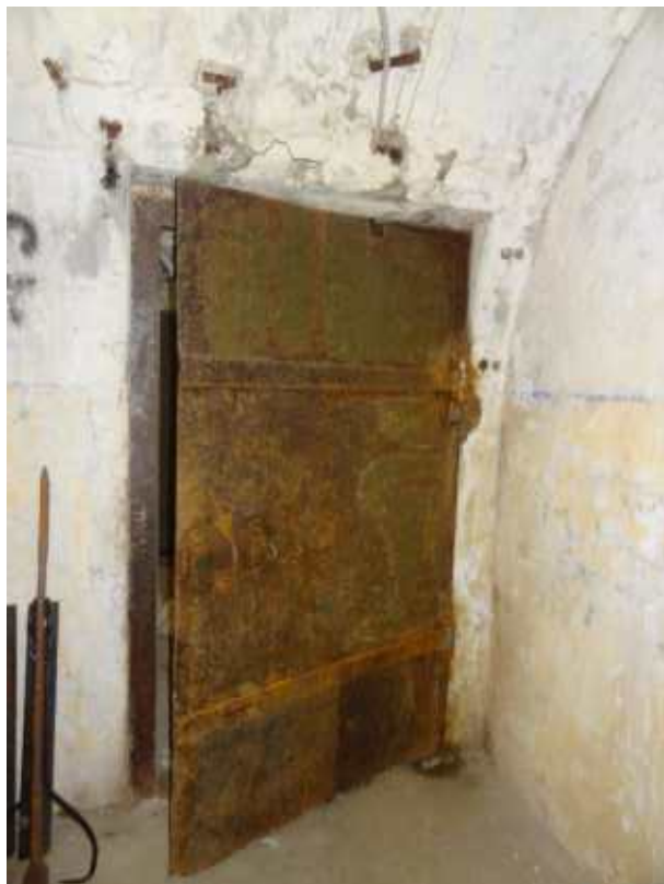
Фото 319. Металлическая, прямоугольная дверь между помещениями 20 и 18 правого фланга. Общий вид. Дата фотофиксации: 10.10.24
