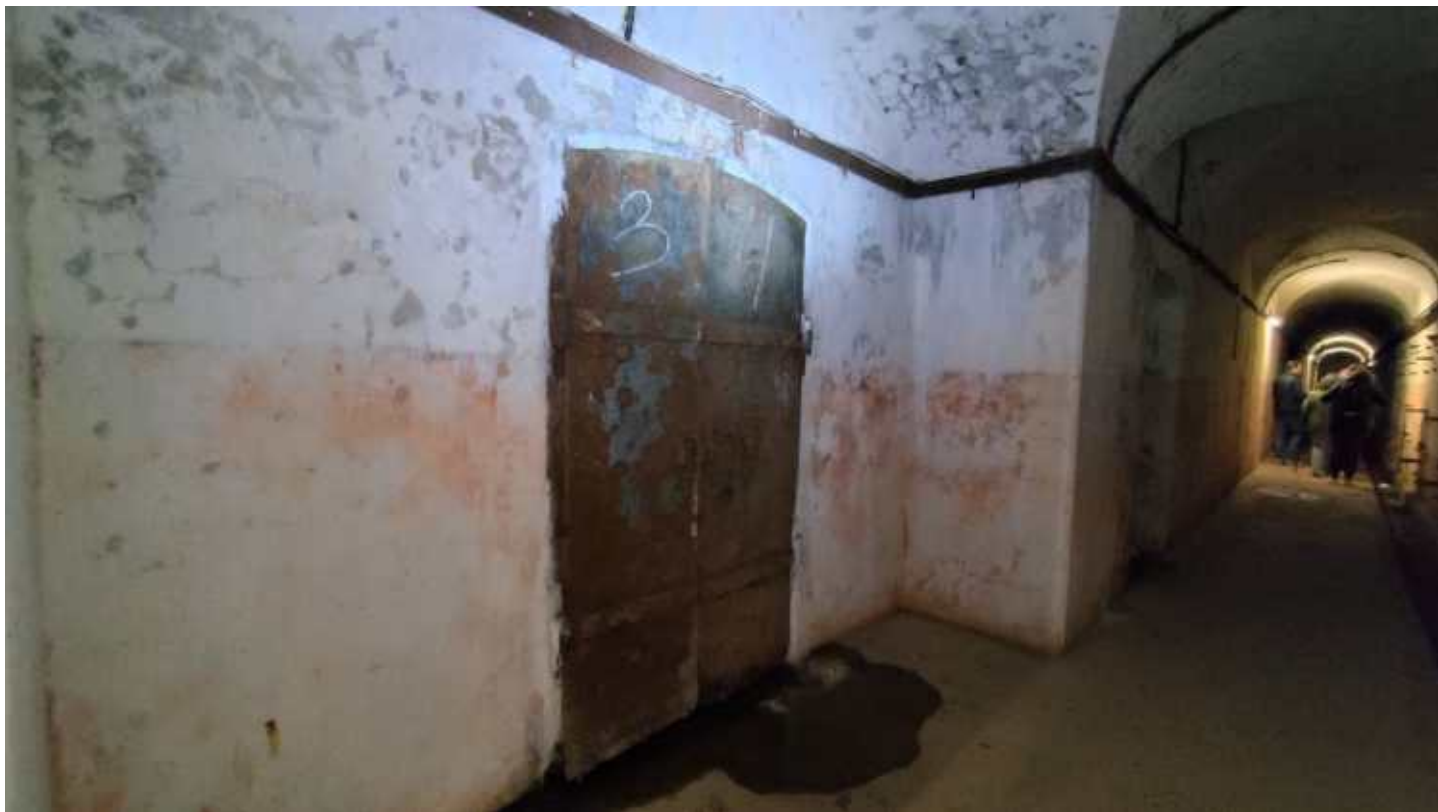
Фото 247. Металлические двустворчатые прямоугольные двери с лучковым завершением в галереи Левого фланга. Общий вид. Дата фотофиксации: 06.10.24
