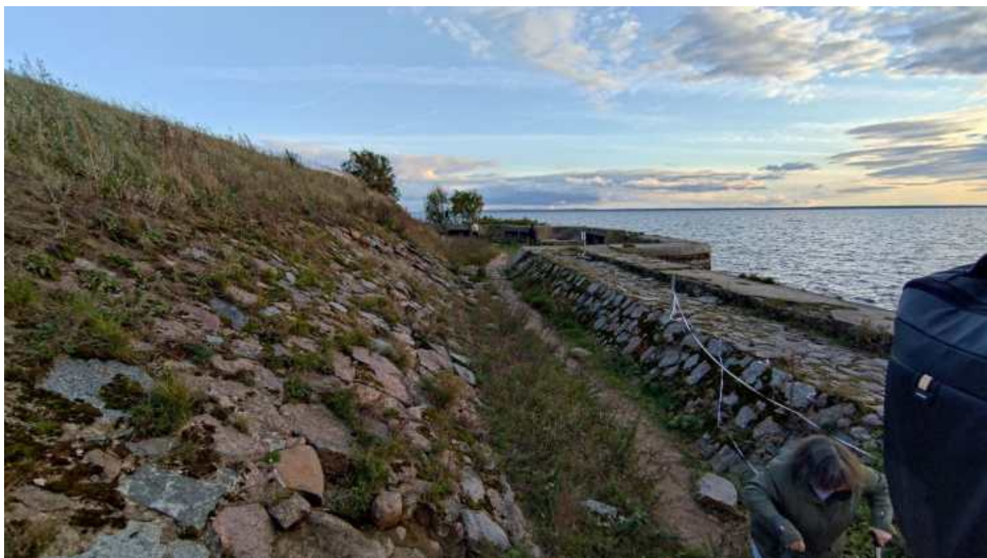
Фото 268. Конструкции основания форта – булыжная засыпка с бетонным ростверком в завершении и свайным основанием под подпорной стенкой. Фрагмент. Дата фотофиксации: 06.10.24
