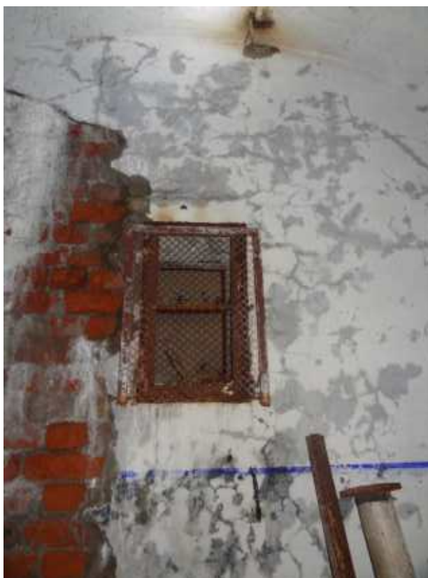
Фото 169. Вентиляционная решетка и ставни между помещениями траверсов правого фланга. Общий вид. Дата фотофиксации: 06.10.24
