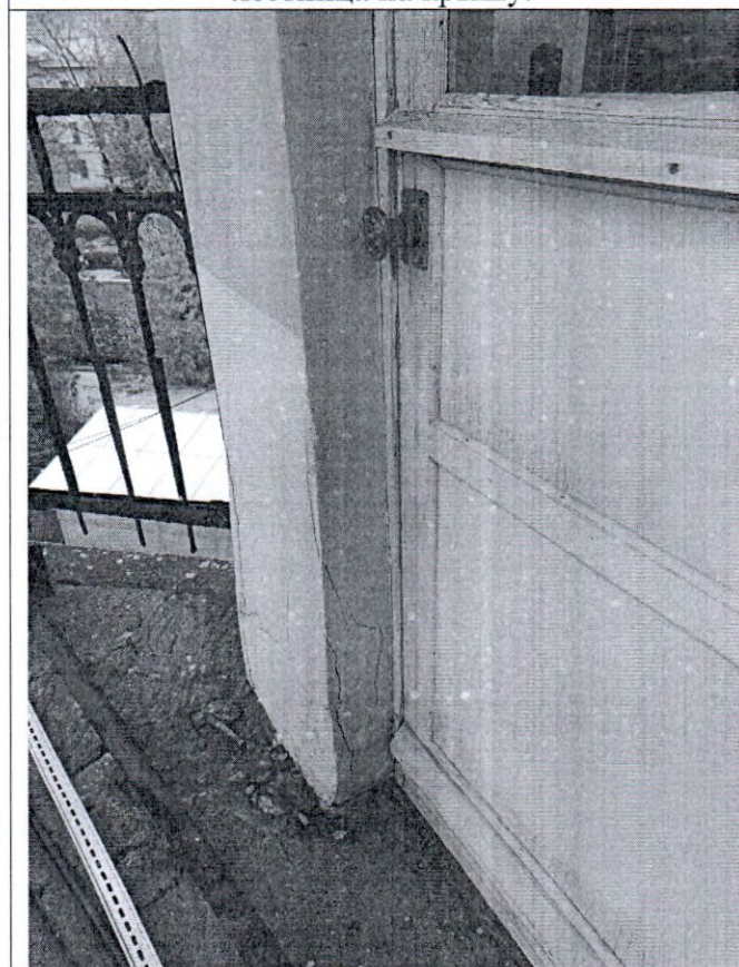
9. Северо-западный фасад. Фрагмент. Дефекты отделки.
