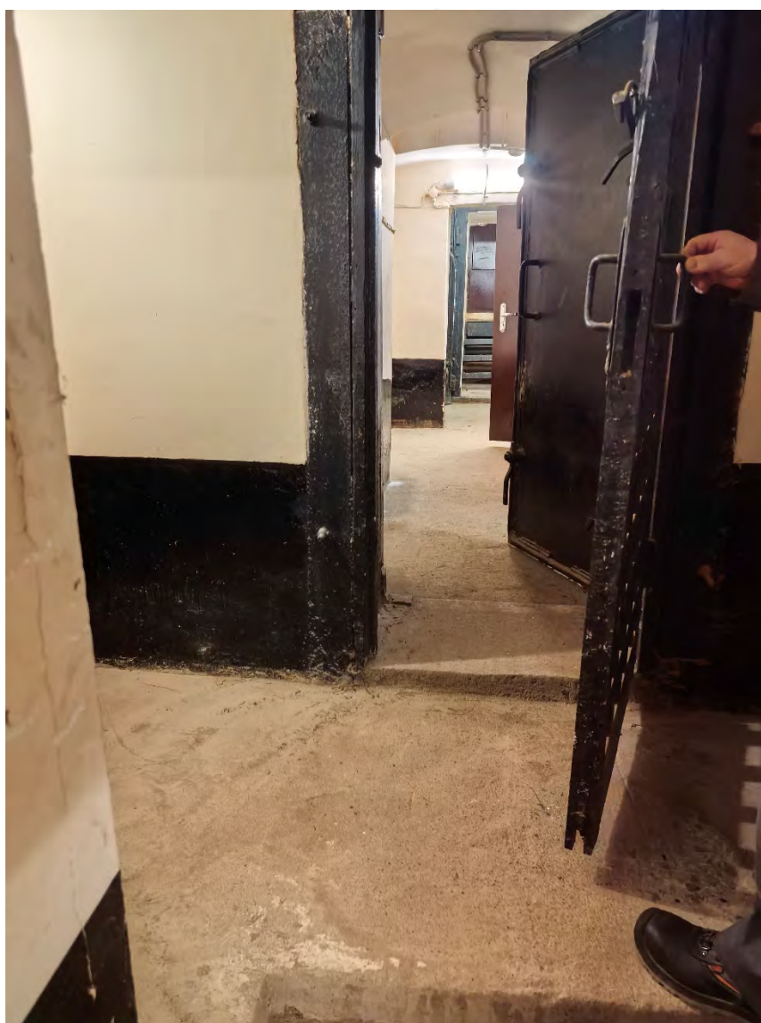
13. Объект культурного наследия федерального значения «Общество кредитное городское Санкт-Петербургское с дворовым флигелем», по адресу: Санкт-Петербург, пл. Островского, д. 7, лит. А (Островского пл., 7). Помещение подвала. Дата съемки: 20.03.2026г.
