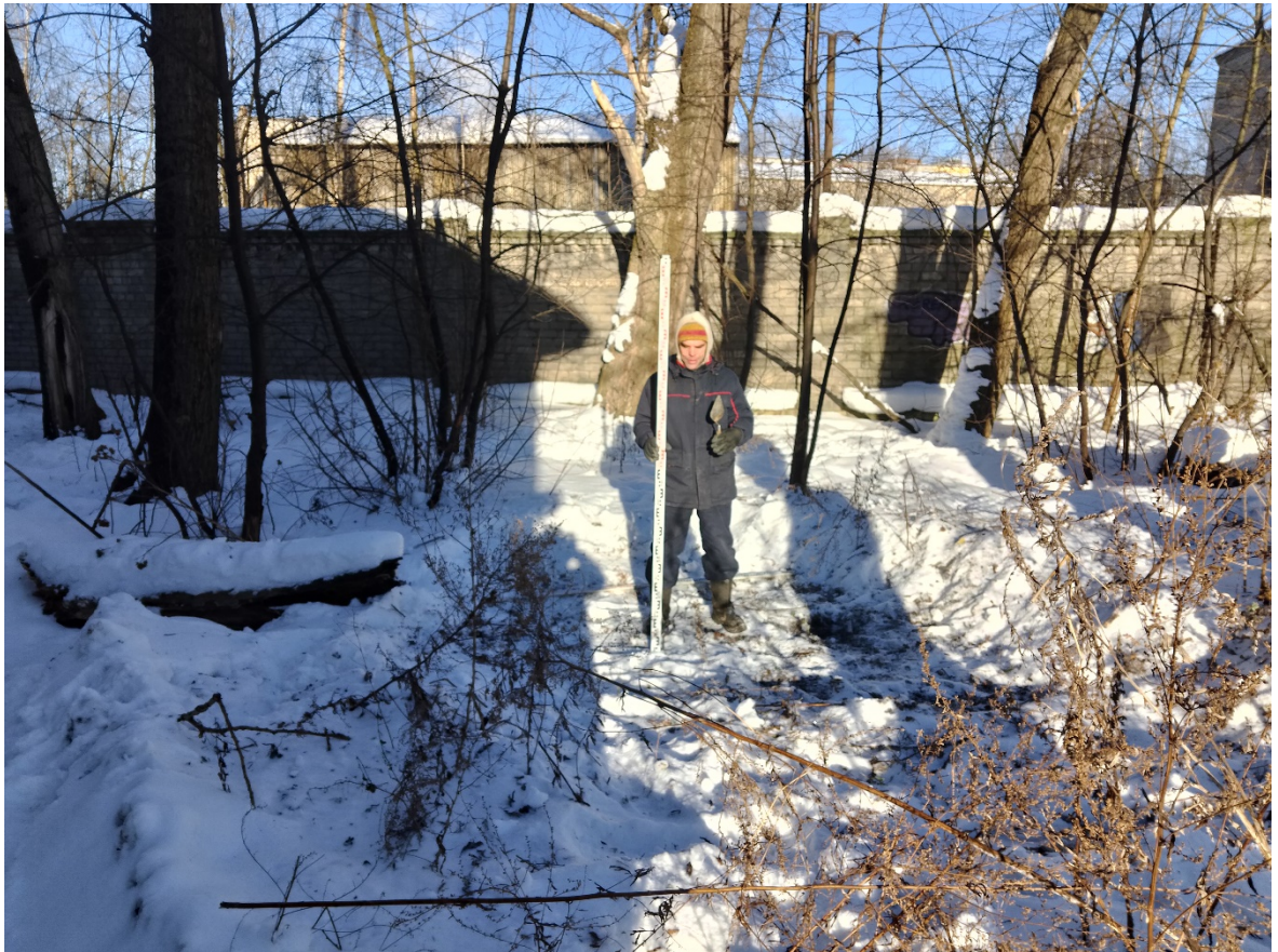
Рис. 30. СПб-2026. Продолжение Б. Смоленского проспекта. Местоположение шурфа 1 до начала работ, вид с юга.
