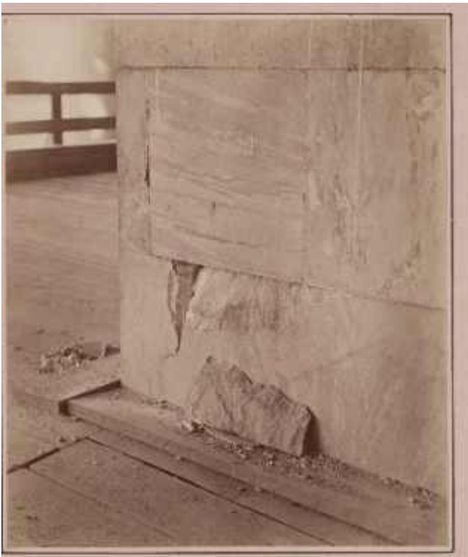
22. Состояние мраморной облицовки. Архив РГИА СПб. Ф 502 Оп. 3 Д. 2 Л. 3. 1873 г.
