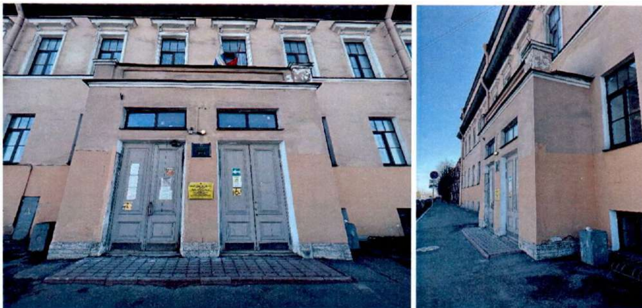
Фото 2, 3. Выступающий объем входного тамбура со стороны лицевой фасад объекта культурного наследия по наб. Обводного канала.
