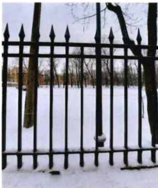
Фото 6: фрагмент объекта культурного наследия (на известняковом цоколе располагается решетка в виде тонких чугунных вертикальных прутьев с наконечниками копий, соединенных горизонтальными тягами). Вид с востока.
