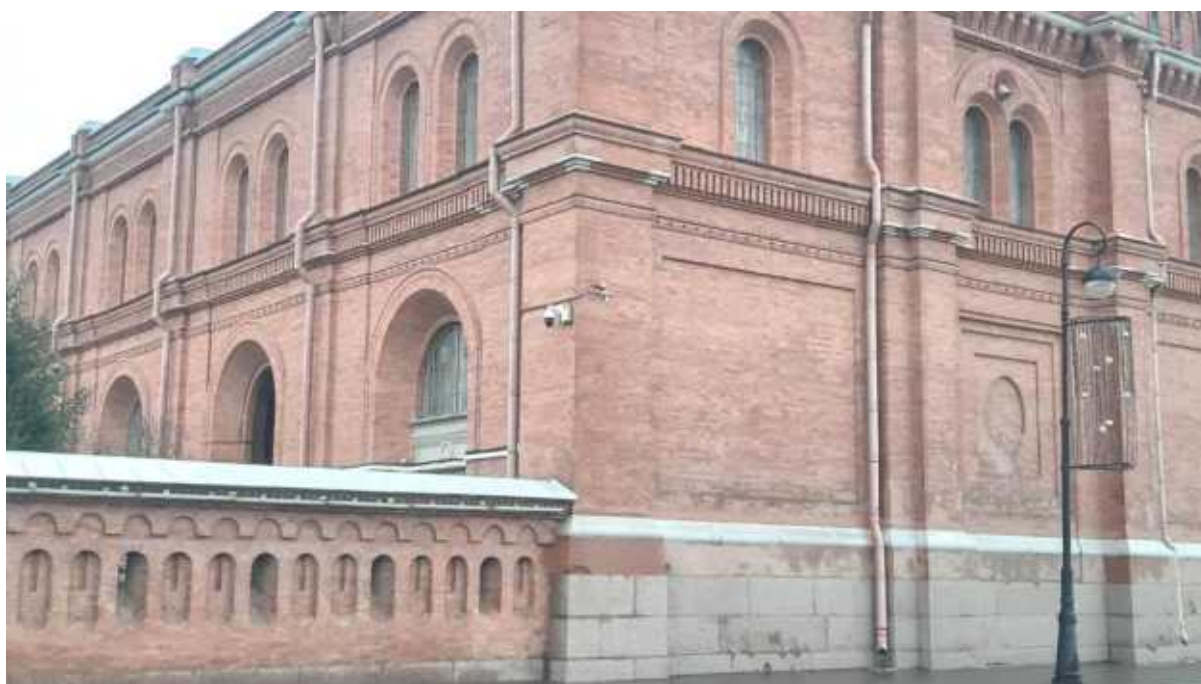
26. «Арсенал (в составе «Кронверк Петропавловской крепости»)). (Александровский парк, д. 7, лит. А). Фрагмент лицевого фасада. Фото мест установки оборудования и прокладки кабельных трасс. Штиглиц М.С. 17.12.2025.
