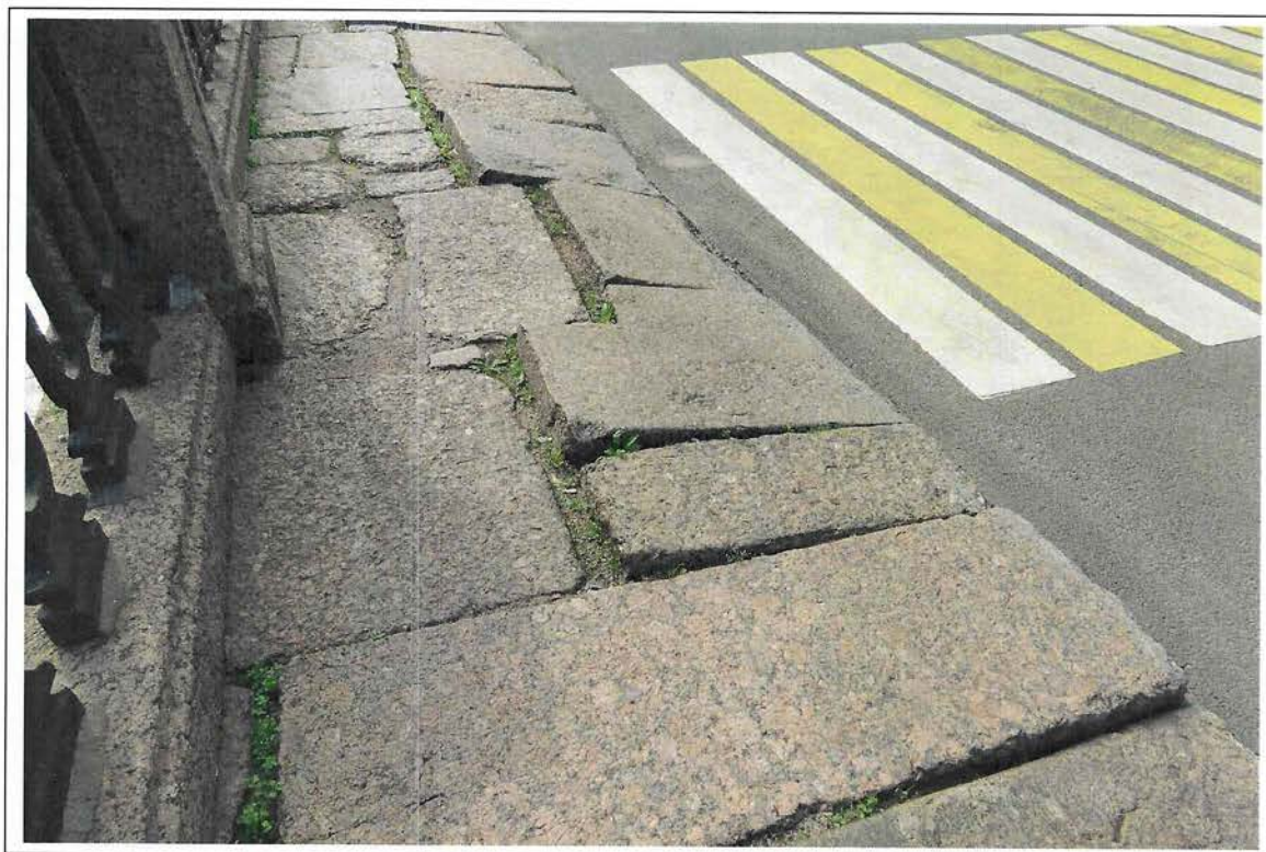
Рис. 11. Расстройство плит мощения тротуара в районе секции перил №2 (у Матвеева моста)
