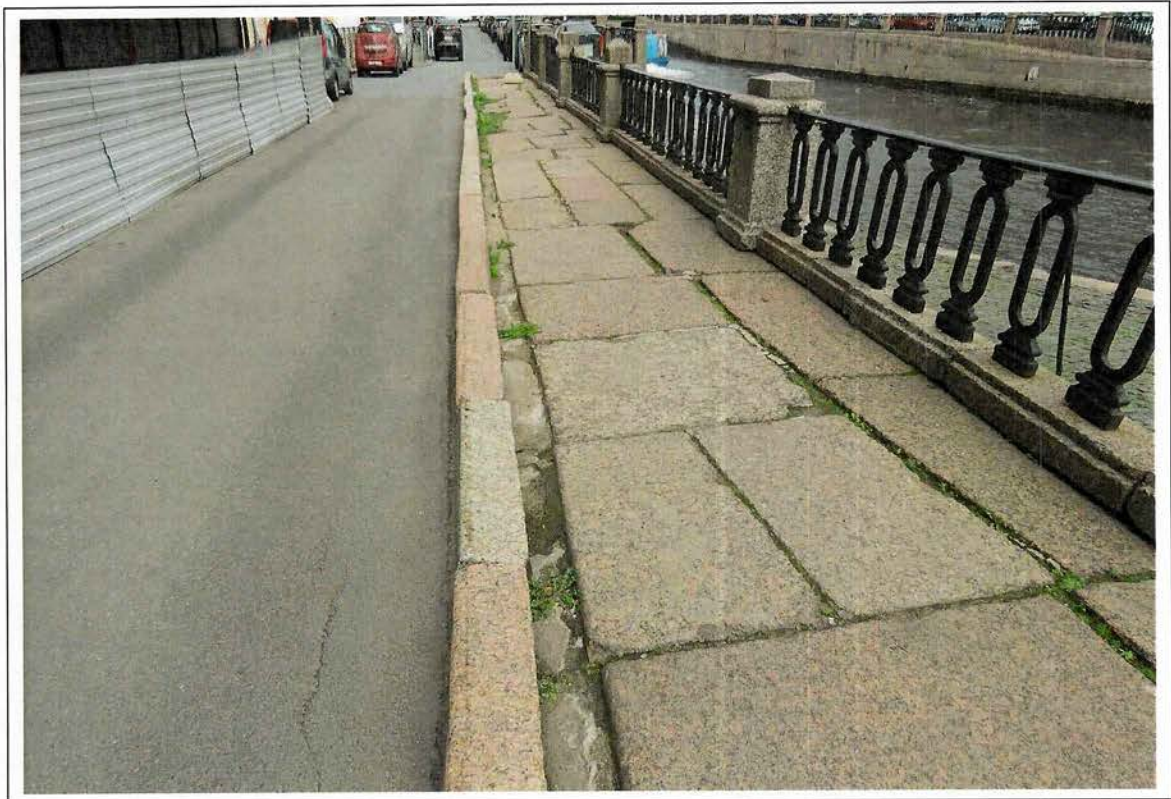
Рис. 32. Тротуар вдоль задней стенки спуска. Расхождение швов между плитами мощения. Расстройство парапетного ограждения проезжей части
