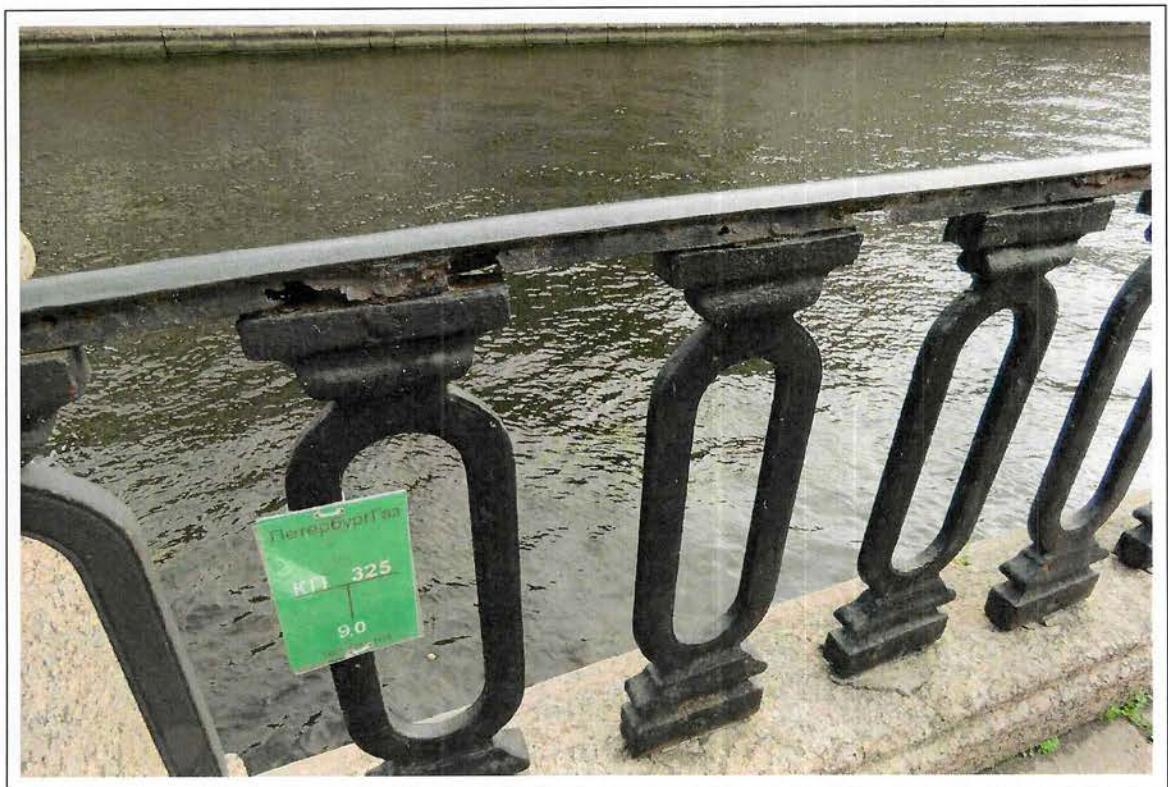
Рис. 13. Сквозная коррозия поручня секции №4
