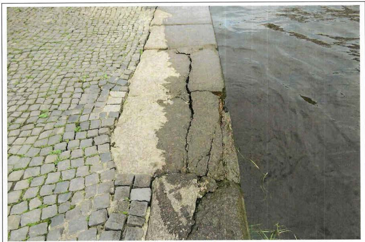
Рис. 30. Повреждение гранитной плиты нижней площадки и смежного карнизного камня с низовой стороны
