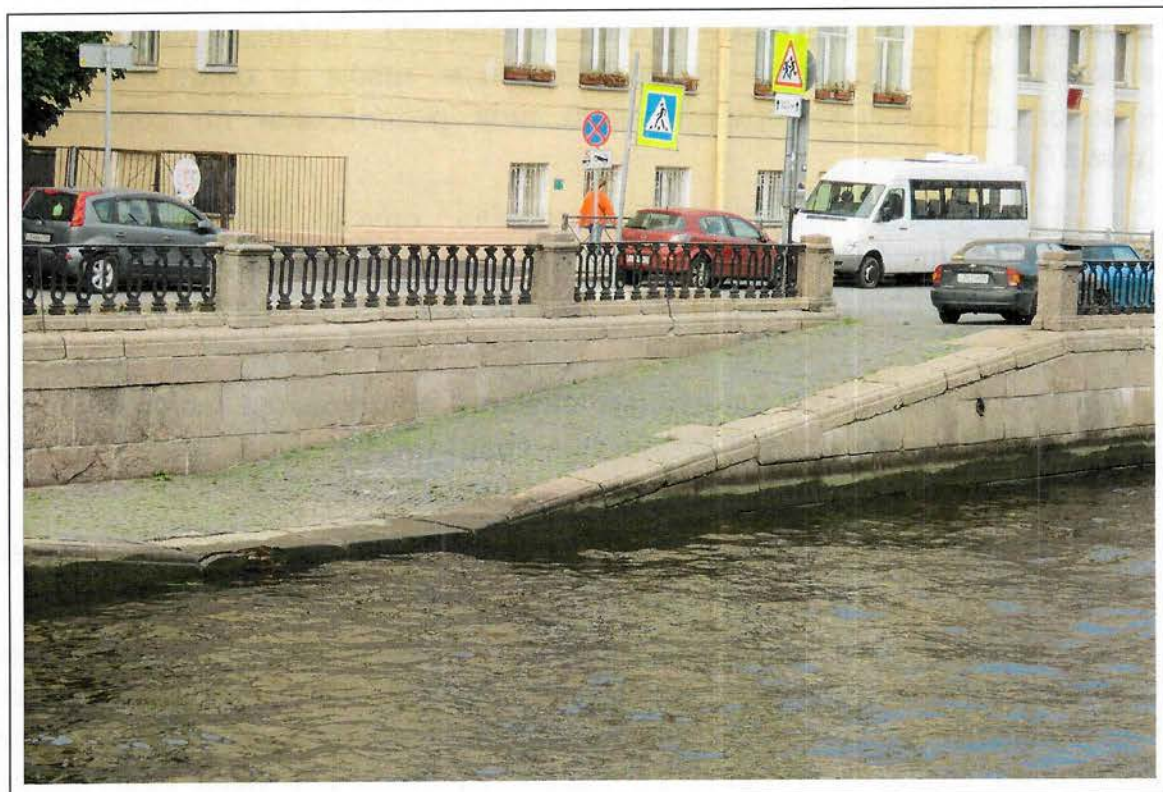
Рис. 26. Граница спуска с верхней стороны не оформлена деформационным швом в облицовке
