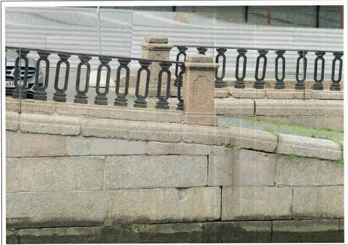
Рис. 22. Наличие камней гранита разного цвета и фактуры в облицовке. Загрязнение облицовки выше уровня воды на участке с низовой стороны спуска
