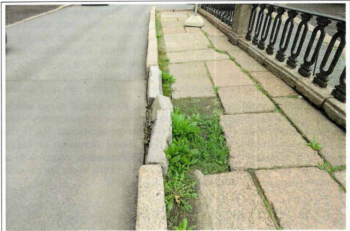
Рис. 33. Отсутствие тротуарных плит. Расстройство парапетного ограждения проезжей части. Скопление грунта вдоль ограждения
