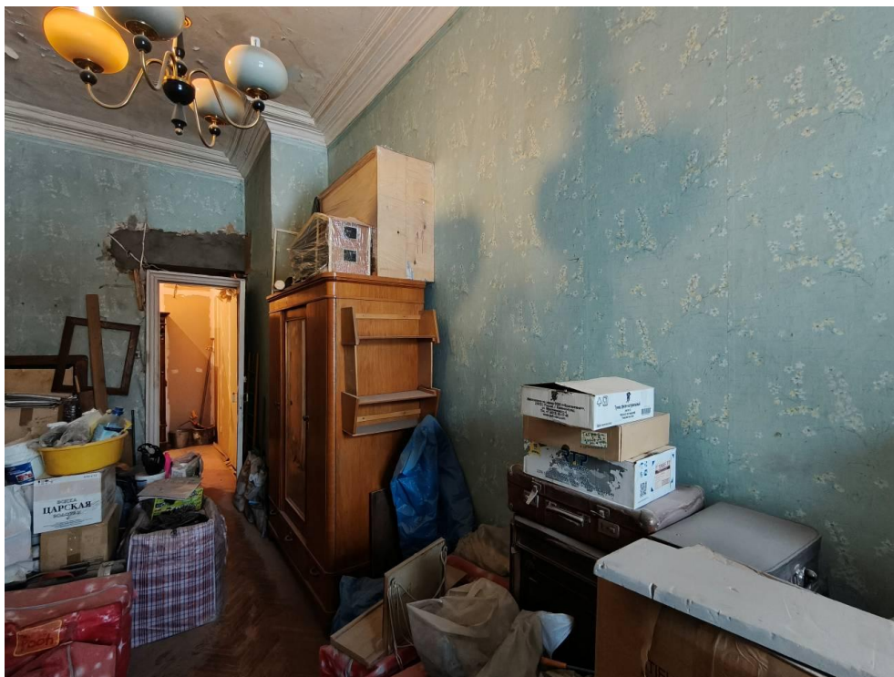
Фото 9. Интерьер квартиры № 28 объекта культурного наследия регионального значения «Дом, где жили: в 1837 г. актриса Асенкова Варвара Николаевна, до 1843 г. издатель Краевский Андрей Александрович (кв. 47), в 1842-1846 гг. революционный демократ, писатель и литературный критик Белинский Виссарион Григорьевич (кв. 55, 48, 47, 43)»
