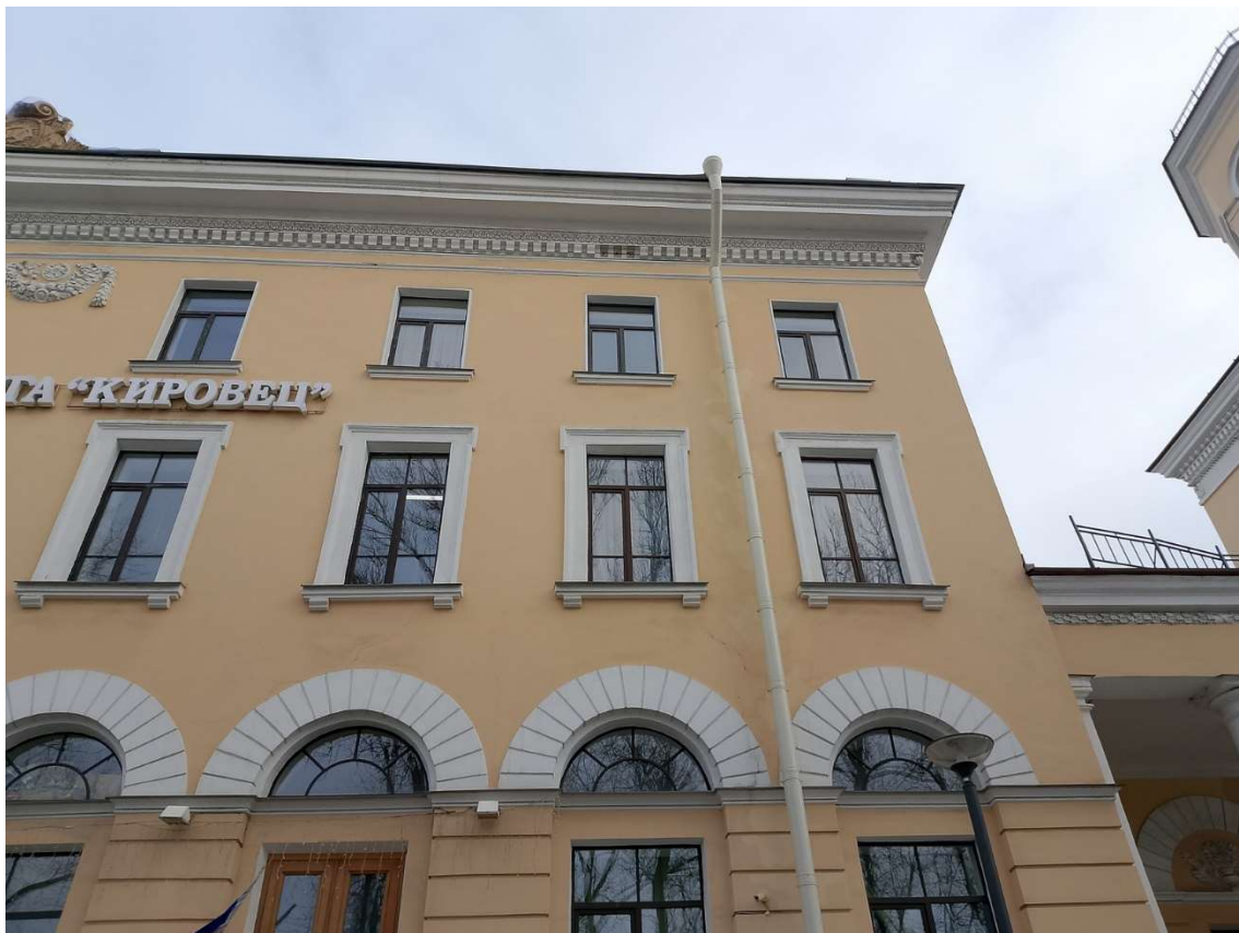
8. Пр. Стачек, 158. Лицевой фасад центрального объёма (фрагмент). Волосяные трещины между проёмами 1 и 2 этажа, загрязнение фасада.
