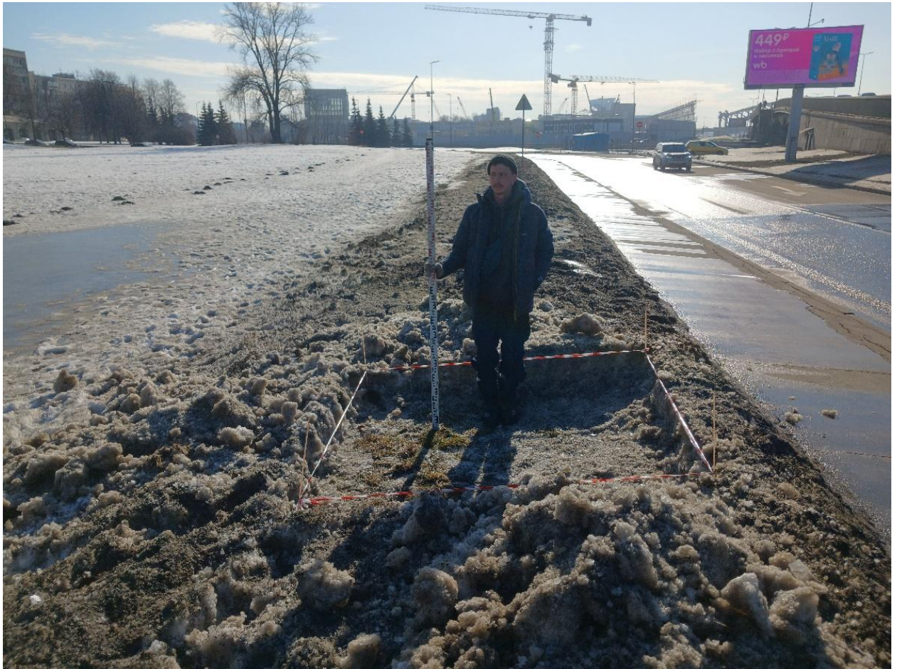
Рис. 13. СПб-2026. Красногвардейский район, «Разработка проектной документации на перекладку силовых кабельных линий внешнего электроснабжения 0,4 кВ КНС у Малоохтинского моста». Шурф 1. Общий вид до начала работ. Вид с севера
