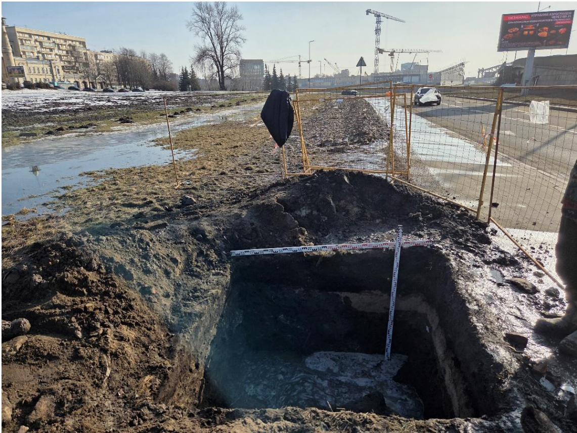
Рис. 20. СПб-2026. Красногвардейский район, «Разработка проектной документации на перекладку силовых кабельных линий внешнего электроснабжения 0,4 кВ КНС у Малоохтинского моста» Шурф 1. Южная стенка. Вид с севера
