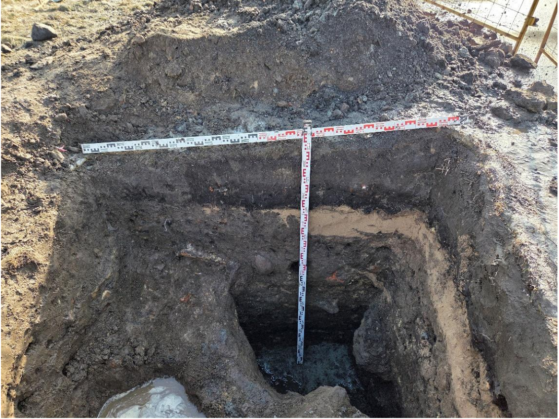
Рис. 18. СПб-2026. Красногвардейский район, «Разработка проектной документации на перекладку силовых кабельных линий внешнего электроснабжения 0,4 кВ КНС у Малоохтинского моста» Шурф 1. Южная стенка. Вид с севера
