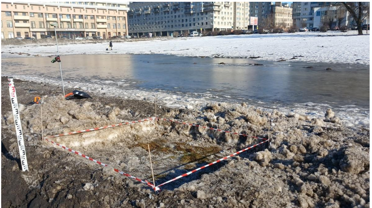
Рис. 14. СПб-2026. Красногвардейский район, «Разработка проектной документации на перекладку силовых кабельных линий внешнего электроснабжения 0,4 кВ КНС у Малоохтинского моста». Шурф 1. Общий вид до начала работ. Вид с юго-запада
