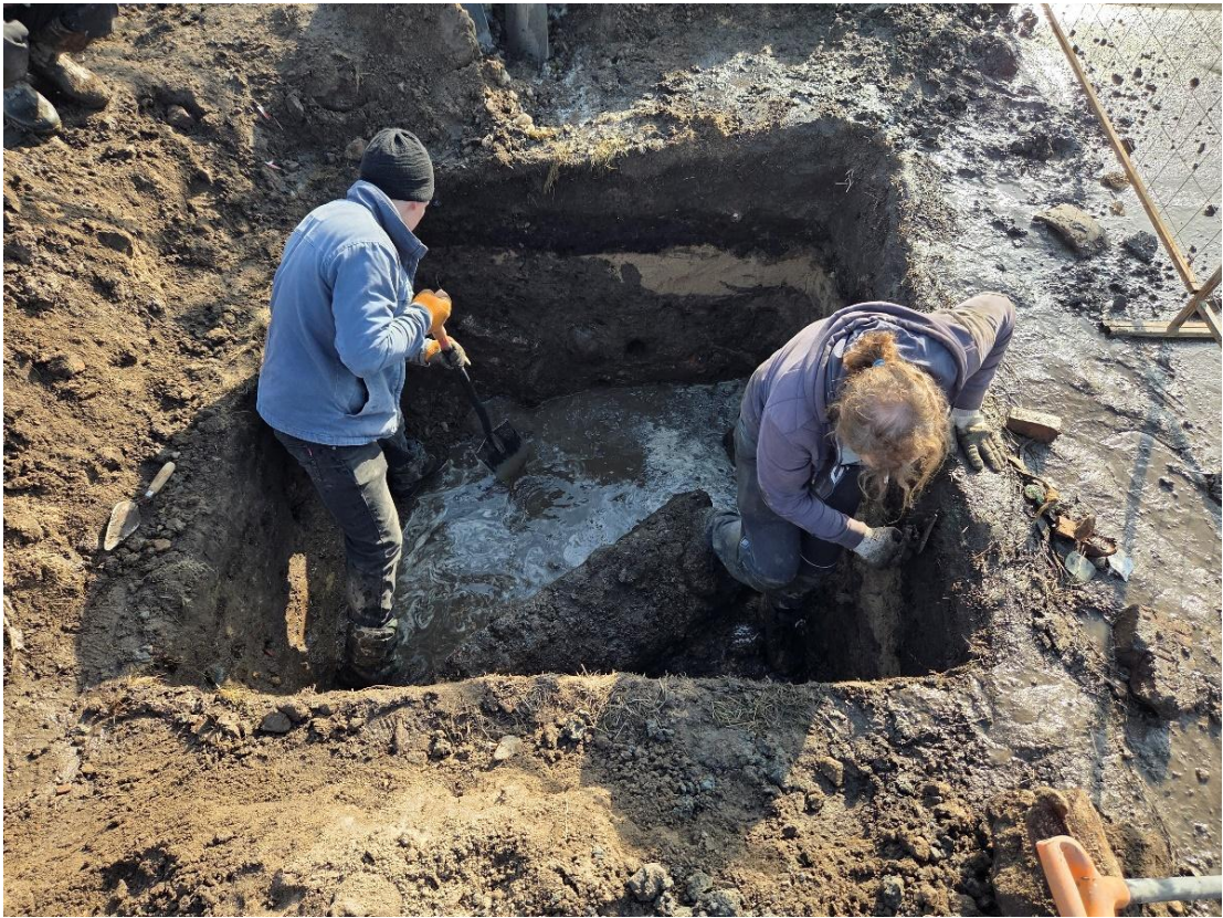
Рис. 19. СПб-2026. Красногвардейский район, «Разработка проектной документации на перекладку силовых кабельных линий внешнего электроснабжения 0,4 кВ КНС у Малоохтинского моста» Шурф 1. Процесс прокопки техногена в стоячих грунтовых водах. Вид с запада
