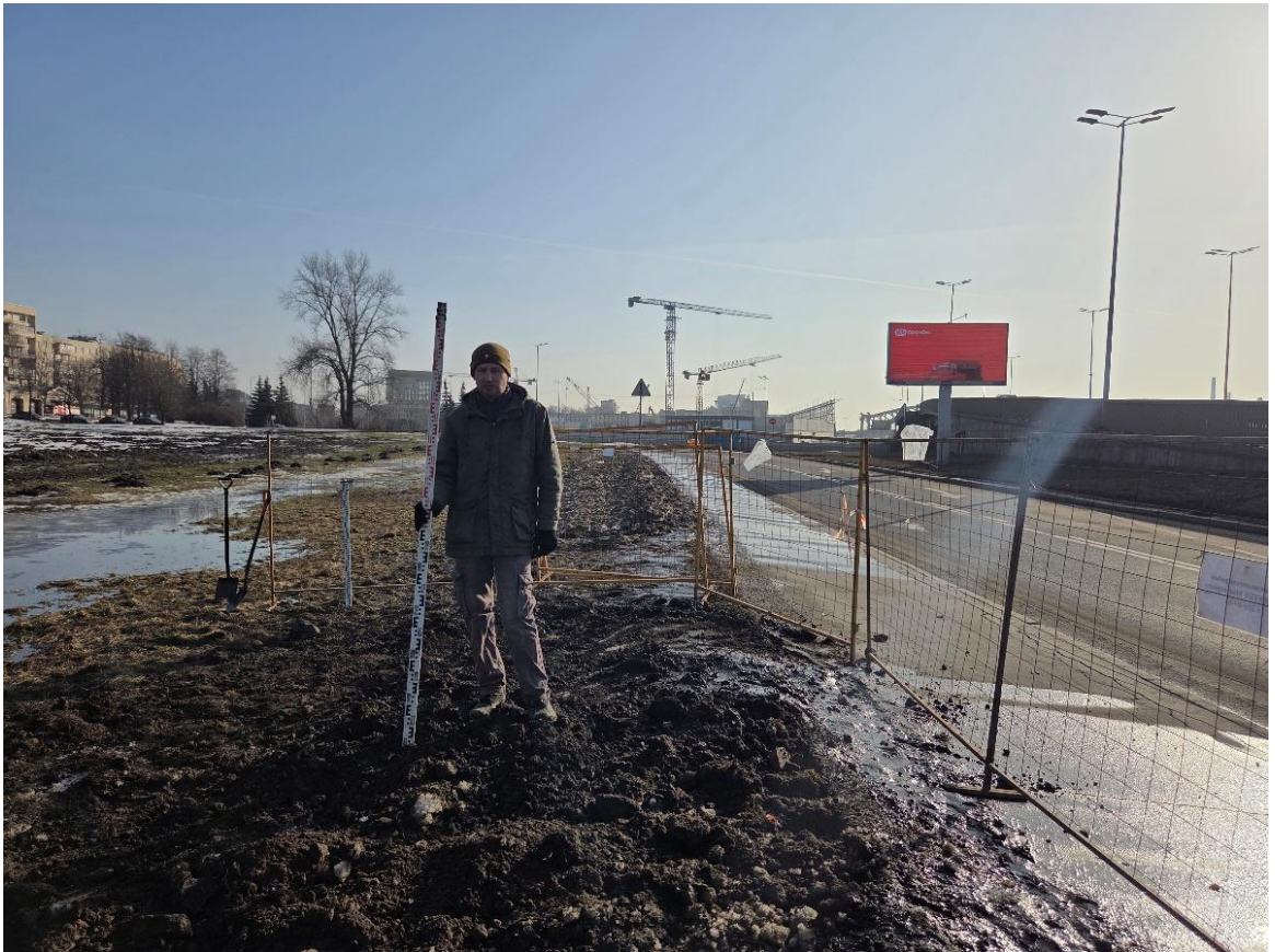
Рис. 24. СПб-2026. Красногвардейский район, «Разработка проектной документации на перекладку силовых кабельных линий внешнего электроснабжения 0,4 кВ КНС у Малоохтинского моста» Шурф 1. Рекультивация. Вид с севера
