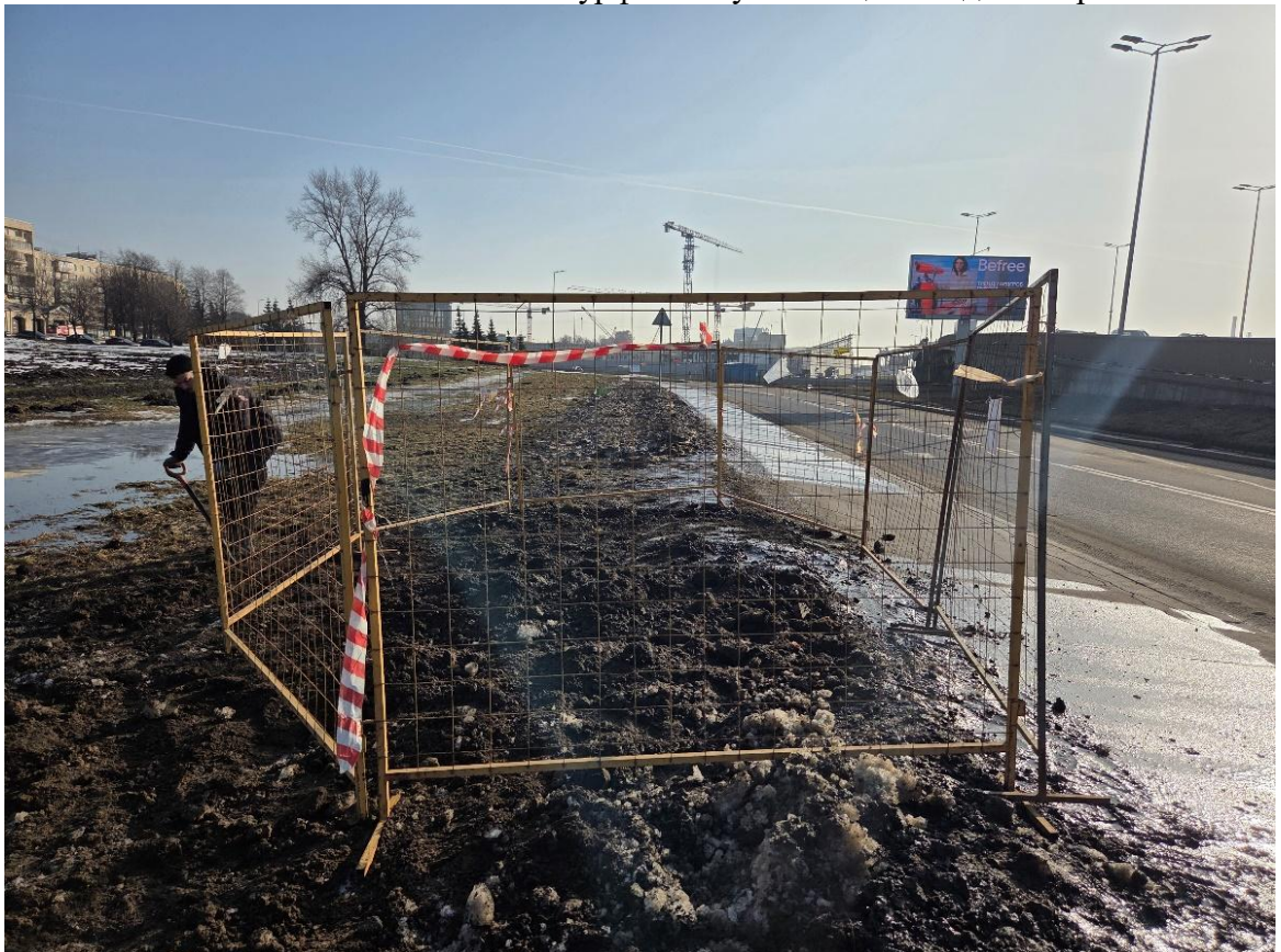
Рис. 25. СПб-2026. Красногвардейский район, «Разработка проектной документации на перекладку силовых кабельных линий внешнего электроснабжения 0,4 кВ КНС у Малоохтинского моста» Шурф 1. Рекультивация и ограждения. Вид с севера
