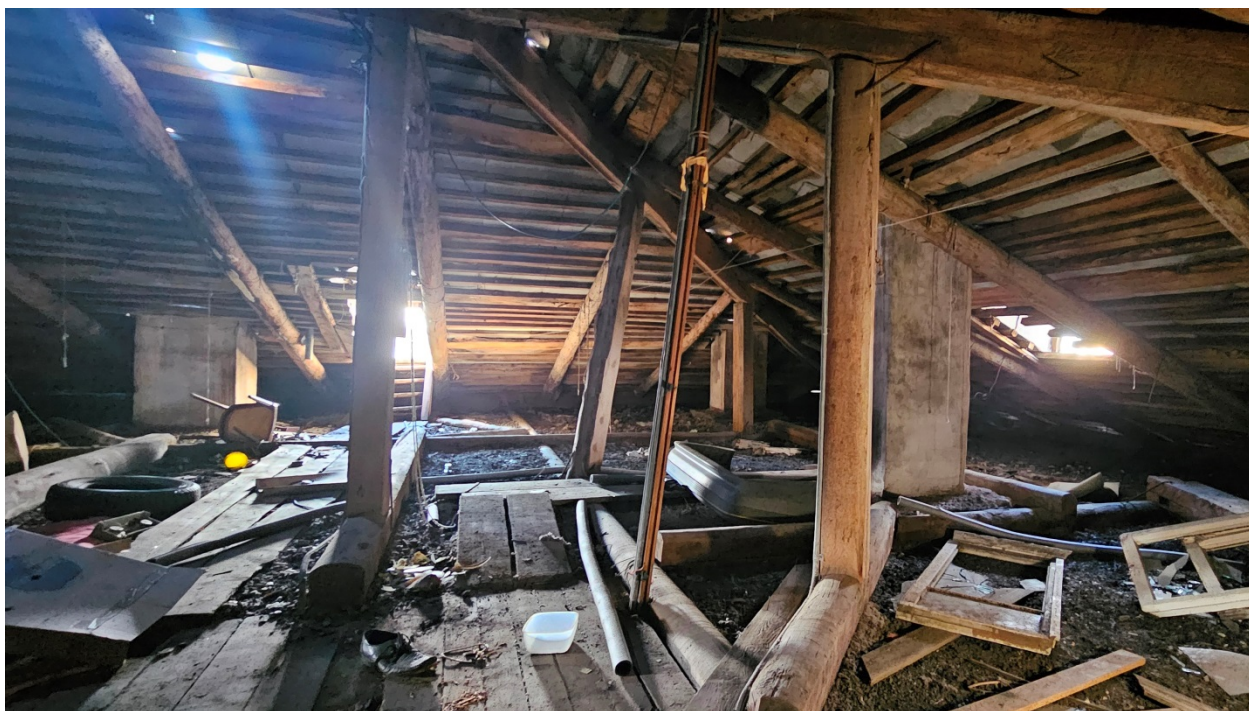
21. Выявленный объект культурного наследия «дом Н. Шарубина(?)». Чердачное пространство. Вид кровельных конструкций.
