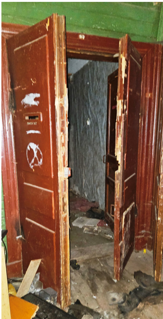
11. Выявленный объект культурного наследия «дом Н. Шарубина(?)». 1-й этаж. Входные двери в пом.1.
