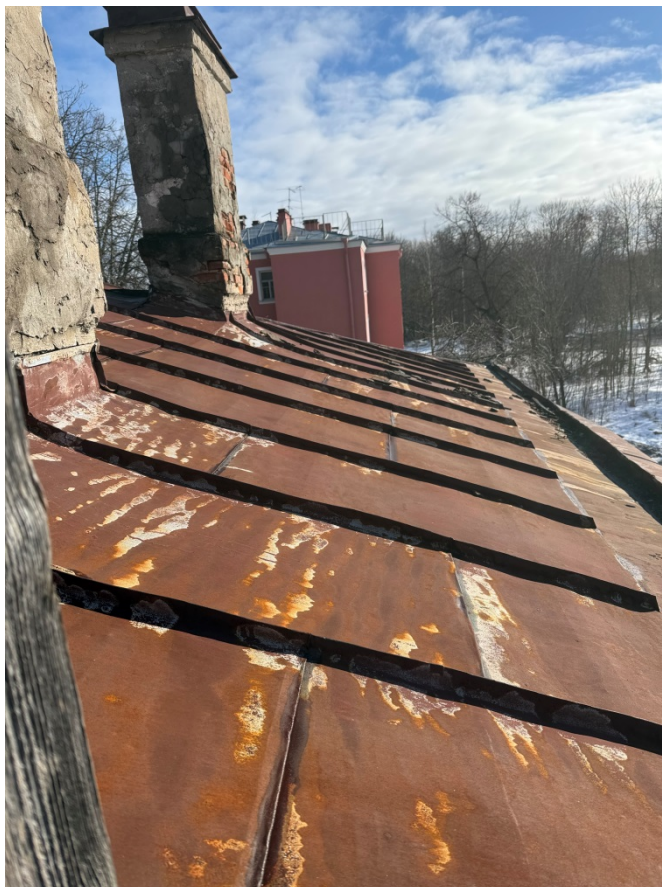
22. Выявленный объект культурного наследия «дом Н. Шарубина(?)». Кровельное покрытие железными листами.
