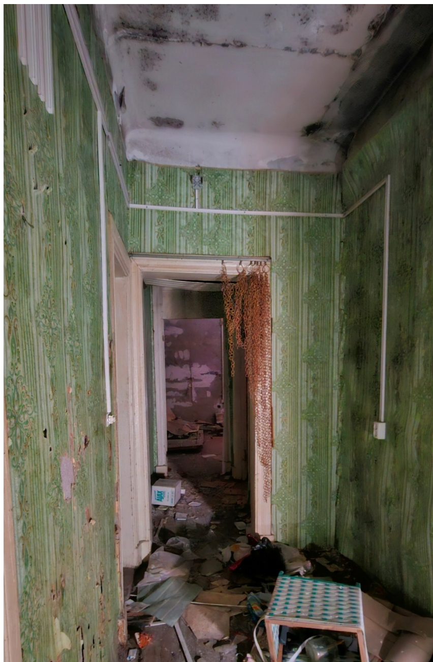
18. Выявленный объект культурного наследия «дом Н. Шарубина(?)». Вид одного из коридоров 2-го этажа.
