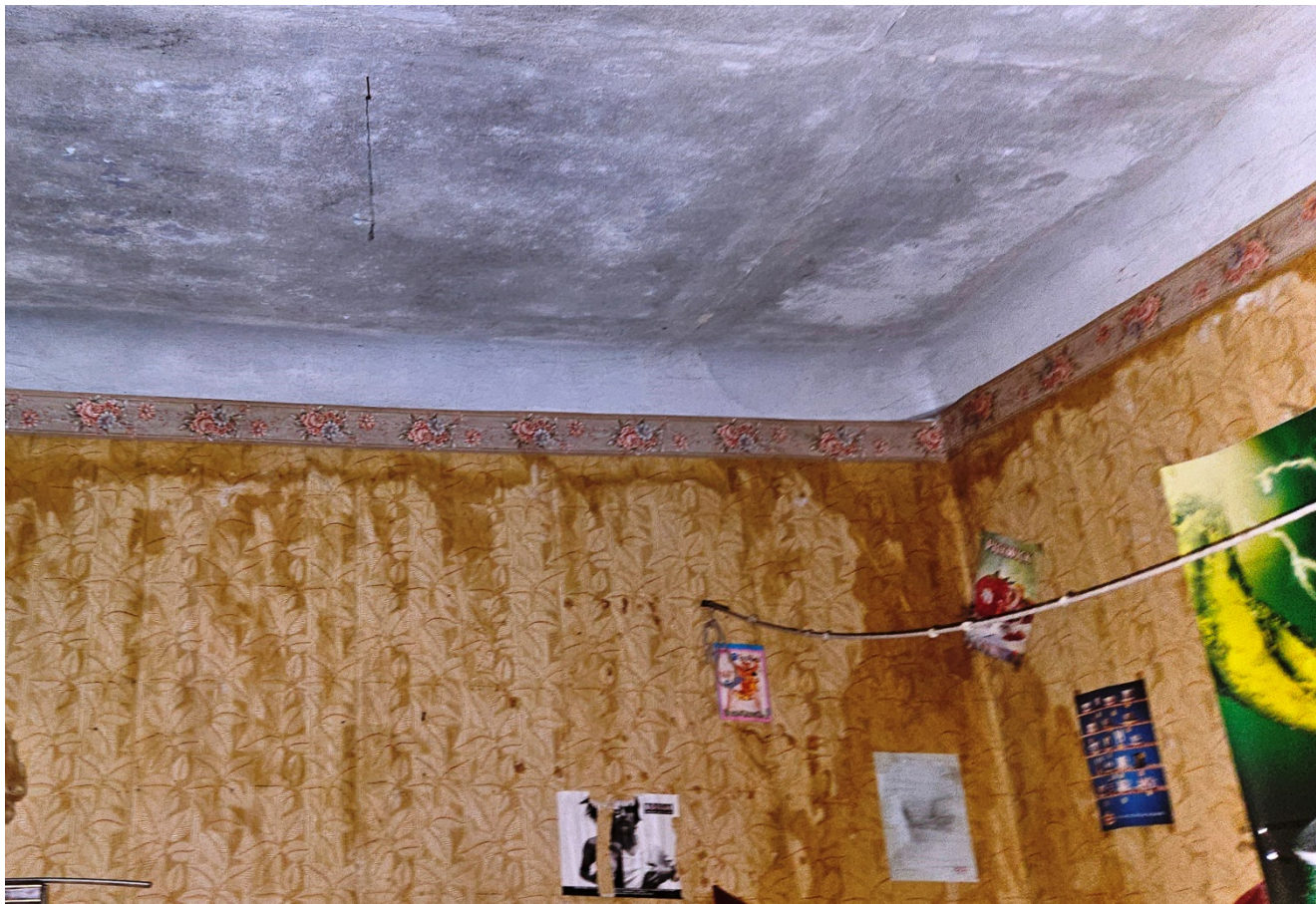
14. Выявленный объект культурного наследия «дом Н. Шарубина(?)». 1-й этаж. Отделка пом.2. Вид потолка.
