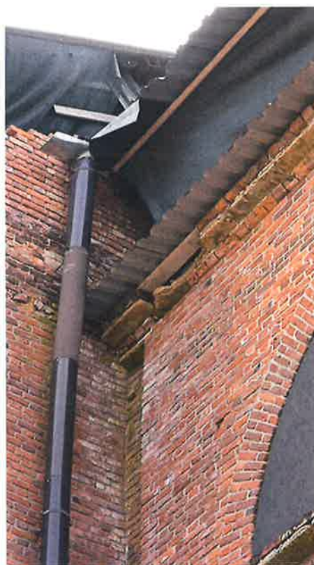
Фото 4. Следы замачивания, высолы, биопоражения кладки, локальные разрушения карнизных плит.
