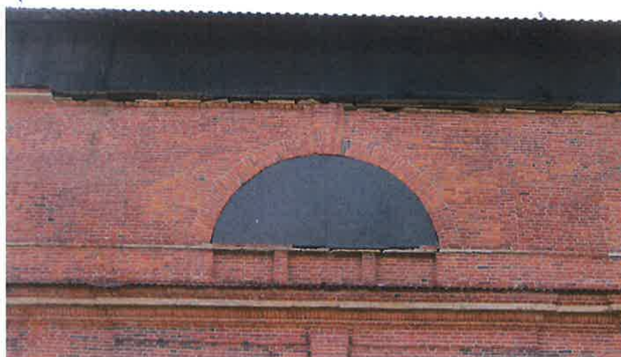
Фото 2. Разрушение и утрата карнизных плит, трещины, деструкция торцевых поверхностей; разрушение кирпичной кладки карнизов.
