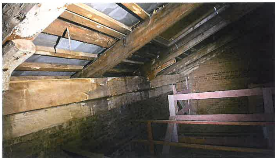
Фото 11. Следы замачивания стропил и обрешетки, продольные трещины усушки.
