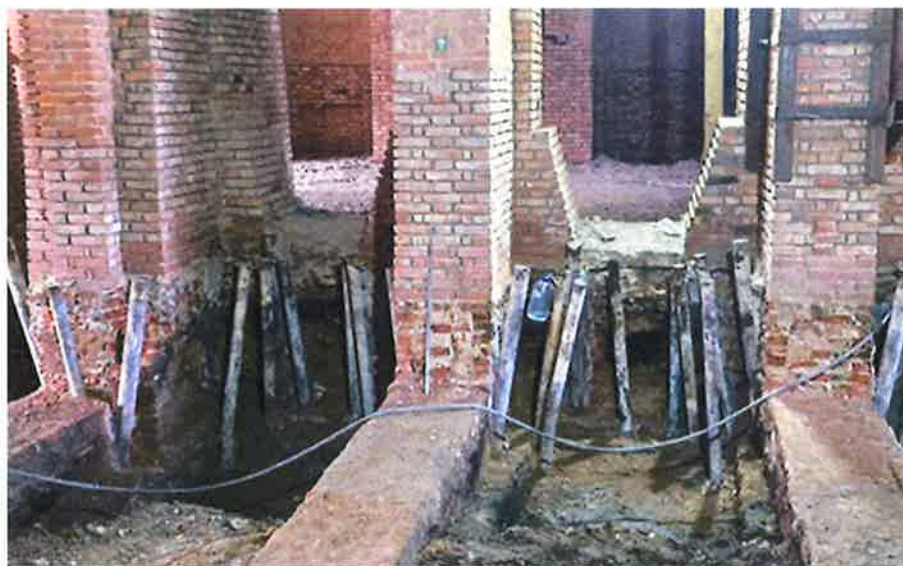
Фото 1. Следы замачивания, деструкция заглубленной части кладки стен.
