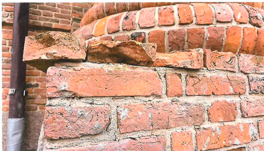
Фото 3. Деструкция кладки базы колонн с локальными разрушениями, потерей сцепления отдельных кирпичей с кладкой.
