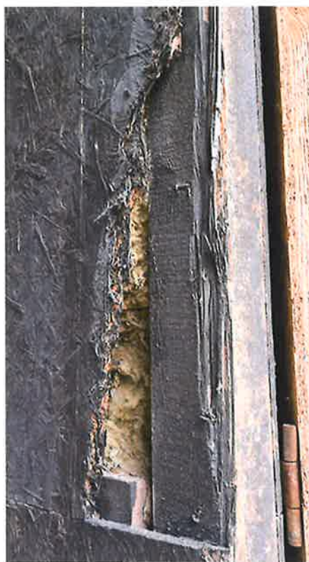
Фото 7. Повреждение щита закрытия проема фасадной стены.
