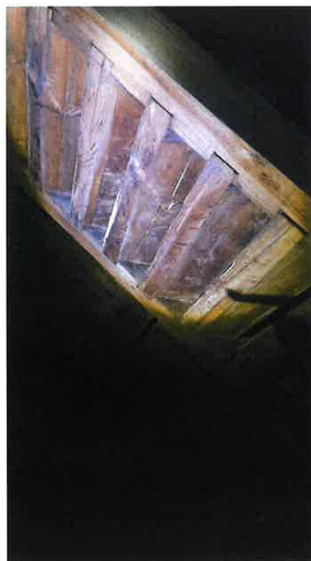
Фото 10. Трещина в ступени деревянной лестницы.
