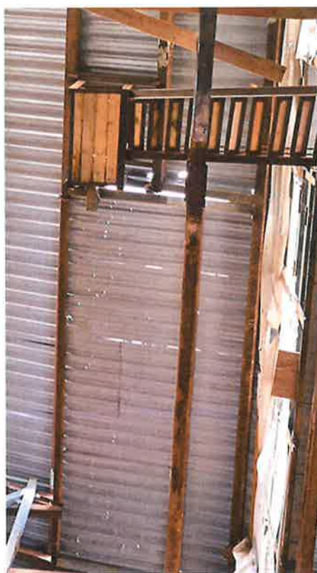
Фото 8. Сквозные отверстия, щели, нарушение целостности кровельного покрытия.
