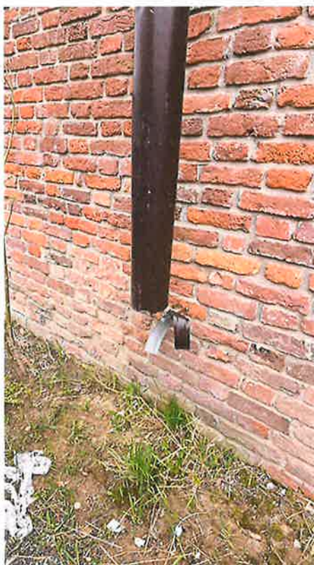
Фото 5. Повреждение водосточной трубы, недостаточный отвод влаги от стен.
