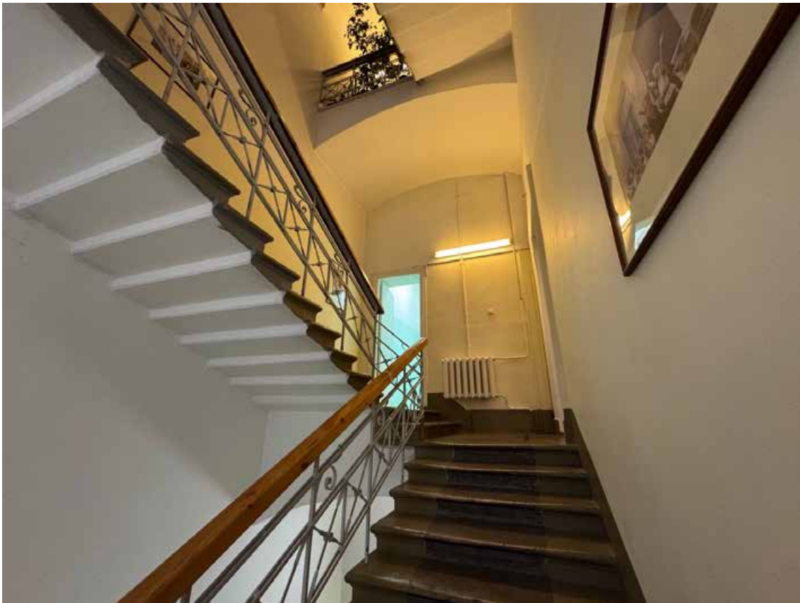
62. Объект культурного наследия регионального значения «Канцелярия Съезда мировых судей», по адресу: г. Санкт-Петербург, Гражданская ул., д. 26, литера А. Общий вид служебной лестницы в уровне 2 этажа.
