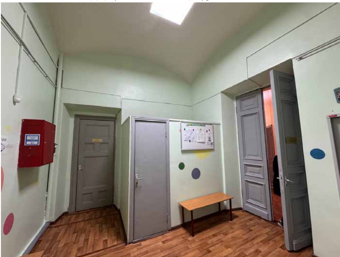
21. Объект культурного наследия регионального значения «Канцелярия Съезда мировых судей», по адресу: г. Санкт-Петербург, Гражданская ул., д. 26, литера А. Общий вид пом. 7-Н (6) в уровне 1 этажа.
