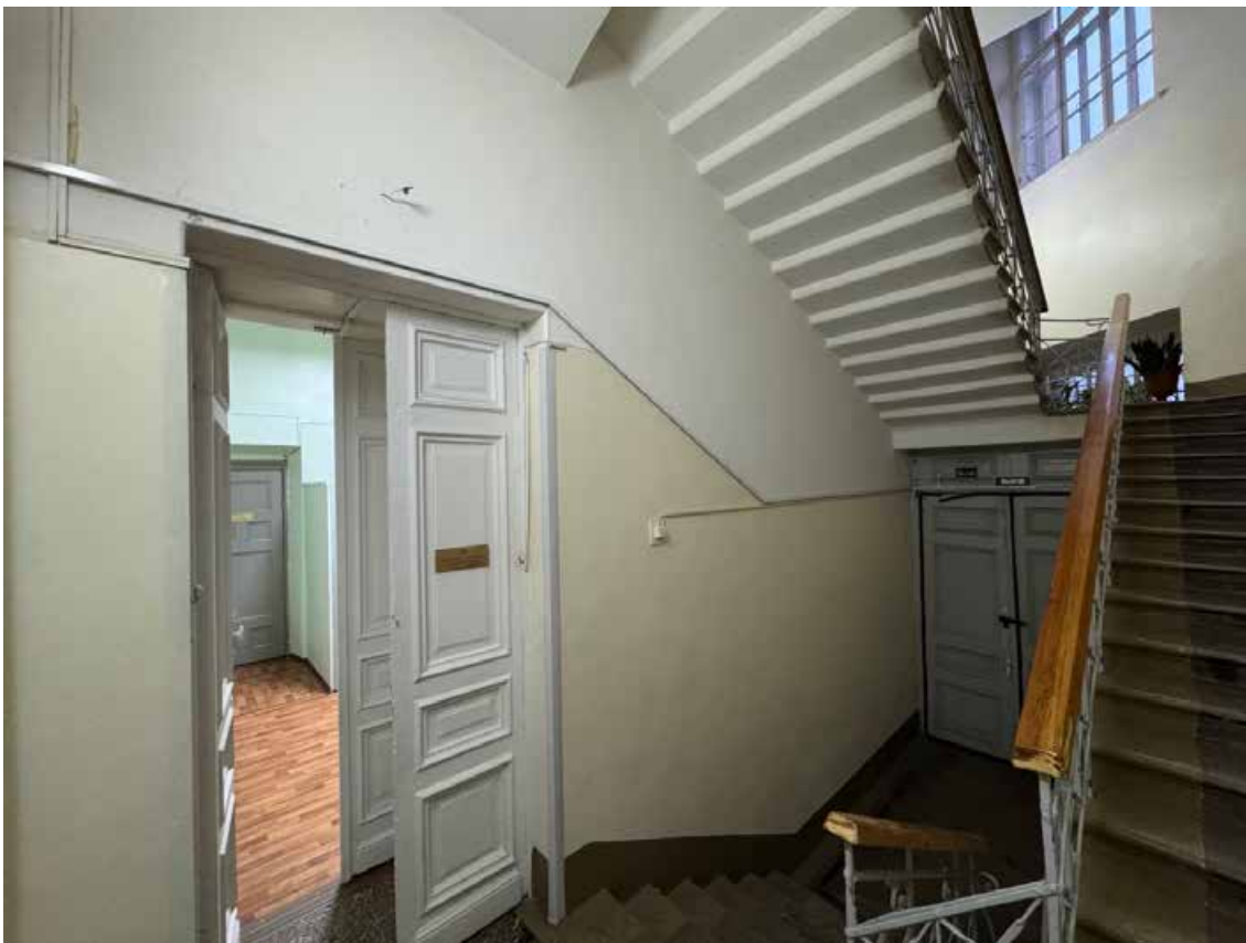
24. Объект культурного наследия регионального значения «Канцелярия Съезда мировых судей», по адресу: г. Санкт-Петербург, Гражданская ул., д. 26, литера А. Общий вид пом. 7-Н (3) в уровне 1 этажа.
