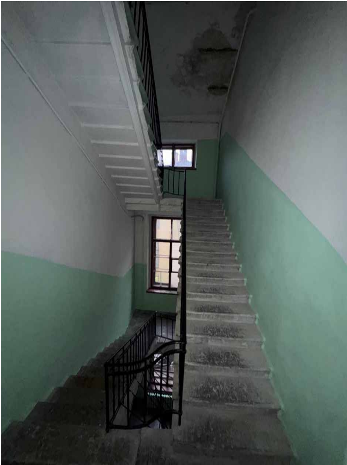
105. Объект культурного наследия регионального значения «Канцелярия Съезда мировых судей», по адресу: г. Санкт-Петербург, Гражданская ул., д. 26, литера А. Общий вид лестницы Л-3 в уровне 4 этажа.
