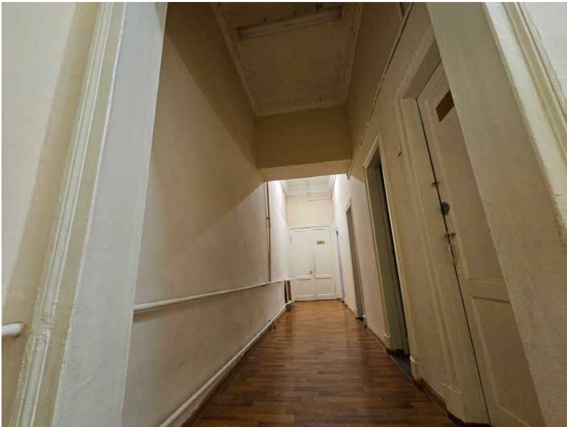
95. Объект культурного наследия регионального значения «Канцелярия Съезда мировых судей», по адресу: г. Санкт-Петербург, Гражданская ул., д. 26, литера А. Общий вид пом. 1-Н (87) в уровне 3 этажа.
