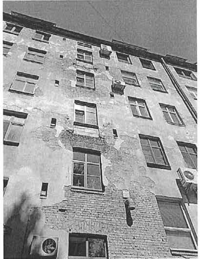
Фото 56. Фрагмент дворового фасада. Балконы в уровне 4 и 6 этажей черной лестничной клетки (где расположены квартиры №№ 156, 157) отсутствуют. Выполнена закладка нижней части указанных проемов блоками из газобетона. Взамен балконных дверей установлены окна.
