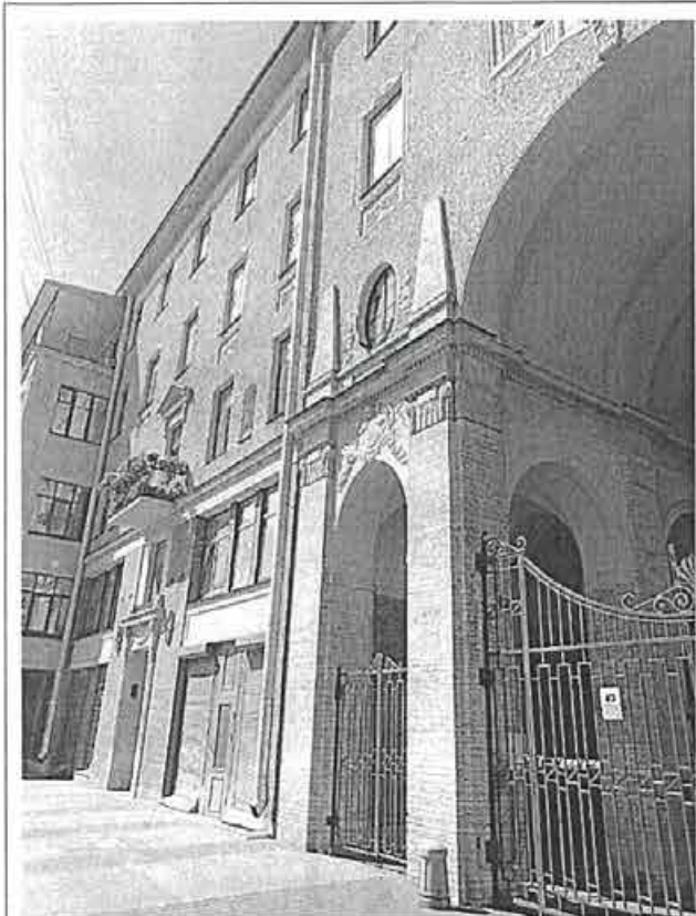
Фото 47. Фрагмент лицевого фасада со стороны Рубинштейна. Левая сторона. над ризалитом лицевого фасада со стороны улицы Рубинштейна в границах квартиры № 552 устроен навес на опорах.
