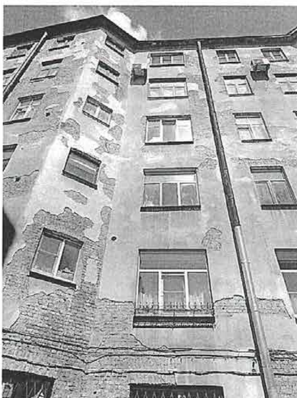
Фото 62. Фрагмент дворового фасада внешнего контура. Ненадлежащее состояние штукатурной отделки фасадов.
