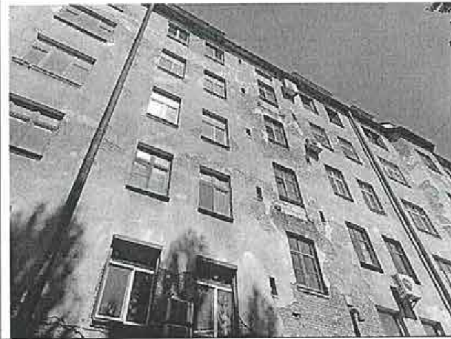
Фото 58. Фрагмент дворового фасада внешнего контура. Балконы в уровне 4 и 6 этажей черной лестничной клетки (где расположены квартиры №№ 156, 157) отсутствуют. Выполнена закладка нижней части указанных проемов блоками из газобетона. Взамен балконных дверей установлены окна
