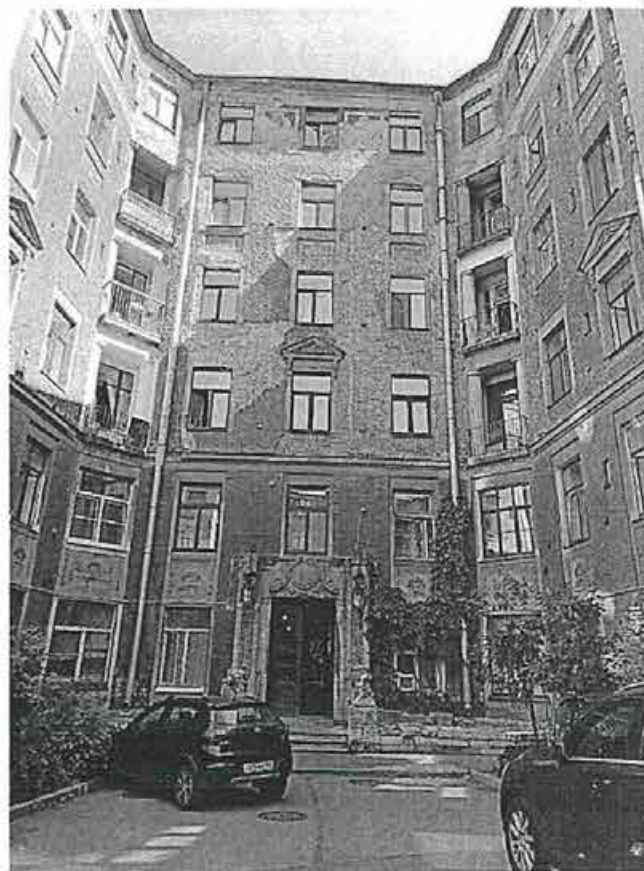
Фото 22. Дворовые фасады внутреннего двора, где расположена парадная № 9. Ненадлежащее состояние штукатурной отделки фасадов.
