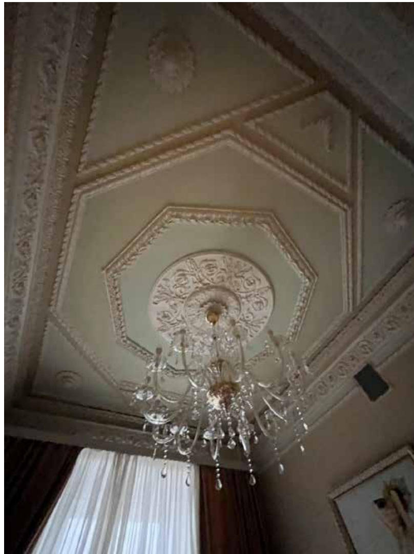
Фото №24. Квартира №263, пом. 16 (потолок).
