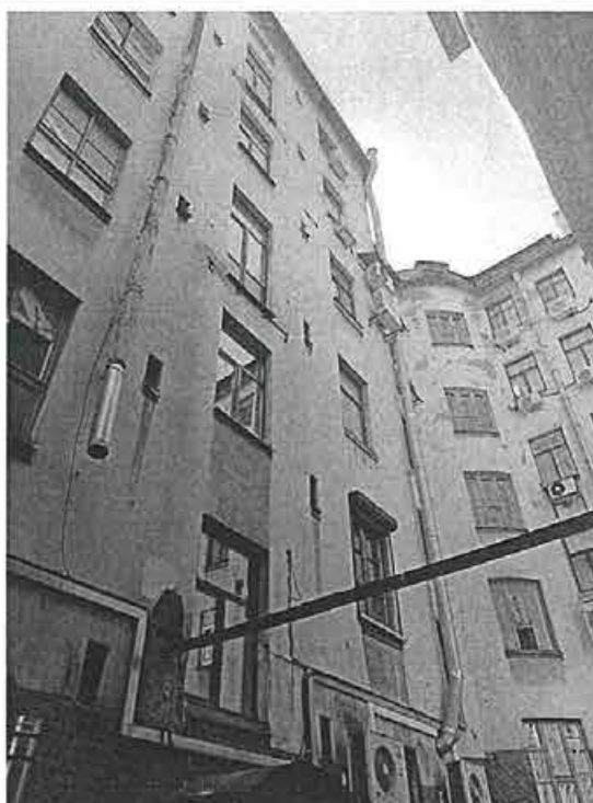
Фото 110. Фрагмент дворового фасада внешнего контура. Утрата фрагментов водосточных труб.
