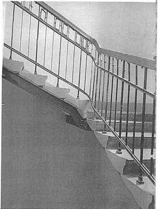
Фото 6. Парадная лестница (вход с фасада по наб. реки Фонтанки по первой световой оси)
