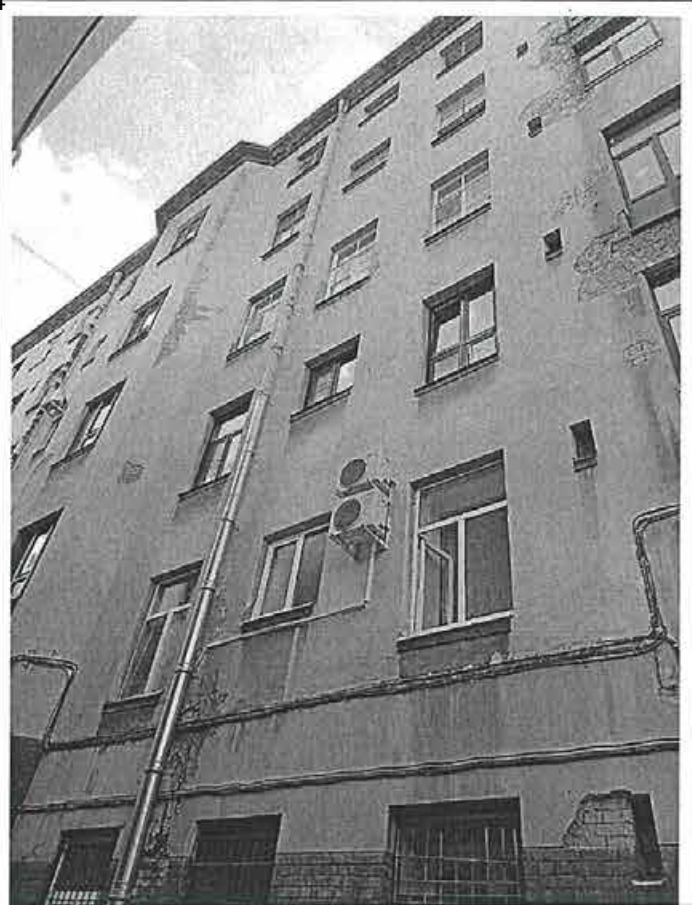
Фото 120. Фрагмент дворового фасада внешнего контура здания. Выполнено увеличение габаритов оконного проема квартиры № 404
