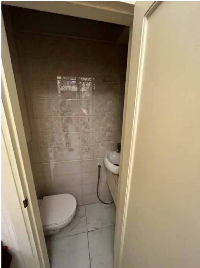
Фото №22. Квартира №263, пом. 17 (санузел).
