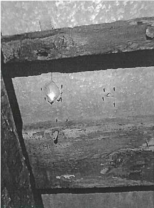
Фото 67. Фрагмент кровли, имеются сквозные отверстия, следы пожара.
