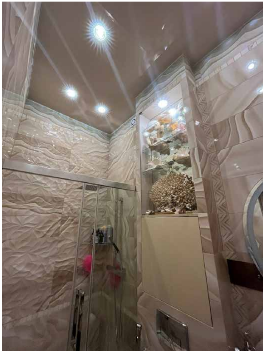
Фото №12. Квартира №263, пом. 8 (санузел).
