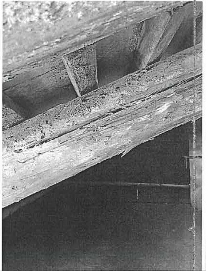
Фото 76. Фрагмент крыши. Наблюдаются трещины стропильных ног.
