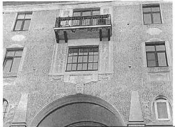
Фото 2. Фрагмент лицевого фасада со стороны наб. реки Фонтанки. Наблюдается утрата штукатурной отделки балконной плиты.
