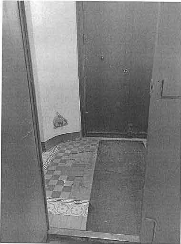
Фото 91. Фрагмент тамбура парадной № 10, (где расположены квартиры №№ 159, 160). Наблюдаются значительные утраты фрагментов метлахской плитки.
