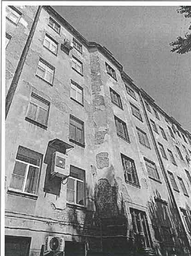
Фото 59. Фрагмент дворового фасада внешнего контура. Ненадлежащее состояние штукатурной отделки фасадов.
