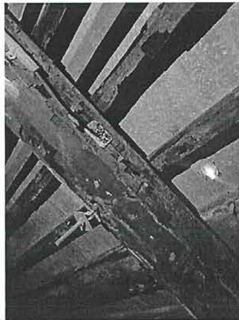
Фото 66. Крыша. Имеются сквозные отверстия в кровле. На стропилах и обрешетке имеются следы пожара.
