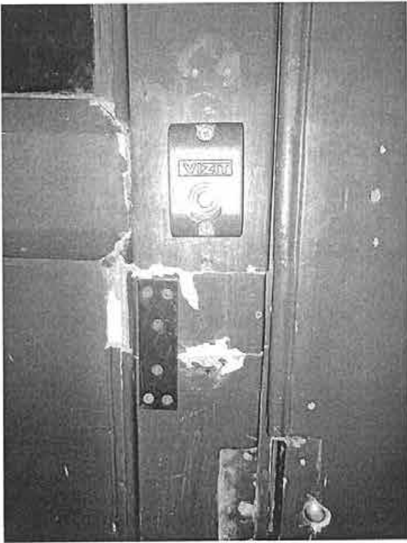
Фото 87. Дверное заполнение квартиры № 309-328. Фрагмент. Отслоение краски в районе замка, утрата фрагмента штапика.
