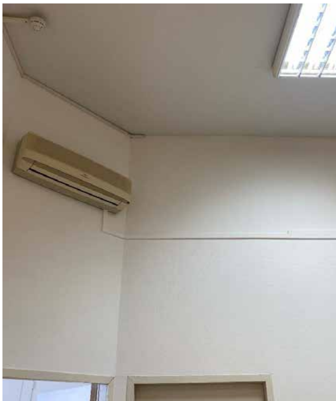
Фото 12, 3 этаж. Внутренний блок кондиционирования
