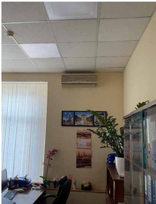
Фото 7, 2 этаж. Внутренний блок кондиционирования
