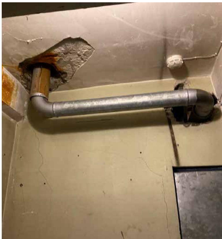
Фото 12, 1 этаж. Коридор. Общий вид трубы водоснабжения
