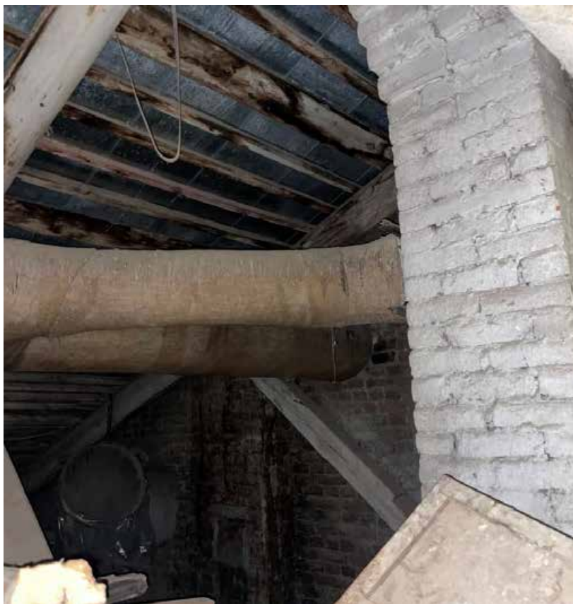
Фото 16. Чердак, вид на разводку труб вентиляции
