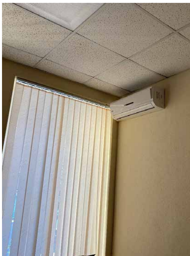
Фото 8, 2 этаж. Внутренний блок кондиционирования
