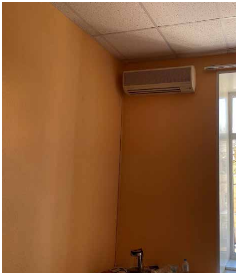
Фото 13, 2 этаж. Внутренний блок кондиционирования
