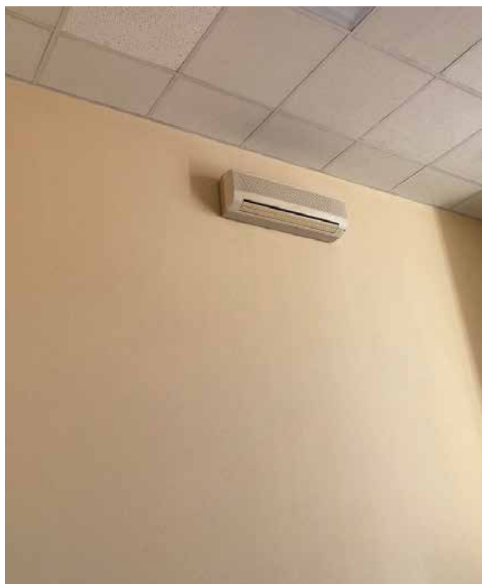
Фото 4, 3 этаж. Внутренний блок кондиционирования
