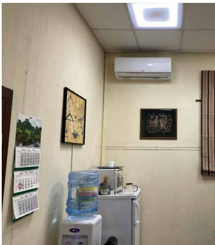
Фото 14, 2 этаж. Внутренний блок кондиционирования
