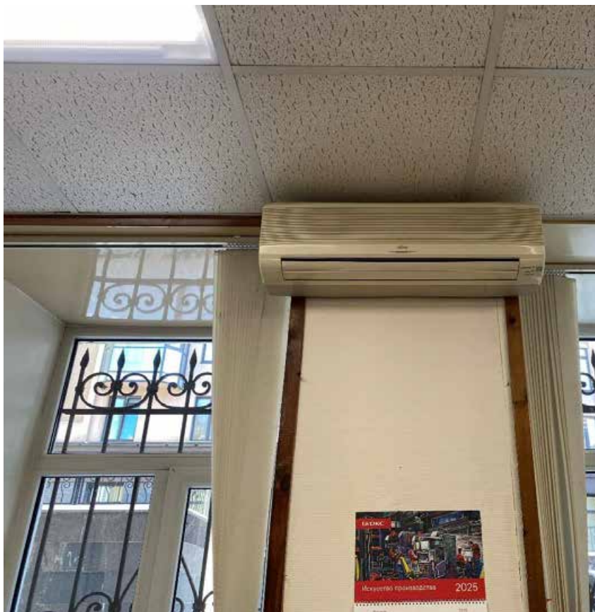
Фото 9, 1 этаж. Внутренний блок кондиционирования
