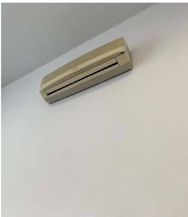
Фото 14, 3 этаж. Внутренний блок кондиционирования
