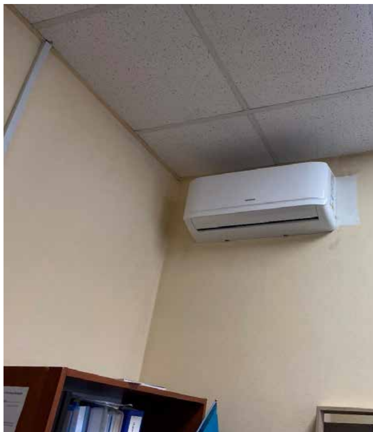
Фото 12, 2 этаж. Внутренний блок кондиционирования
