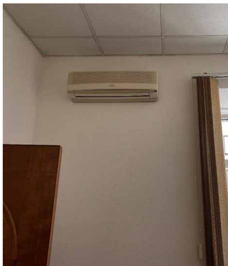
Фото 18, 2 этаж. Внутренний блок кондиционирования
