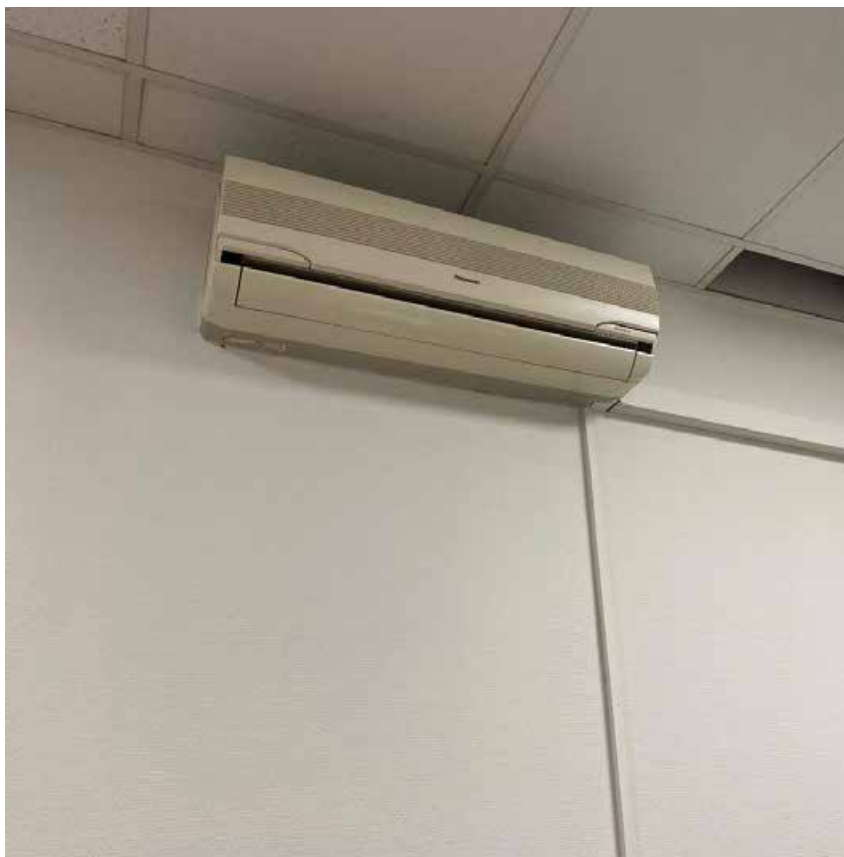
Фото 10, 1 этаж. Внутренний блок кондиционирования
