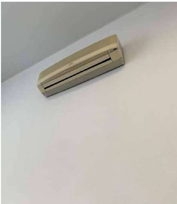
Фото 14, 3 этаж. Внутренний блок кондиционирования
