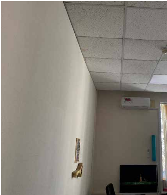
Фото 17, 3 этаж. Внутренний блок кондиционирования
