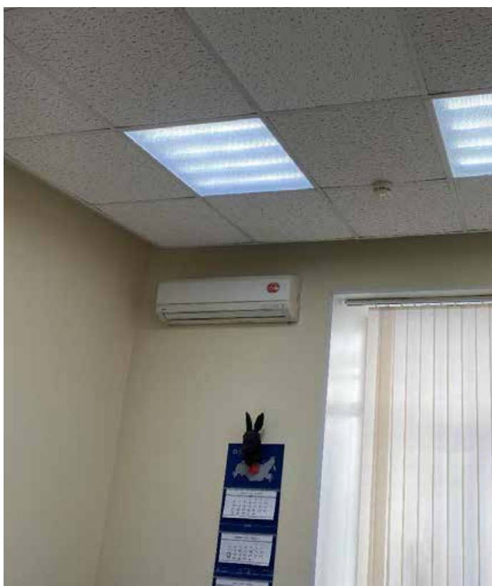
Фото 18, 3 этаж. Внутренний блок кондиционирования
