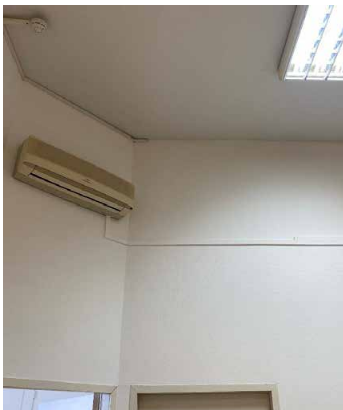
Фото 12, 3 этаж. Внутренний блок кондиционирования
