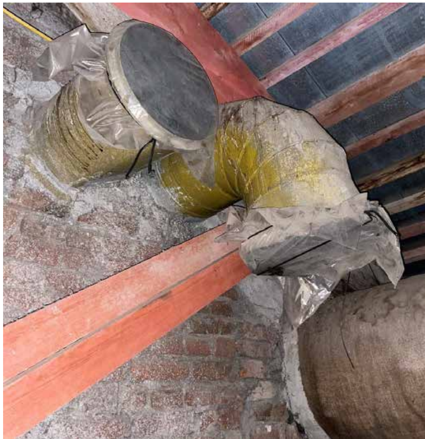
Фото 15. Чердак, обрыв труб вентиляции
