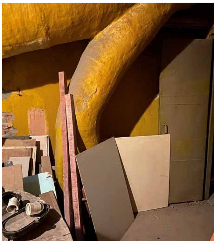
Фото 10. Чердак, вид на разводку труб вентиляции
