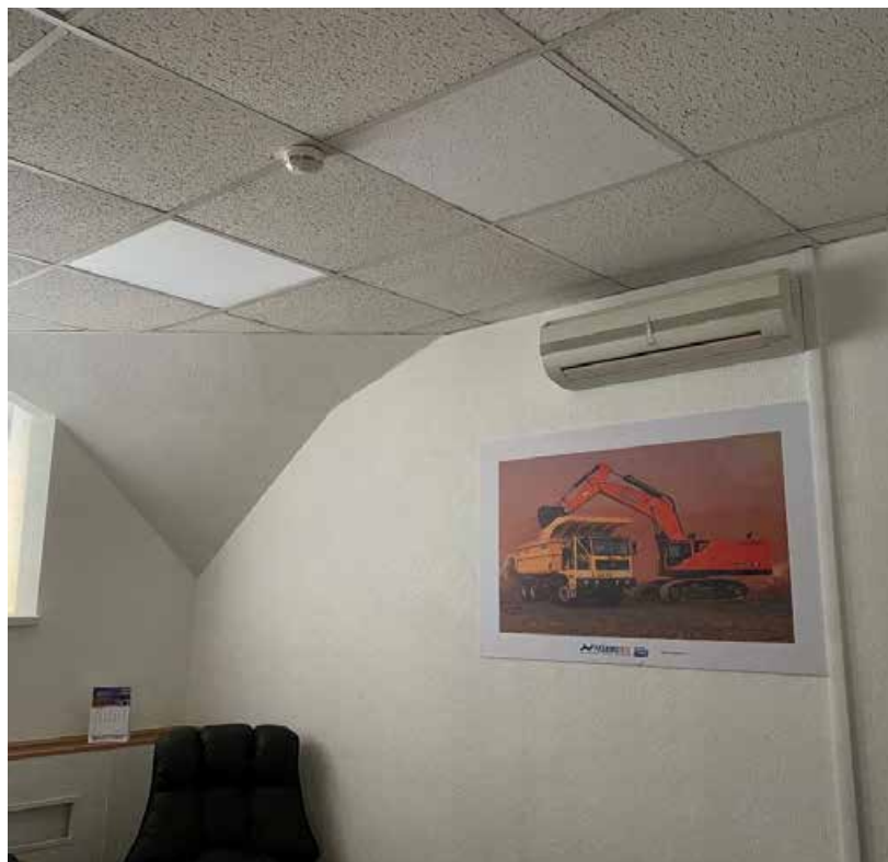
Фото 5, 1 этаж. Внутренний блок кондиционирования
