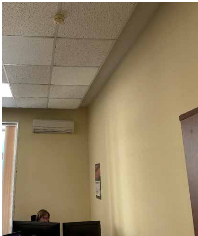
Фото 19, 3 этаж. Внутренний блок кондиционирования
