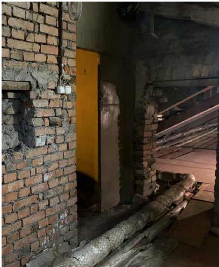
Фото 7. Чердак, вид на разводку тепловой сети
