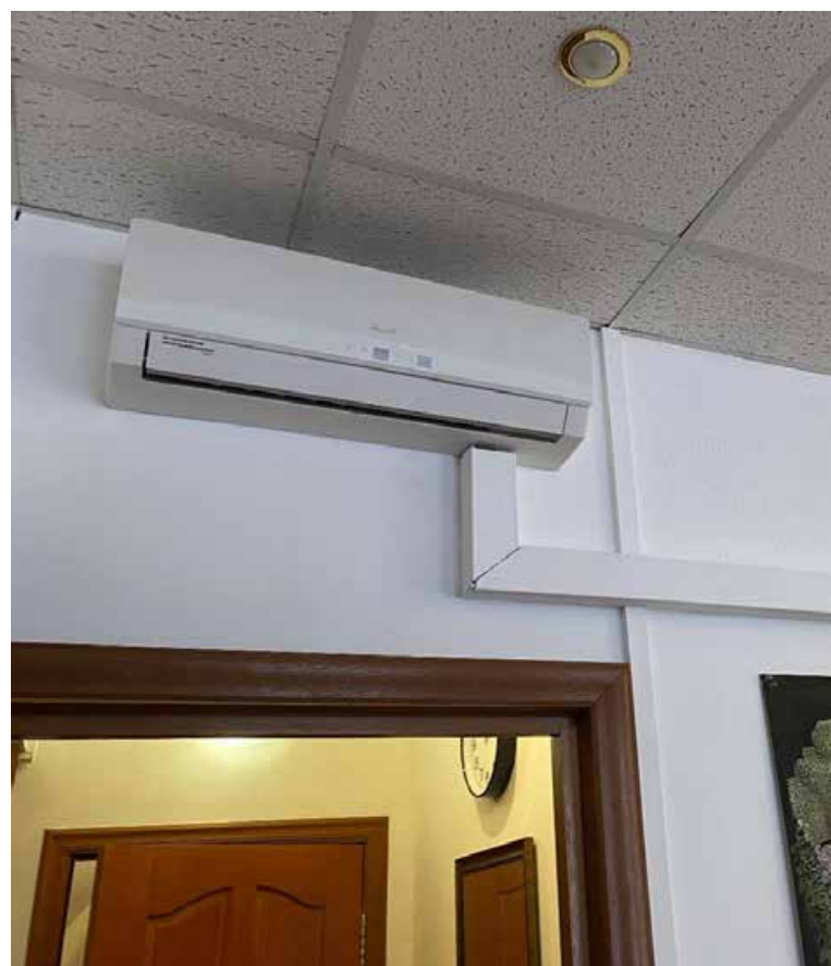
Фото 2, 1 этаж. Внутренний блок кондиционирования
