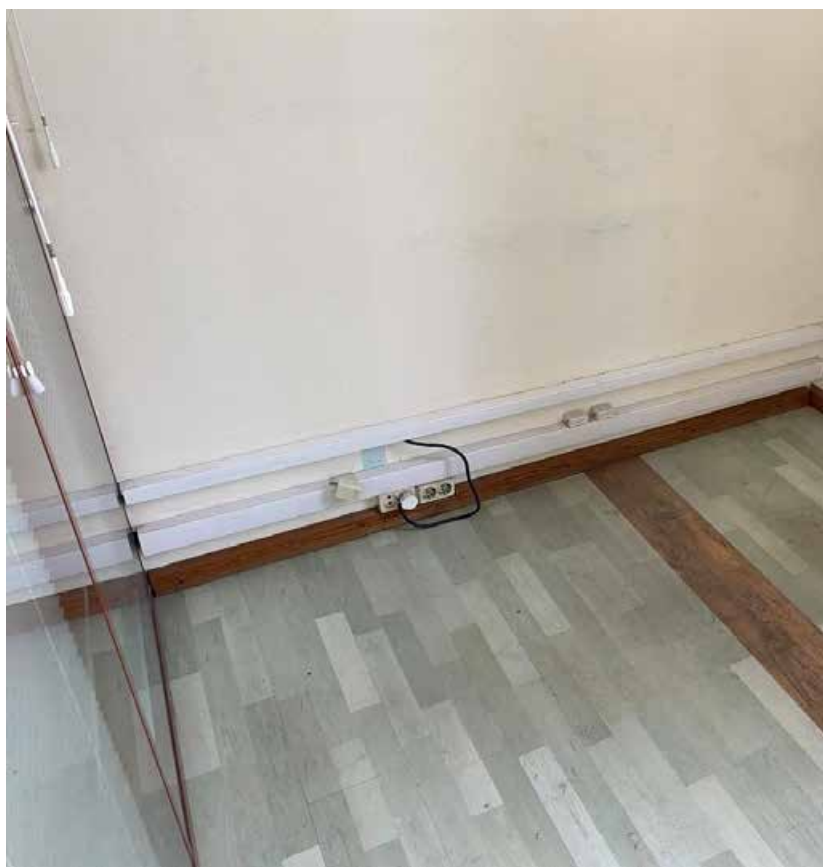
Фото 4, 2 этаж. Кабинет. Трассы соединяющие блоки кондиционирования
