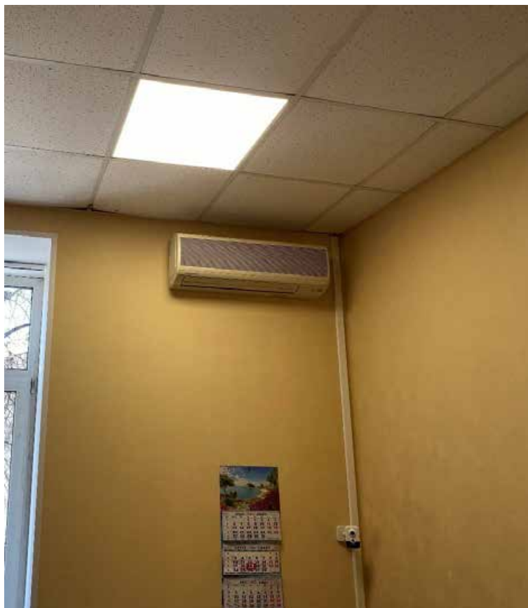
Фото 11, 2 этаж. Внутренний блок кондиционирования
