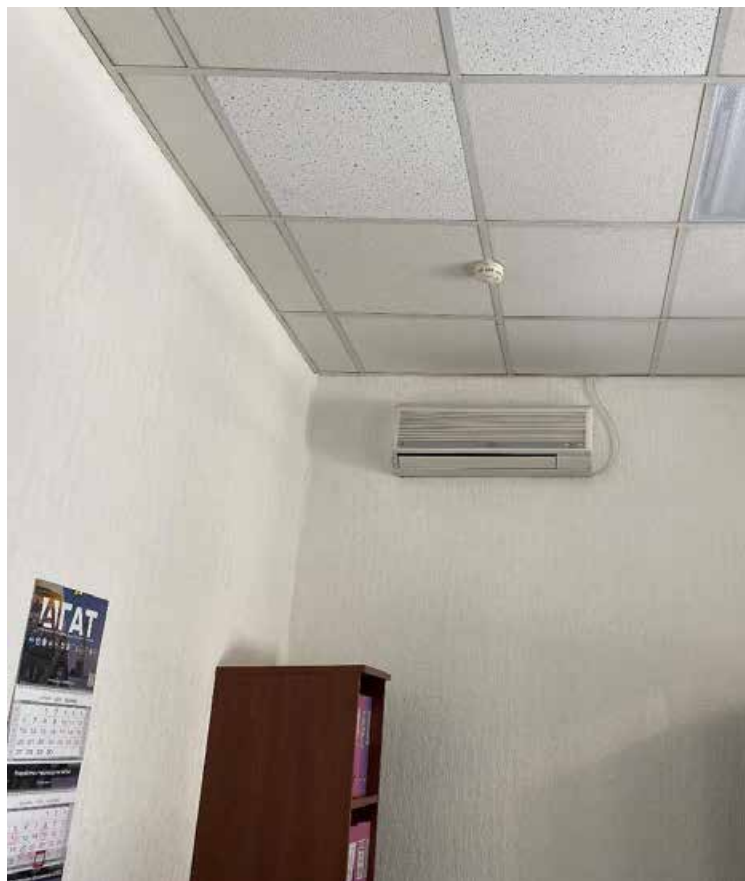
Фото 17, 2 этаж. Внутренний блок кондиционирования
