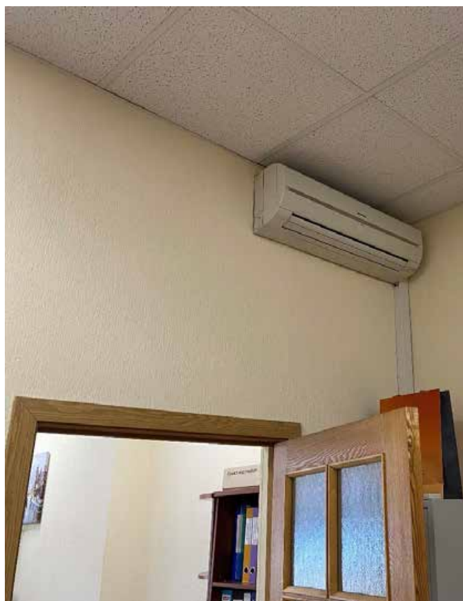
Фото 6, 2 этаж. Внутренний блок кондиционирования
