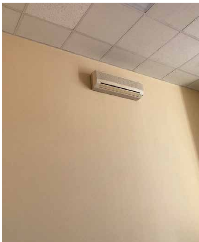
Фото 4, 3 этаж. Внутренний блок кондиционирования
