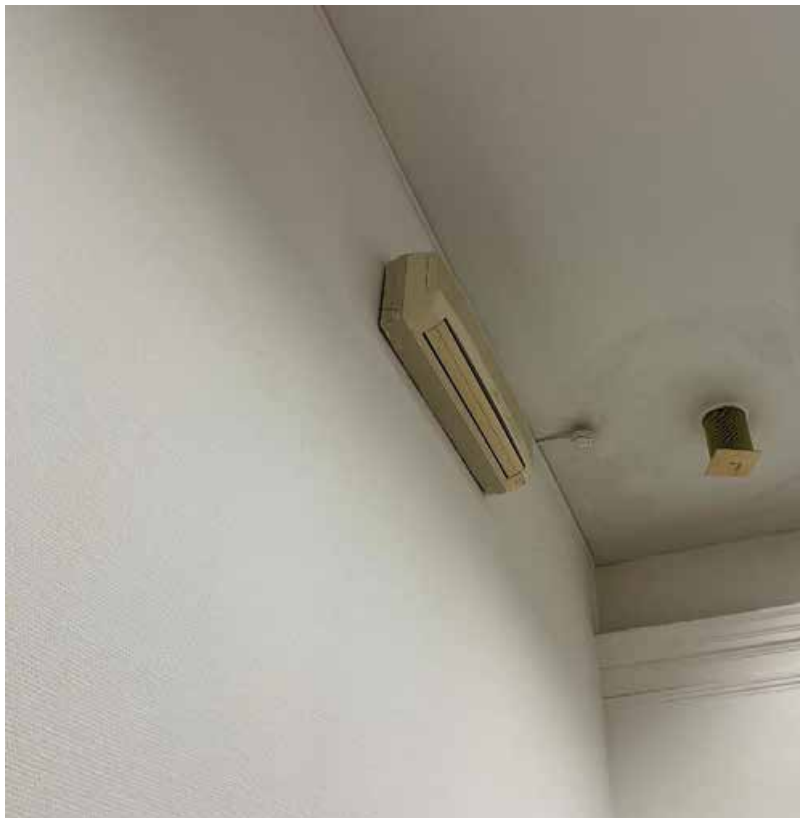
Фото 15, 3 этаж. Внутренний блок кондиционирования
