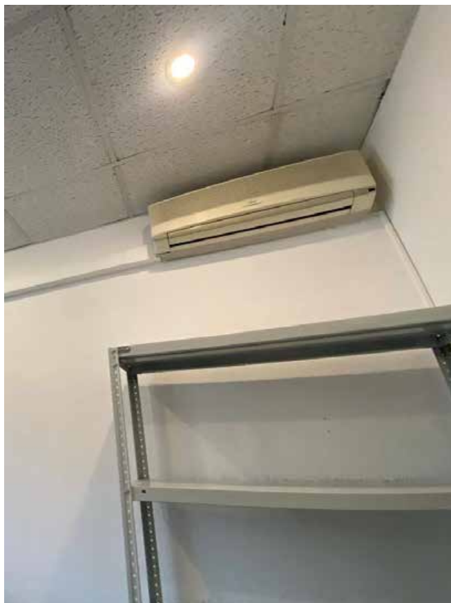
Фото 3, 1 этаж. Внутренний блок кондиционирования
