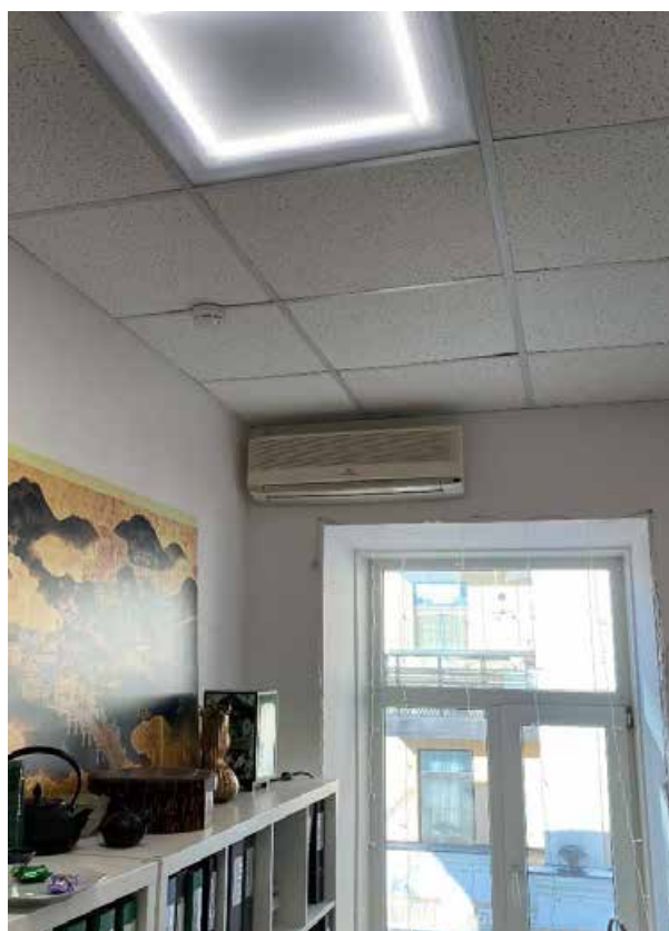
Фото 2, 4 этаж. Внутренний блок кондиционирования
