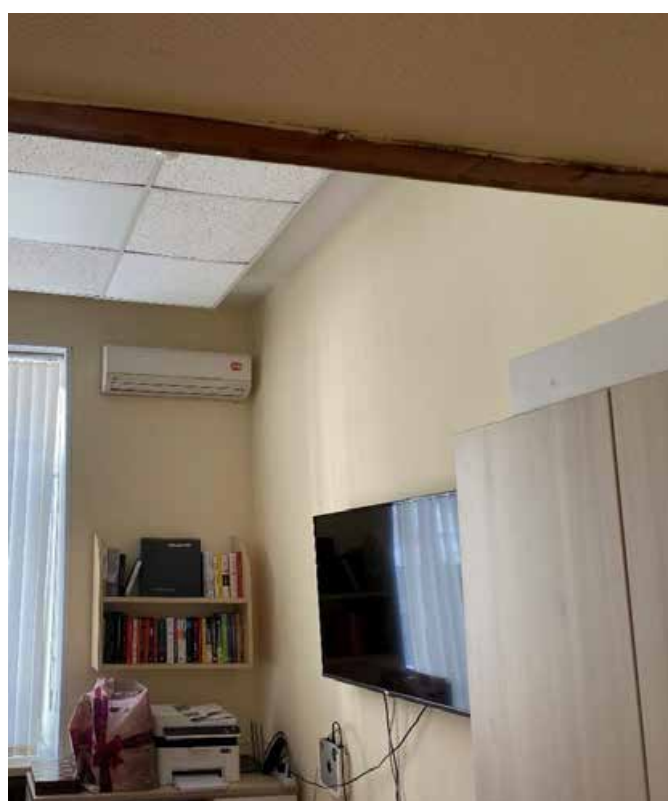
Фото 20, 3 этаж. Внутренний блок кондиционирования
