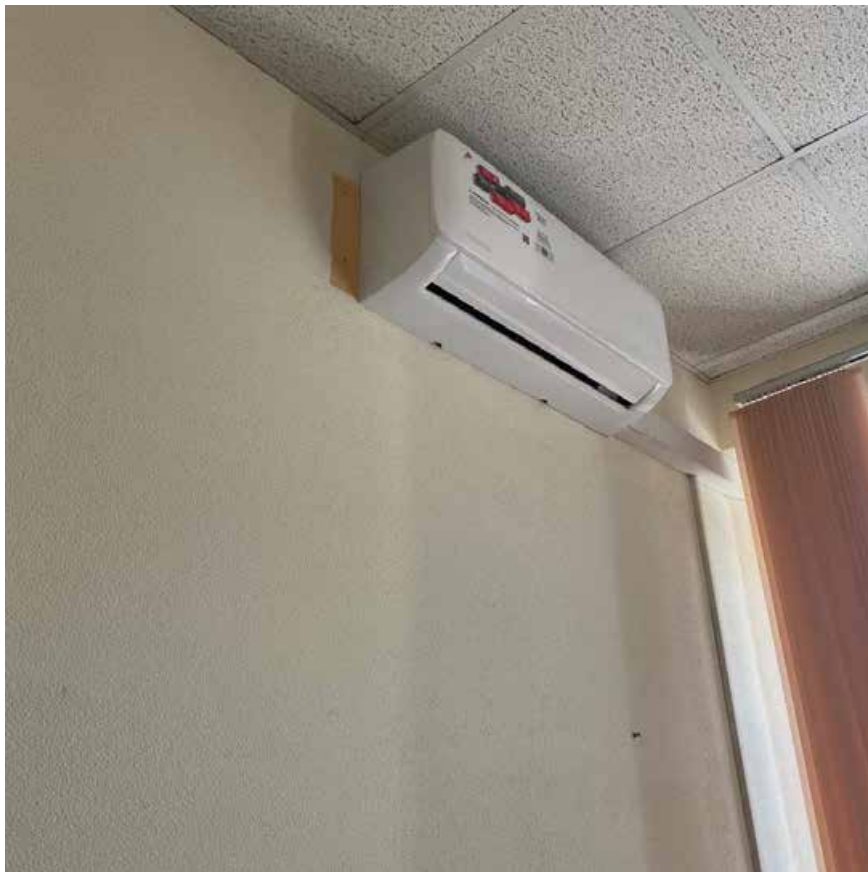
Фото 1, 2 этаж. Внутренний блок кондиционирования
