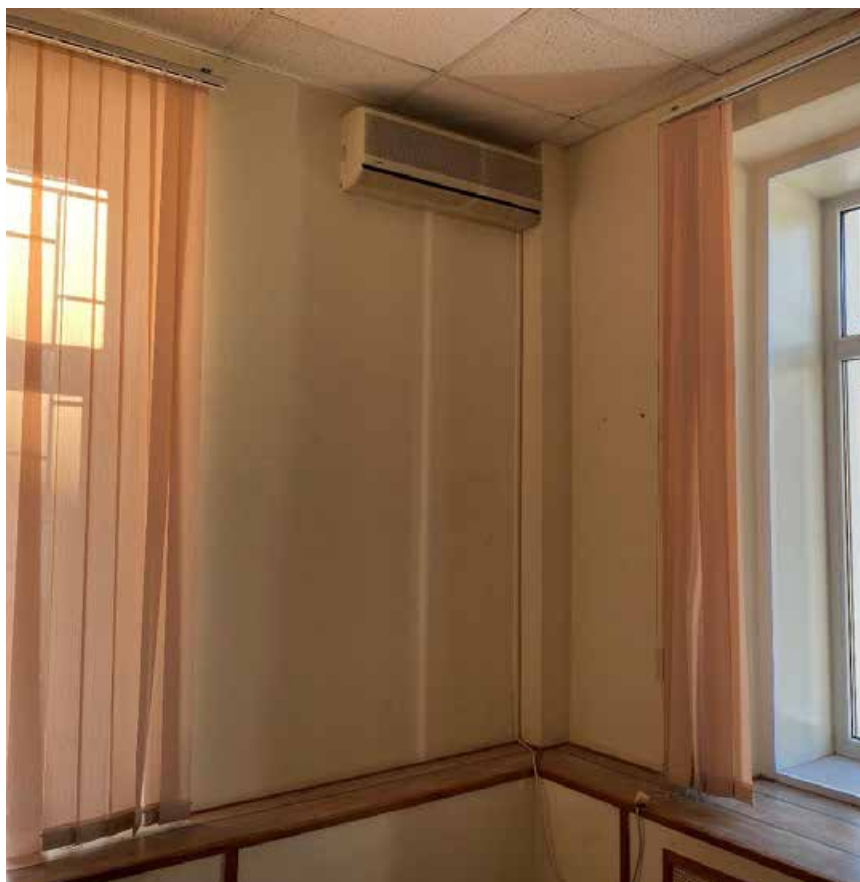
Фото 2, 2 этаж. Кабинет. Внутренний блок кондиционирования
