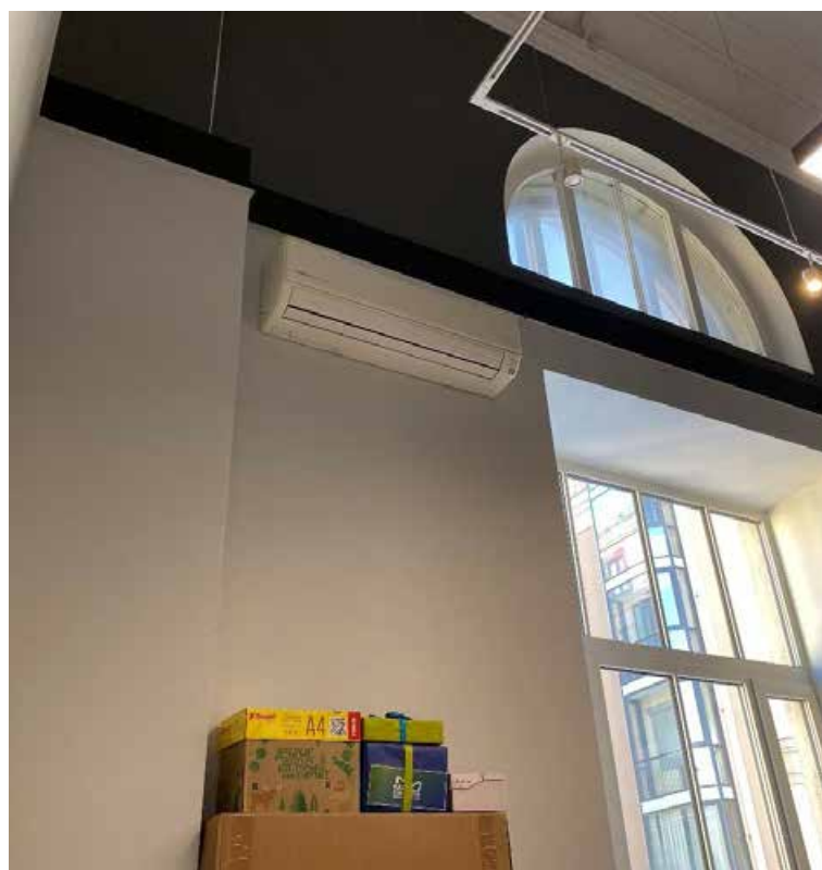
Фото 6, 3 этаж. Внутренний блок кондиционирования
