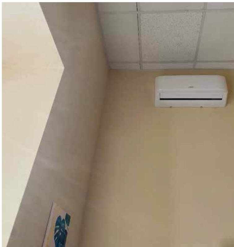
Фото 5, 3 этаж. Внутренний блок кондиционирования
