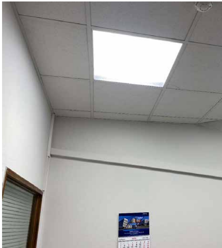
Фото 11, 1 этаж. Трасса, соединяющая блоки кондиционирования
