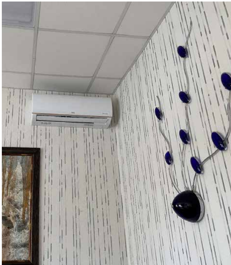
Фото 15, 2 этаж. Внутренний блок кондиционирования
