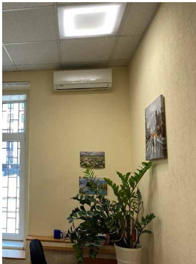
Фото 5, 2 этаж. Кабинет. Внутренний блок кондиционирования
