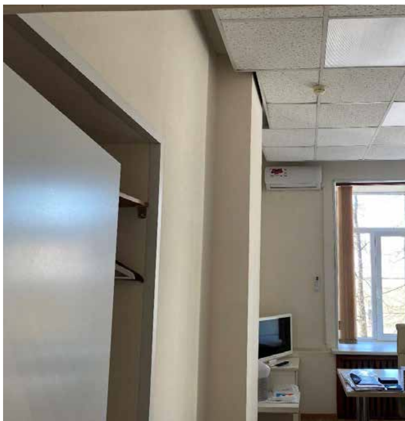
Фото 16, 3 этаж. Внутренний блок кондиционирования
