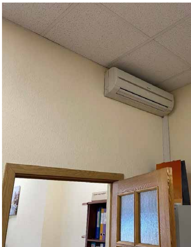
Фото 6, 2 этаж. Внутренний блок кондиционирования
