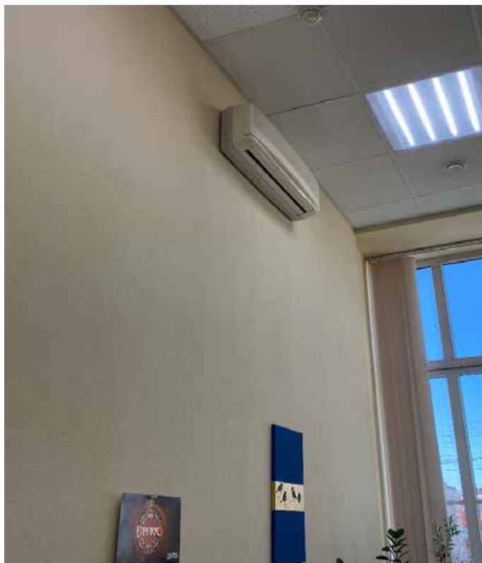
Фото 1, 3 этаж. Внутренний блок кондиционирования
