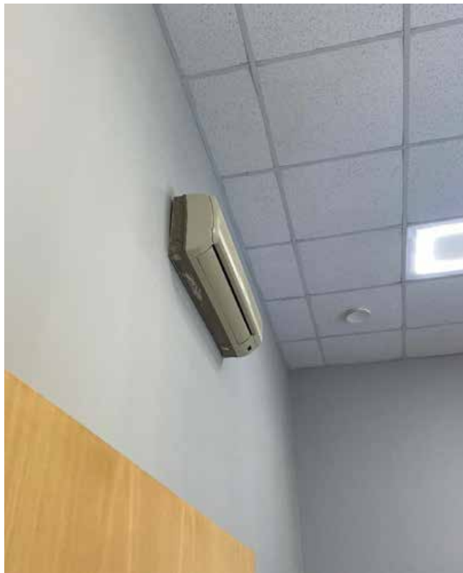
Фото 9, 3 этаж. Внутренний блок кондиционирования
