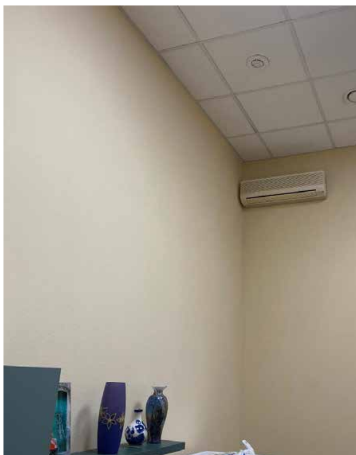
Фото 2, 3 этаж. Внутренний блок кондиционирования
