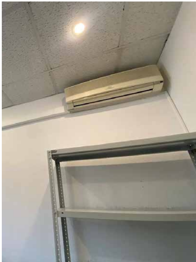
Фото 3, 1 этаж. Внутренний блок кондиционирования
