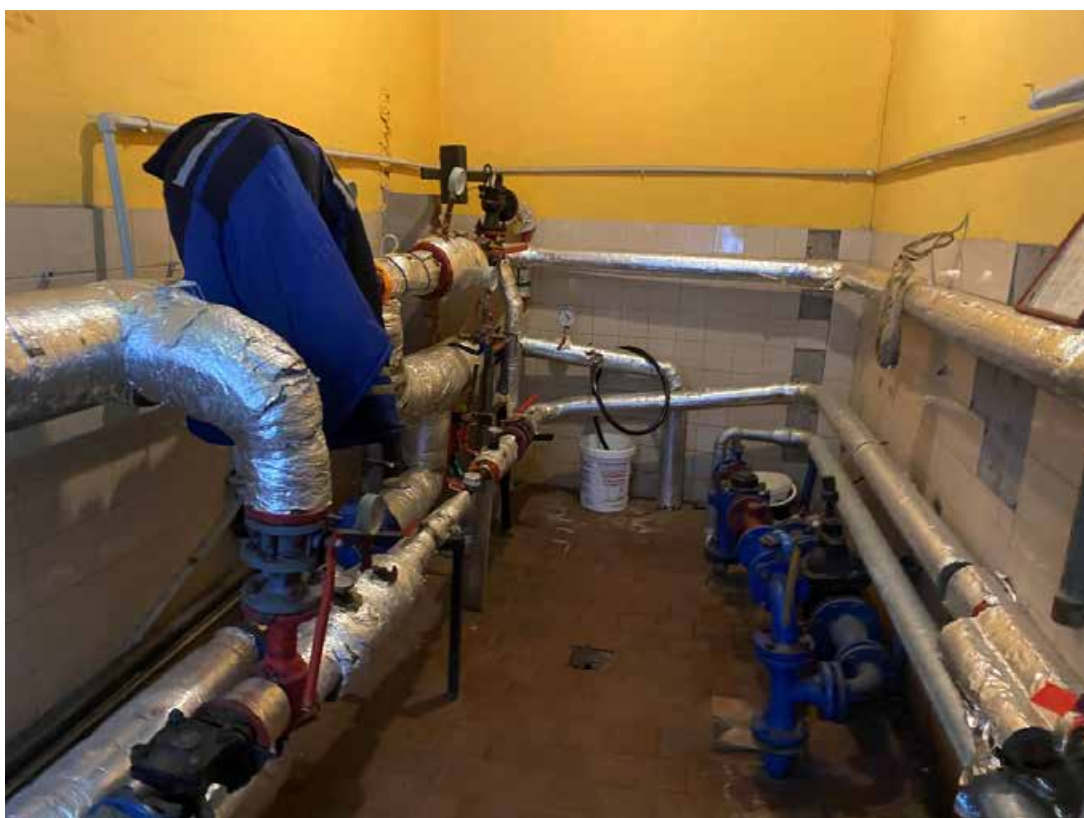
Фото 14, 1 этаж. Общий вид ИТП узла холодного водоснабжения
