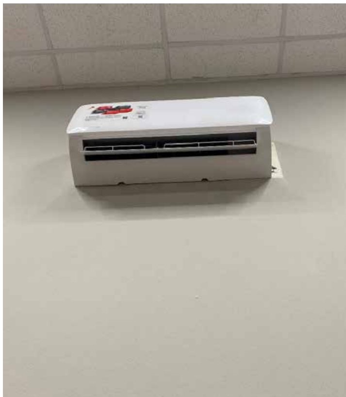
Фото 11, 3 этаж. Внутренний блок кондиционирования
