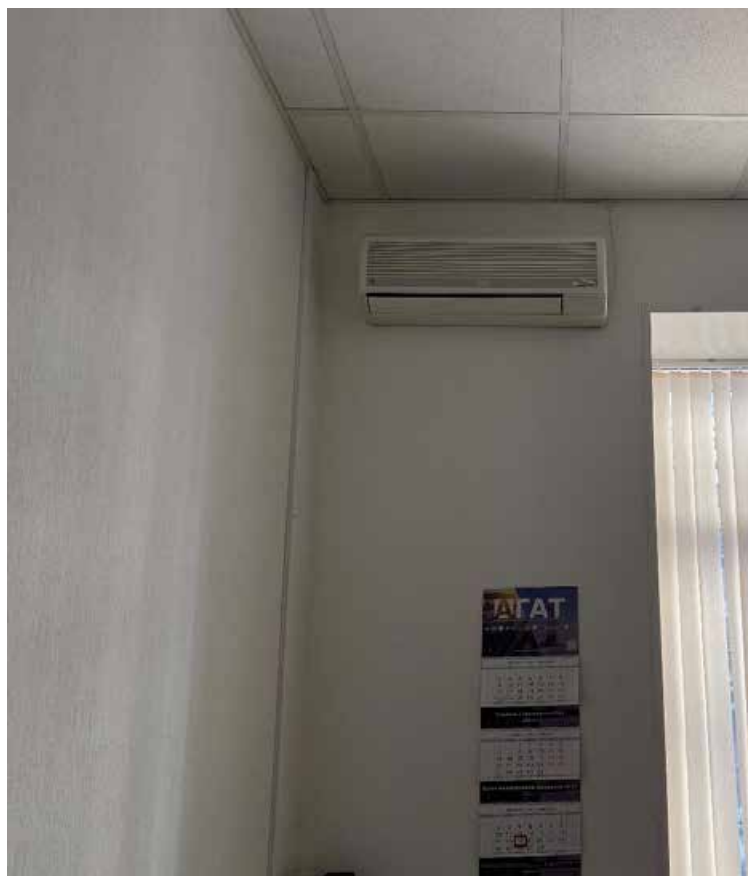
Фото 16, 2 этаж. Внутренний блок кондиционирования
