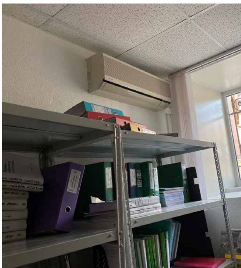
Фото 6, 1 этаж. Внутренний блок кондиционирования
