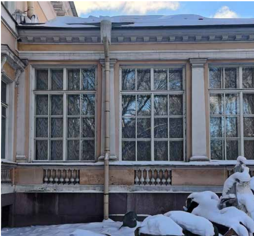
39. «Корпус западный Русского музея» (в составе «Дворец Великого князя Михаила Павловича (Русский музей Императора Александра III)»), г. Санкт-Петербург, Инженерная улица, дом 2-4, литера А. Переходная галерея. Северный фасад. Фрагмент. Фото 02.02.2026г.
