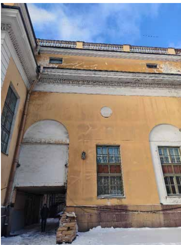
28. «Корпус западный Русского музея» (в составе «Дворец Великого князя Михаила Павловича (Русский музей Императора Александра III)»), г. Санкт-Петербург, Инженерная улица, дом 2-4, литера А. Восточный фасад. Фрагмент. Фото 02.02.2026г.
