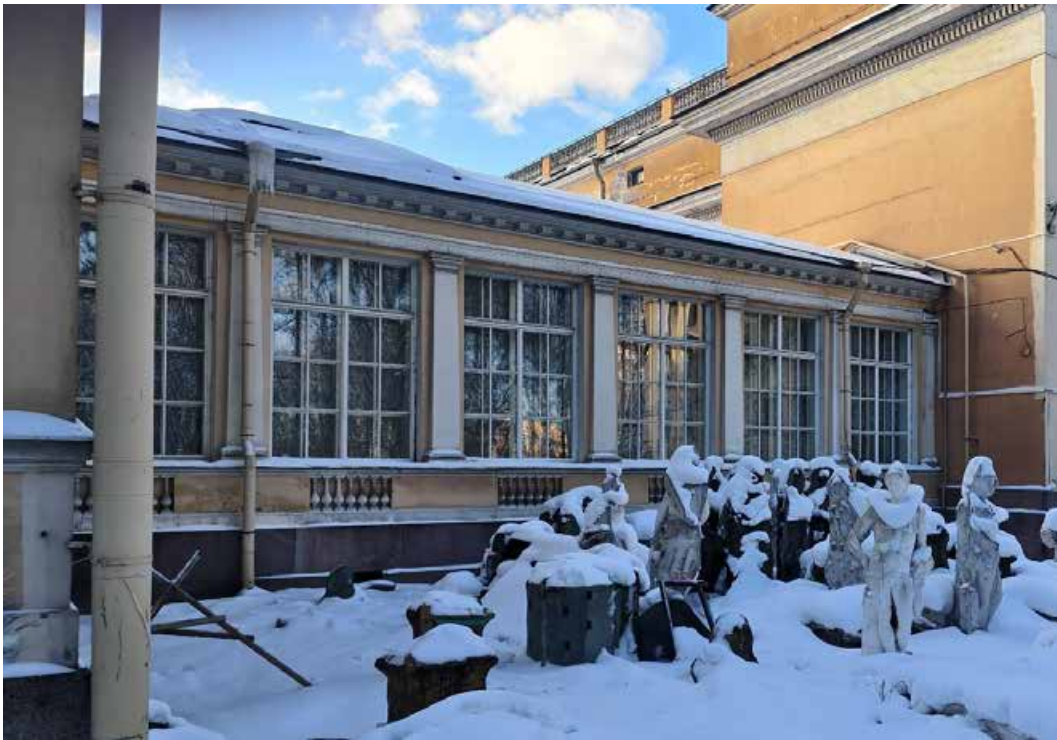
5. «Корпус западный Русского музея» (в составе «Дворец Великого князя Михаила Павловича (Русский музей Императора Александра III)»), г. Санкт-Петербург, Инженерная улица, дом 2-4, литера А. Переходная галерея. Северный фасад. Общий вид. Фото 02.02.2026г.
