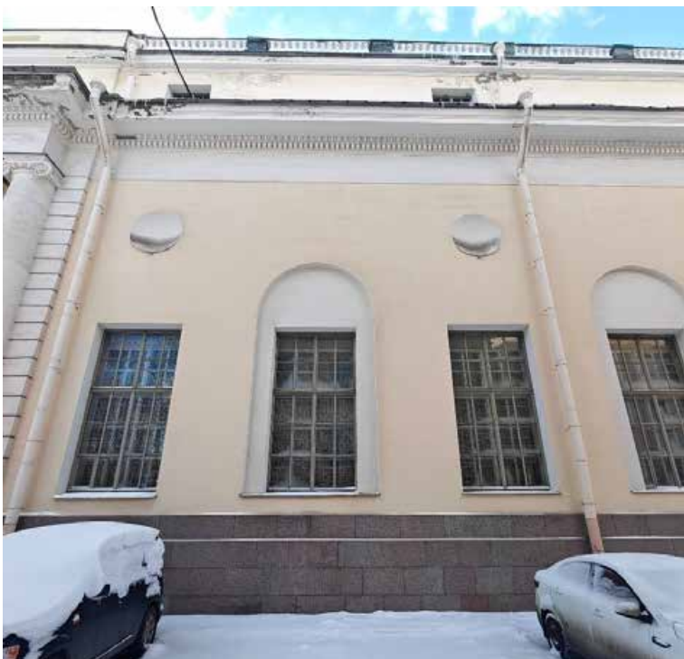
44. «Корпус западный Русского музея» (в составе «Дворец Великого князя Михаила Павловича (Русский музей Императора Александра III)»), г. Санкт-Петербург, Инженерная улица, дом 2-4, литера А. Северный фасад. Фрагмент. Фото 02.02.2026г.
