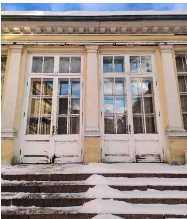
36. «Корпус западный Русского музея» (в составе «Дворец Великого князя Михаила Павловича (Русский музей Императора Александра III)»), г. Санкт-Петербург, Инженерная улица, дом 2-4, литера А. Переходная галерея. Южный фасад. Фрагмент. Фото 02.02.2026г.
