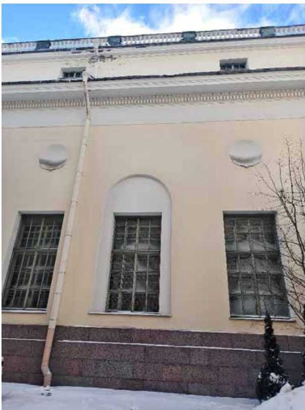
46. «Корпус западный Русского музея» (в составе «Дворец Великого князя Михаила Павловича (Русский музей Императора Александра III)»), г. Санкт-Петербург, Инженерная улица, дом 2-4, литера А. Северный фасад. Фрагмент. Фото 02.02.2026г.
