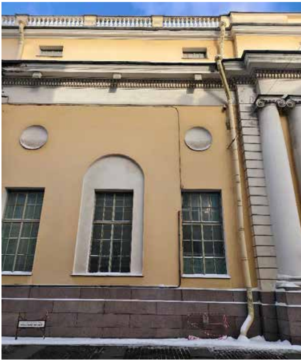
21. «Корпус западный Русского музея» (в составе «Дворец Великого князя Михаила Павловича (Русский музей Императора Александра III)»), г. Санкт-Петербург, Инженерная улица, дом 2-4, литера А. Южный фасад. Фрагмент. Фото 02.02.2026г.
