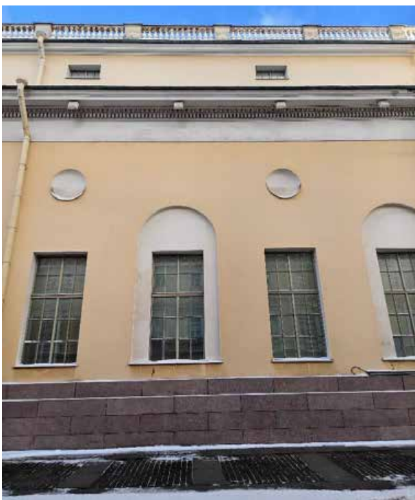
19. «Корпус западный Русского музея» (в составе «Дворец Великого князя Михаила Павловича (Русский музей Императора Александра III)»), г. Санкт-Петербург, Инженерная улица, дом 2-4, литера А. Южный фасад. Фрагмент. Фото 02.02.2026г.
