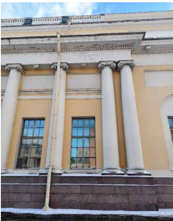
15. «Корпус западный Русского музея» (в составе «Дворец Великого князя Михаила Павловича (Русский музей Императора Александра III)»), г. Санкт-Петербург, Инженерная улица, дом 2-4, литера А. Западный фасад. Фрагмент. Фото 02.02.2026г.
