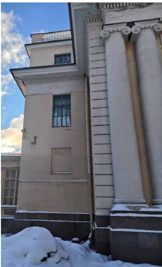
43. «Корпус западный Русского музея» (в составе «Дворец Великого князя Михаила Павловича (Русский музей Императора Александра III)»), г. Санкт-Петербург, Инженерная улица, дом 2-4, литера А. Северный фасад. Фрагмент. Фото 02.02.2026г.
