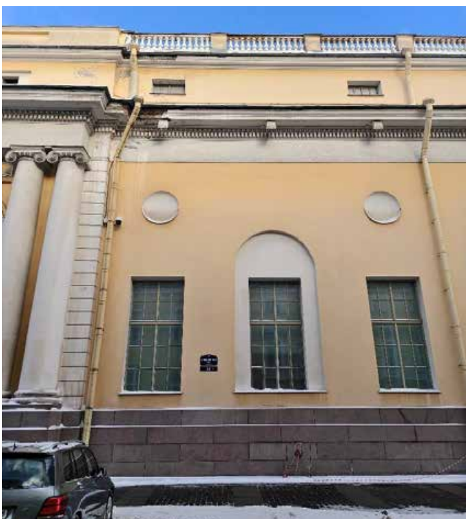
18. «Корпус западный Русского музея» (в составе «Дворец Великого князя Михаила Павловича (Русский музей Императора Александра III)»), г. Санкт-Петербург, Инженерная улица, дом 2-4, литера А. Южный фасад. Фрагмент. Фото 02.02.2026г.
