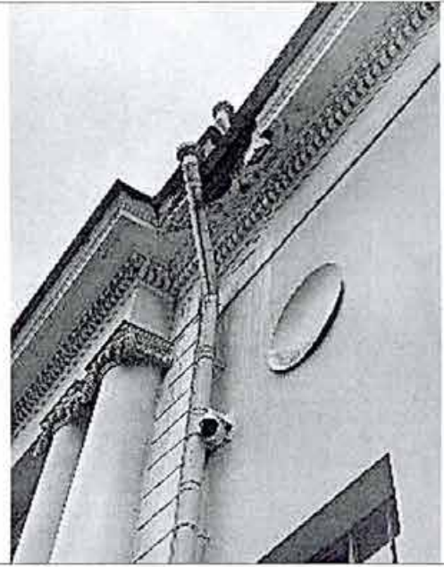
Фото 5. Фрагмент деструкции карнизного свеса (по Инженерной ул.)
