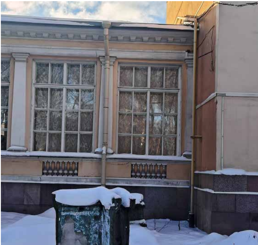
41. «Корпус западный Русского музея» (в составе «Дворец Великого князя Михаила Павловича (Русский музей Императора Александра III)»), г. Санкт-Петербург, Инженерная улица, дом 2-4, литера А. Переходная галерея. Северный фасад. Фрагмент. Фото 02.02.2026г.
