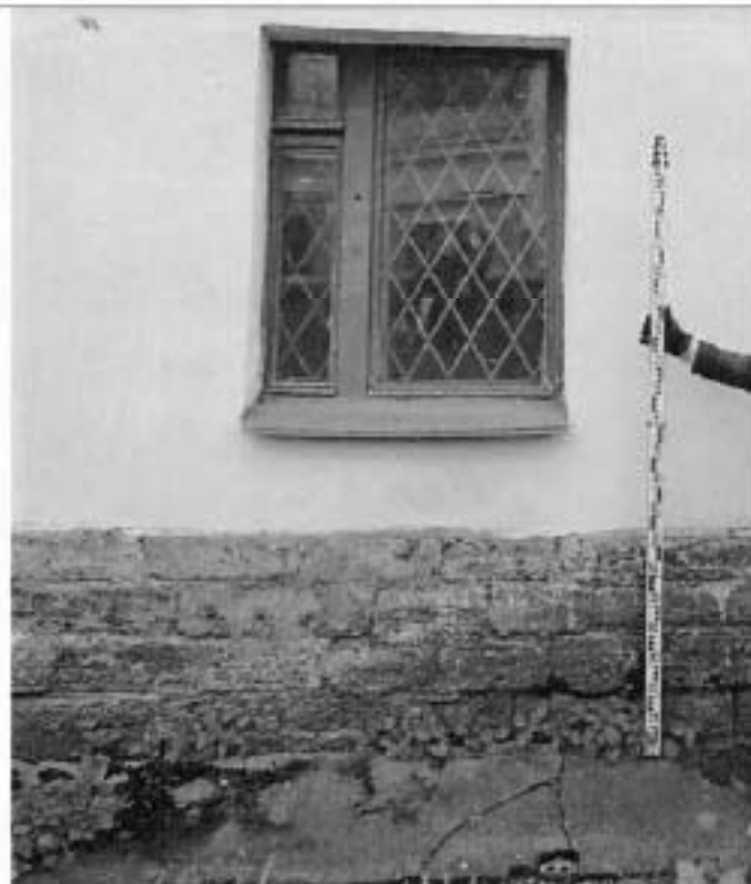
Разрушение отмостки и цоколя. 15.05.2020 г.
