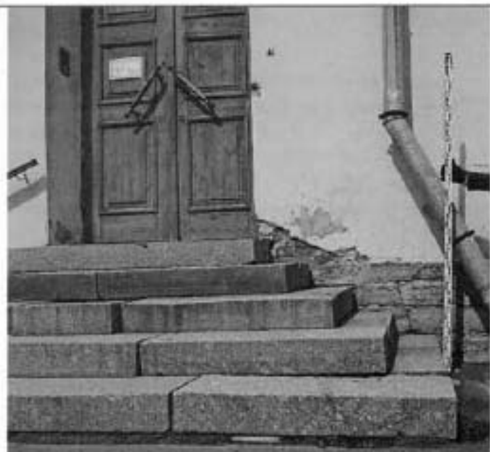
Необходим ремонт входной группы южного фасада. 15.05.2020 г.
