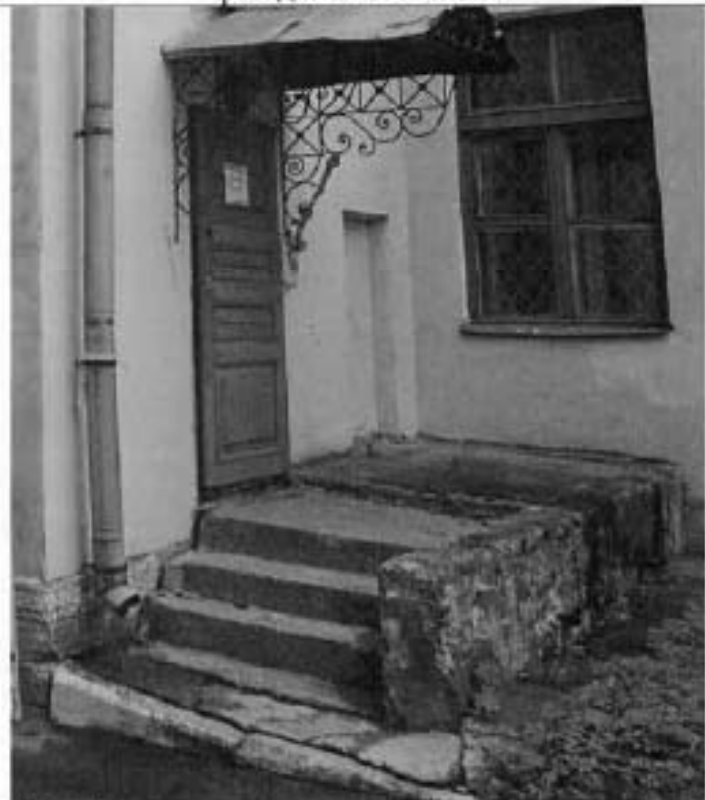
Необходим ремонт входной группы восточного фасада. 15.05.2020 г.
