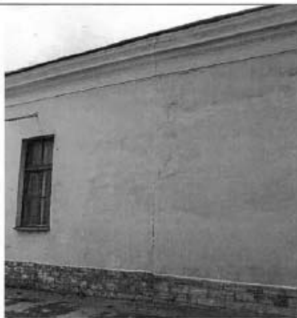
Трещина на западном фасаде. 15.05.2020 г.
