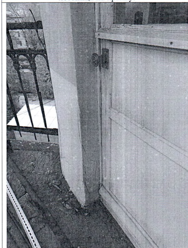
9. Северо-западный фасад. Фрагмент. Дефекты отделки.
