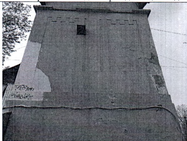
5. Восточный фасад. Фрагмент. Дефекты отделки.
