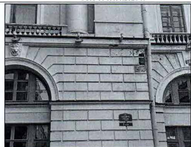
12. Локальные отслоения, утраты штукатурного и окрасочных слоев до кирпича со стороны северного фасада. Фото от 09.11.2021 г.
