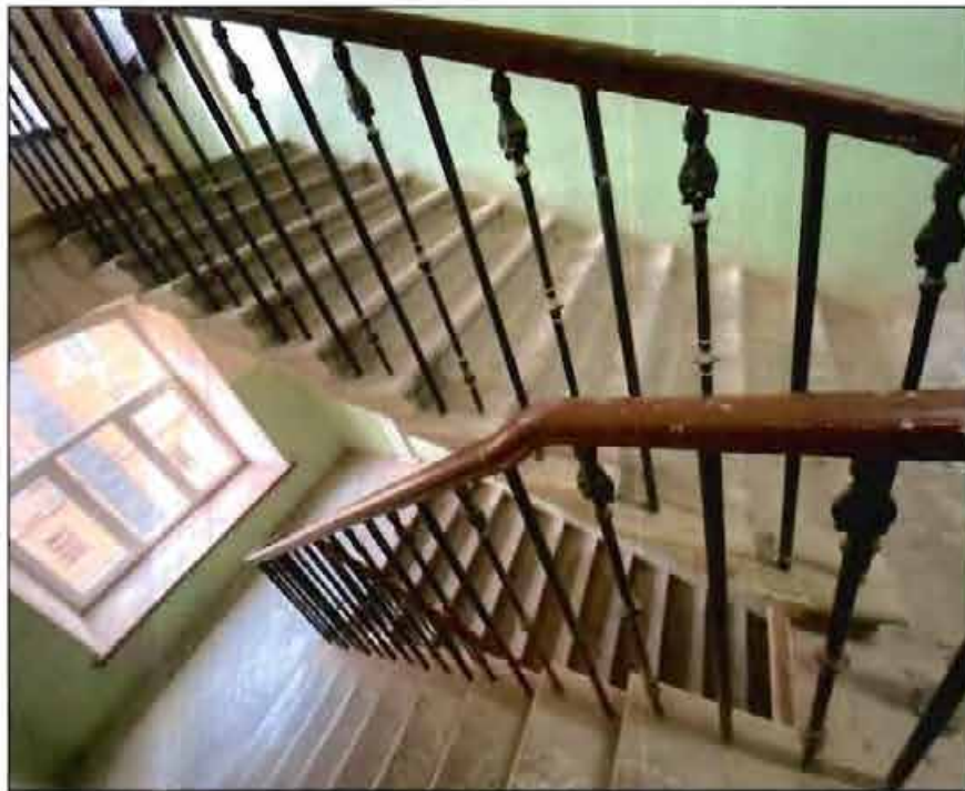
37. Двухмаршевые служебные лестницы (IIJK). Сколы ступеней, истертости в ходовых местах, утраты металлических стоек ограждений. Фото от 16.11.2021 г.
