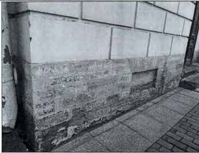
13. Локальная деструкция известнякового цоколя, сколы, следы намокания, биопоражения со стороны северного фасада. Фото от 09.11.2021 г.
