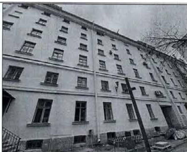
20. Западный дворовый фасад. Дополнительное инженерное оборудование на фасаде. Фото от 09.11.2021 г.
