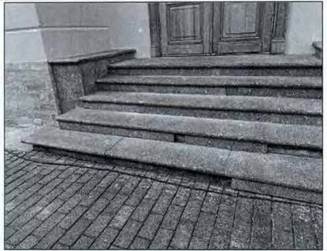
14. Локальные утраты гранитных облицовочных плит на лестнице со стороны западного фасада. Фото от 09.11.2021 г.
