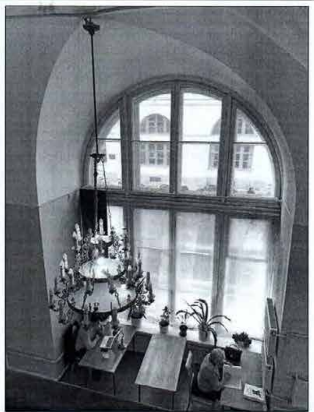
69. Оконный проем в уровне антресоли пом. 38-Н(38, 39). Биопоражения, рассыхание древесины. Фото от 09.11.2021 г.
