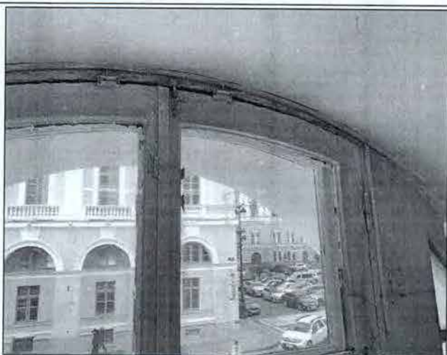
66. Оконный проем в уровне антресоли пом. 38-Н(50). Биопоражения, рассыхание древесины. Фото от 09.11.2021 г.
