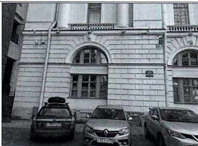
11. Локальные отслоения, утраты штукатурного и окрасочных слоев до кирпича со стороны северного фасада. Фото от 09.11.2021 г.
