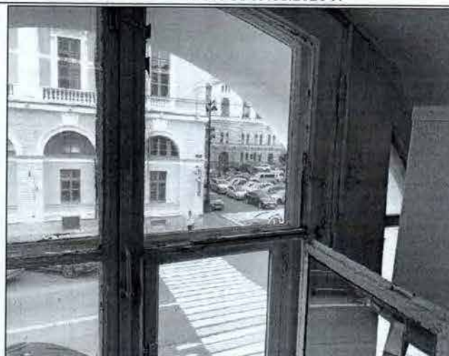
67. Оконный проем в уровне антресоли пом. 38-Н(50). Биопоражения, рассыхание древесины. Фото от 09.11.2021 г.
