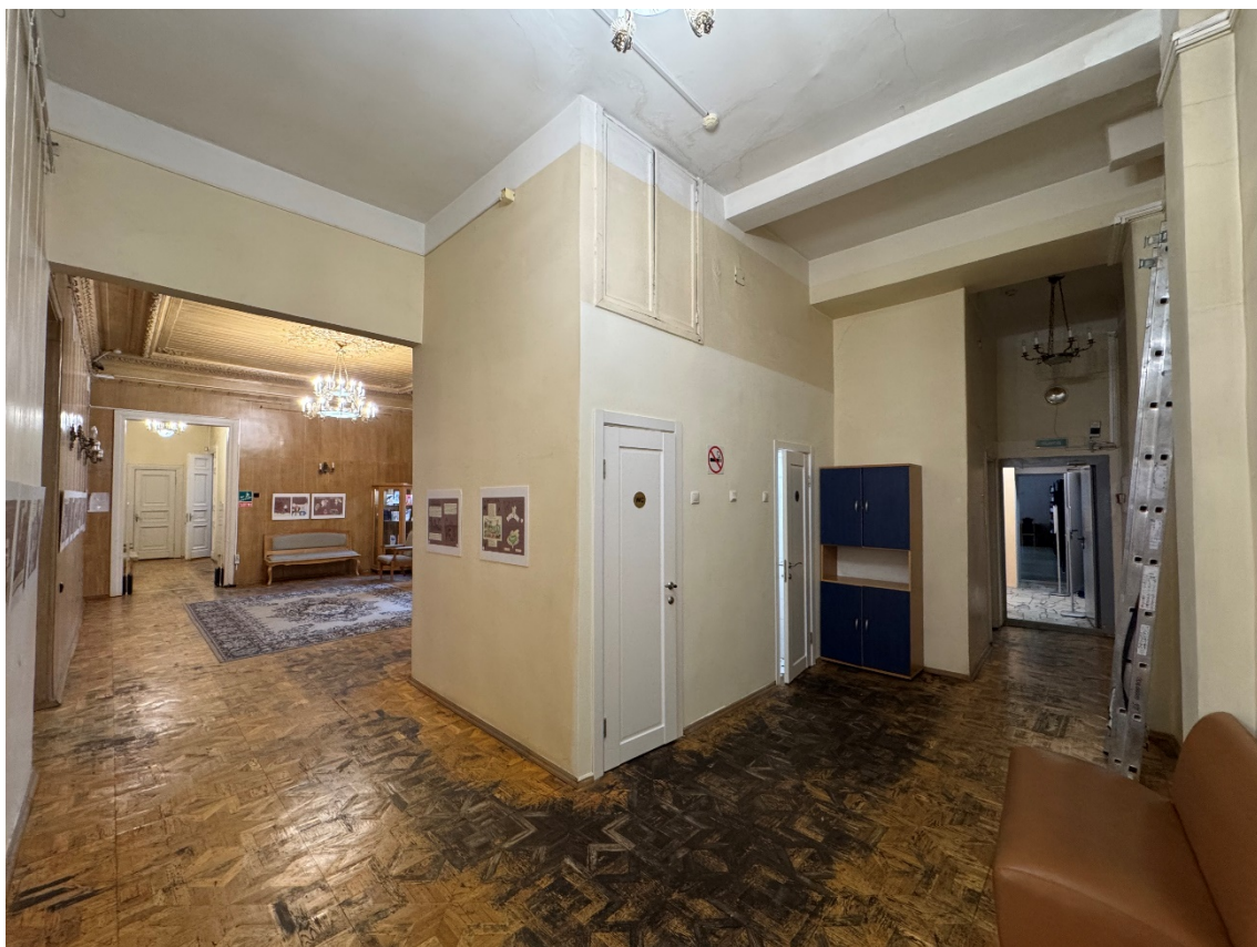
32.Выявленный объект культурного наследия «Особняк А.И. Новинского», расположенный по адресу: г. Санкт-Петербург, 3-я Советская улица, дом 8, литера А. Фрагмент пом. 3-Н (7) в уровне 2-го этажа.
