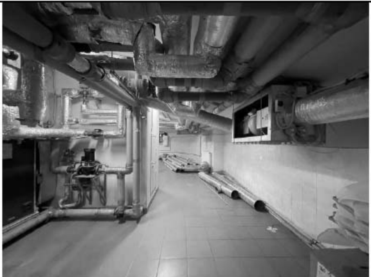
Фото 6.109 Техническое помещение (ч.п.246)
