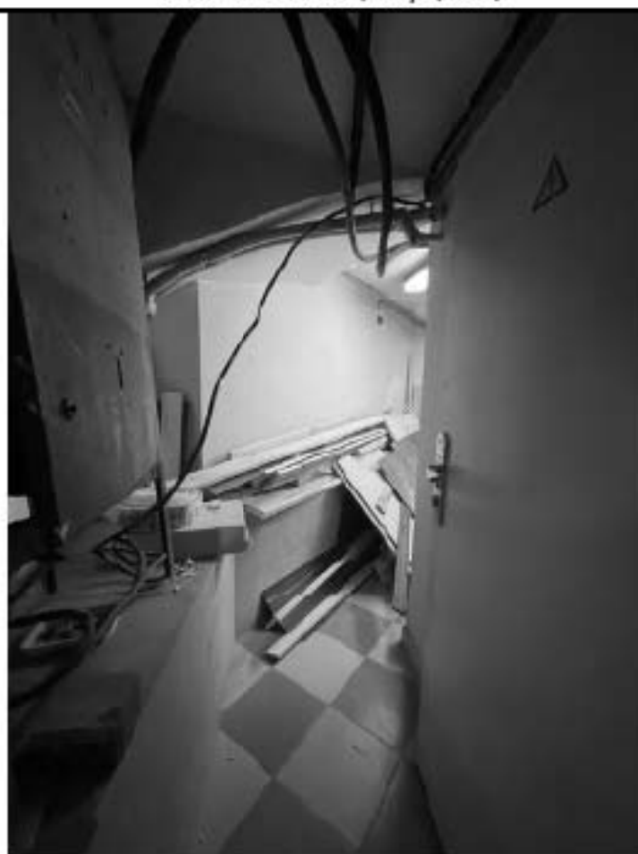
Фото 1.81 Техническое помещение (ч.п.4)
