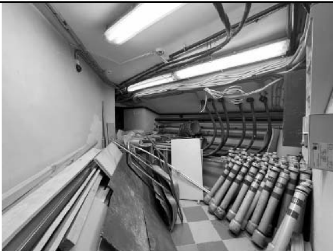
Фото 1.82 Техническое помещение (ч.п.4)
