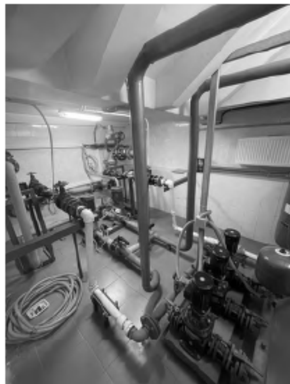
Фото 1.2 Водомерный узел (ч.п.46)
