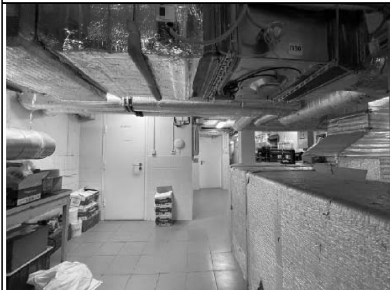
Фото 7.7 Техническое помещение (ч.п.289)
