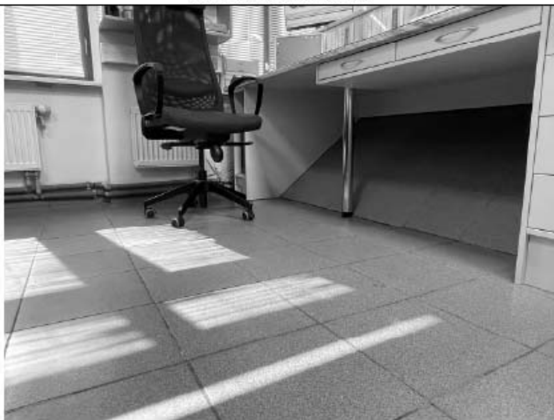
Фото 2.13 Кабинет (ч.п.59) Существующий выступ конструкции перекрытия над входом в Коридор (ч.п.44)
