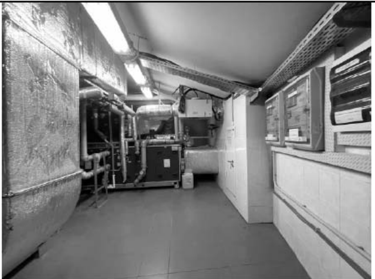
Фото 6.111 Техническое помещение (ч.п.246)
