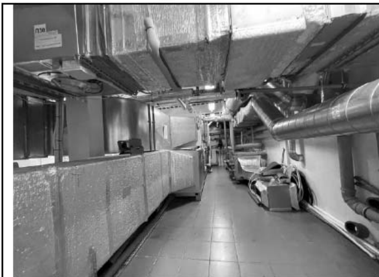
Фото 7.8 Техническое помещение (ч.п.289)
