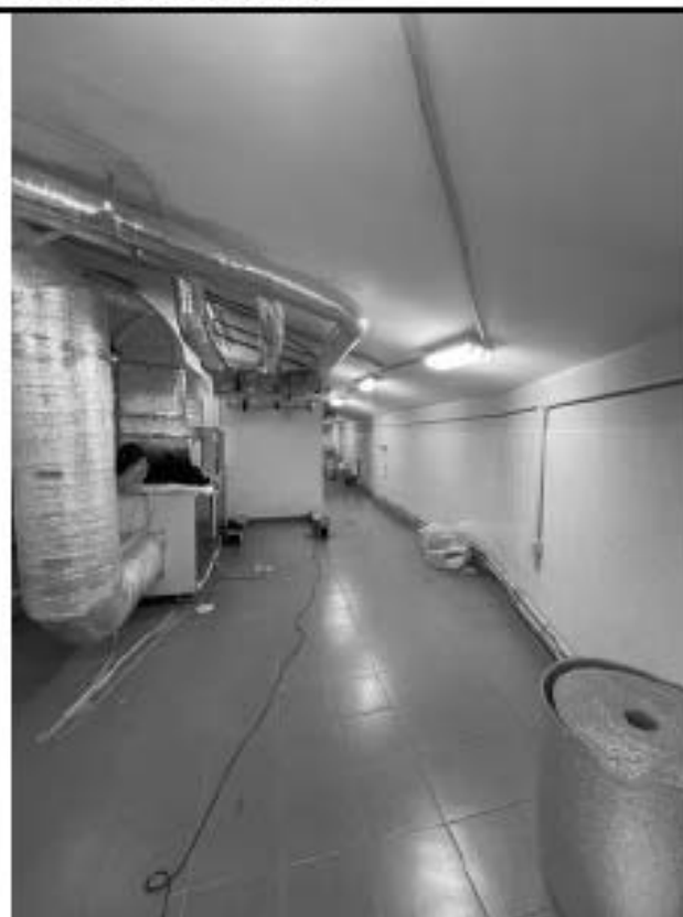
Фото 6.123 Техническое помещение (ч.п.250)
