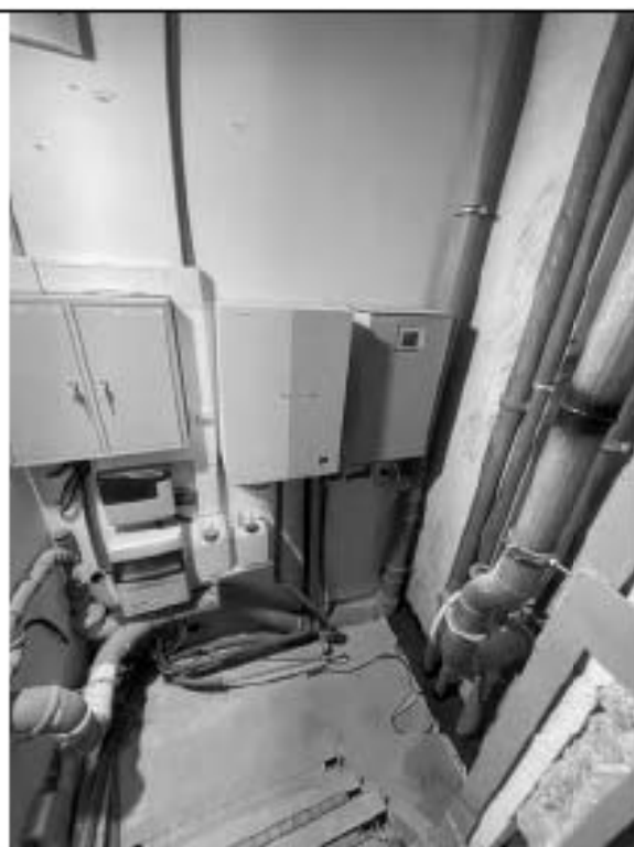
Фото 6.103 Техническое помещение (ч.п.247)
