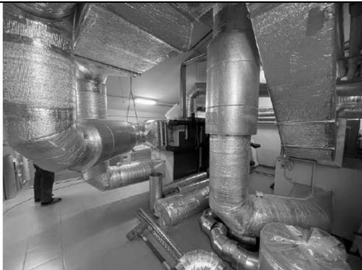
Фото 6.121 Техническое помещение (ч.п.250)
