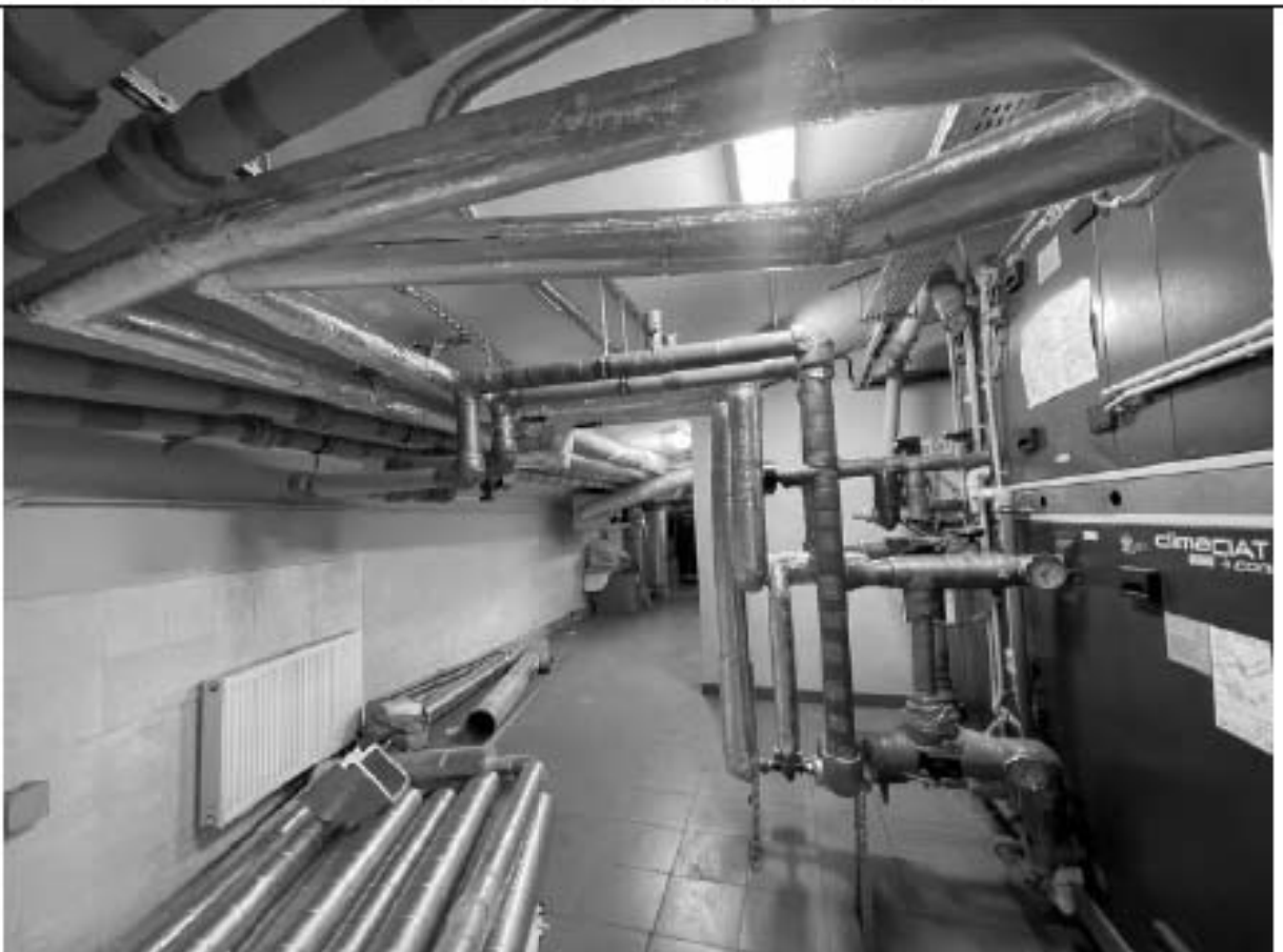
Фото 6.112 Техническое помещение (ч.п.246)
