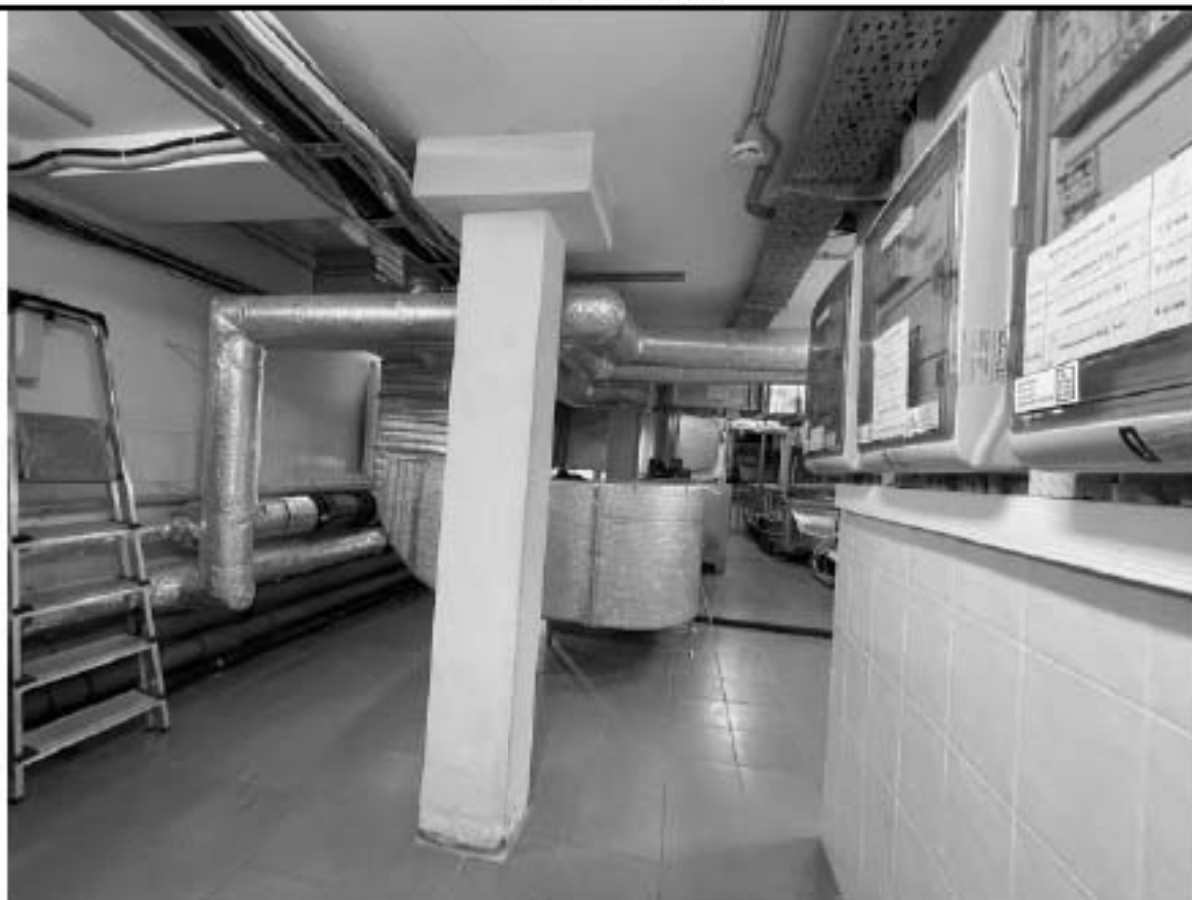
Фото 7.1 Техническое помещение (ч.п.289)
