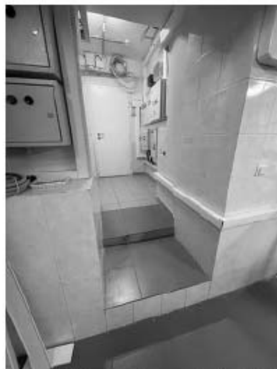
Фото 1.3 Водомерный узел (ч.п.46). Вид в сторону Тамбура (ч.п.45)
