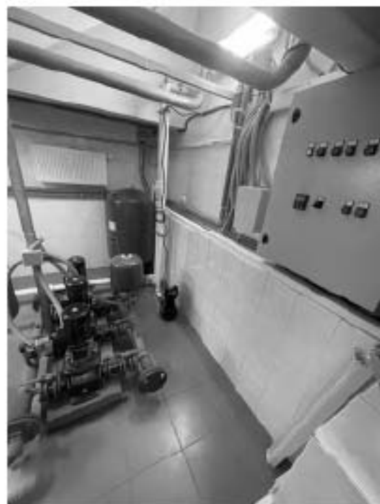
Фото 1.4 Водомерный узел (ч.п.46)
