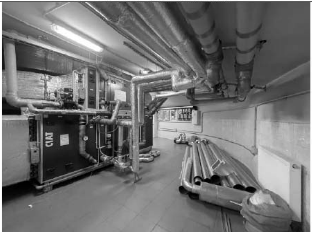
Фото 6.110 Техническое помещение (ч.п.246)
