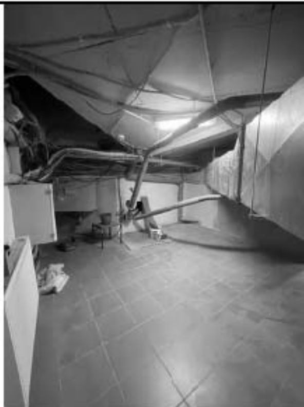
Фото 6.105 Техническое помещение (ч.п.246)
