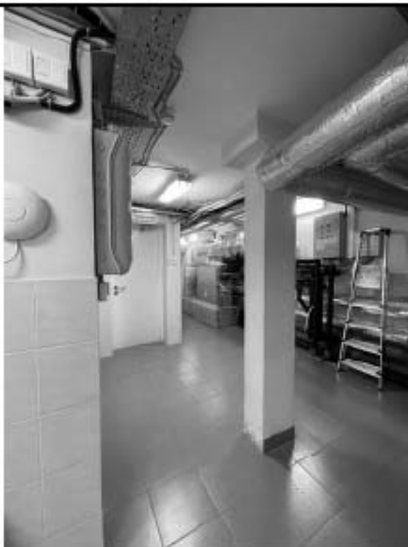
Фото 7.2 Техническое помещение (ч.п.289)
