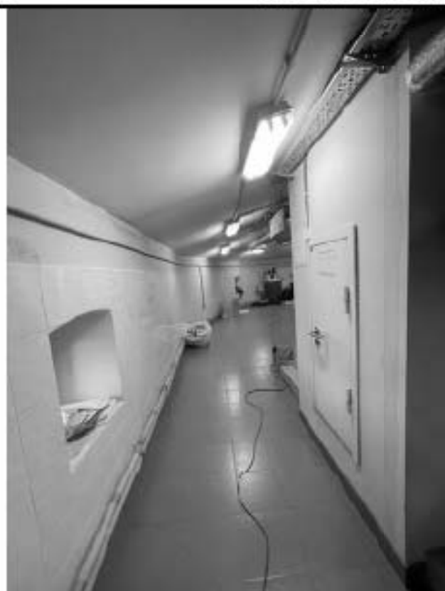
Фото 6.122 Техническое помещение (ч.п.250)
