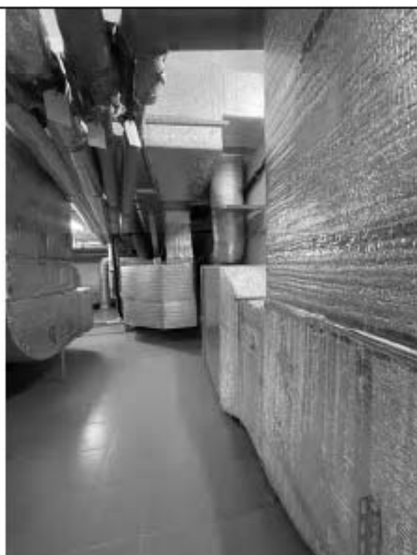
Фото 6.107 Техническое помещение (ч.п.246)
