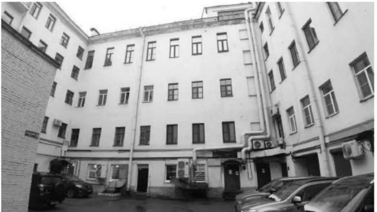
9. «Дом Котомина К.Б.» (Невский пр., д. 18, лит. А). Дворовые фасады. Фото мест установки оборудования и прокладки кабельных трасс. Штиглиц М.С. 15.11.2025 г.
