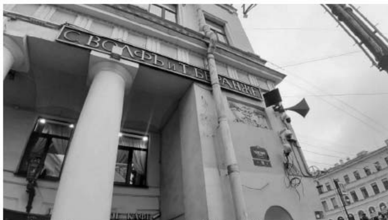
6. «Дом Котомина К.Б.» (Невский пр., д. 18, лит. А). Лицевой фасад по Невскому пр. (фрагмент). Фото мест установки оборудования и прокладки кабельных трасс. Штиглиц М.С. 15.11.2025 г.
