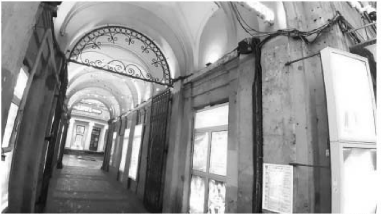
15. «Дом Глазуновых» (Невский пр., д. 60, лит. А). Арочный пр. Фото мест установки оборудования и прокладки кабельных трасс. Штиглиц М.С. 15.11.2025 г.
