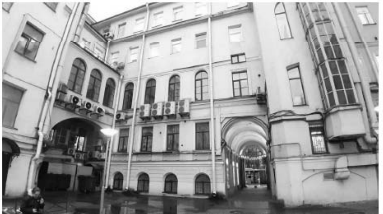
14. «Дом Глазуновъ» (Невский пр., д. 60, лит. А). Дворовые фасады. Фото мест установки оборудования и прокладки кабельных трасс. Штиглиц М.С. 15.11.2025 г.
