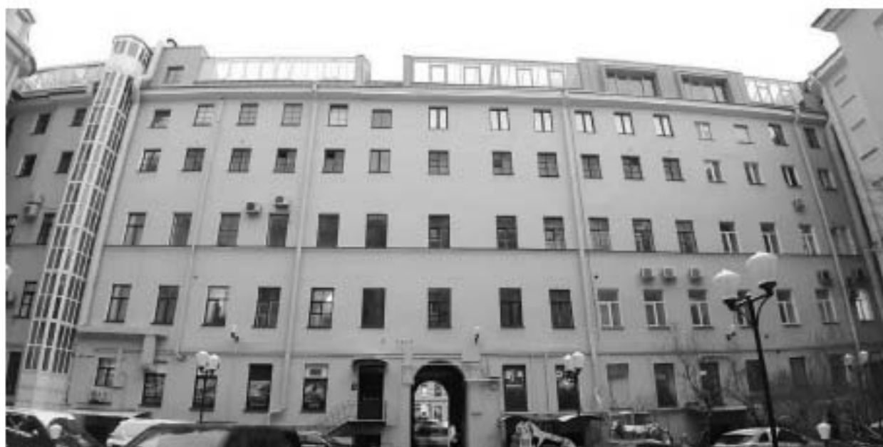
27. «Дом О.П. Кушелевой» (Невский пр., д. 88, лит. А). Дворовые фасады. Фото мест установки оборудования и прокладки кабельных трасс. Штиглиц М.С. 15.11.2025 г.
