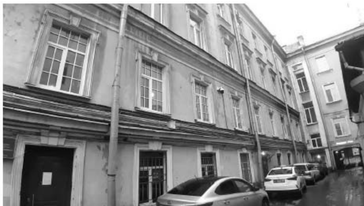
34. «Каменные ворота, помещение для охраны, два флигеля» (в составе «Особняк Кочубея В.П. (комплекс зданий Министерства внутренних дел)») (Пестеля ул., д. 9, лит. В). Дворовые фасады. Фото мест установки оборудования и прокладки кабельных трасс. Штиглиц М.С. 10.11.2025 г.
