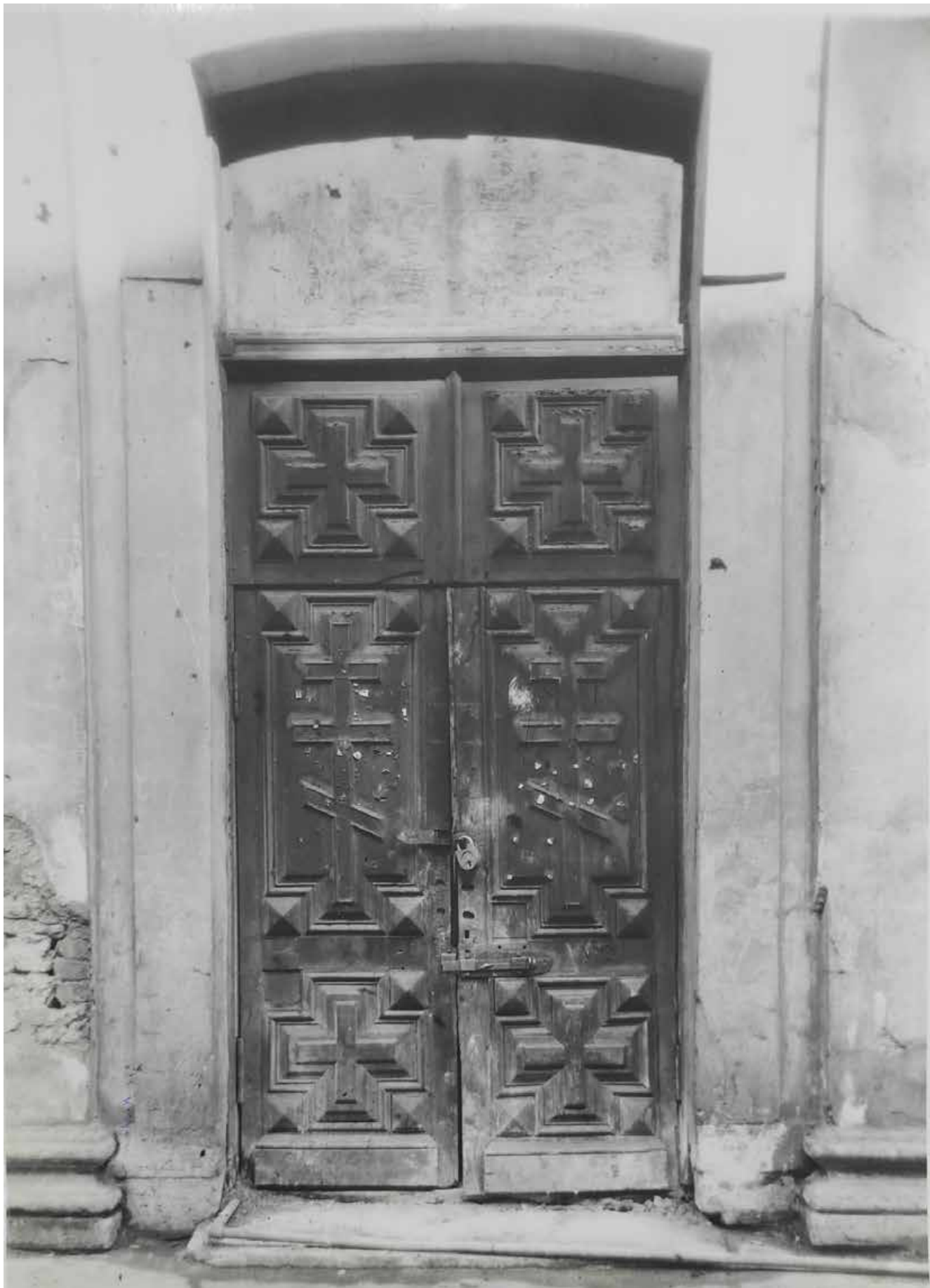
43. Двери на южном фасаде до реставрации, 1958 г. ЦГАНТД СПб. Ф. 488 Оп. 3-24 Д. 709
