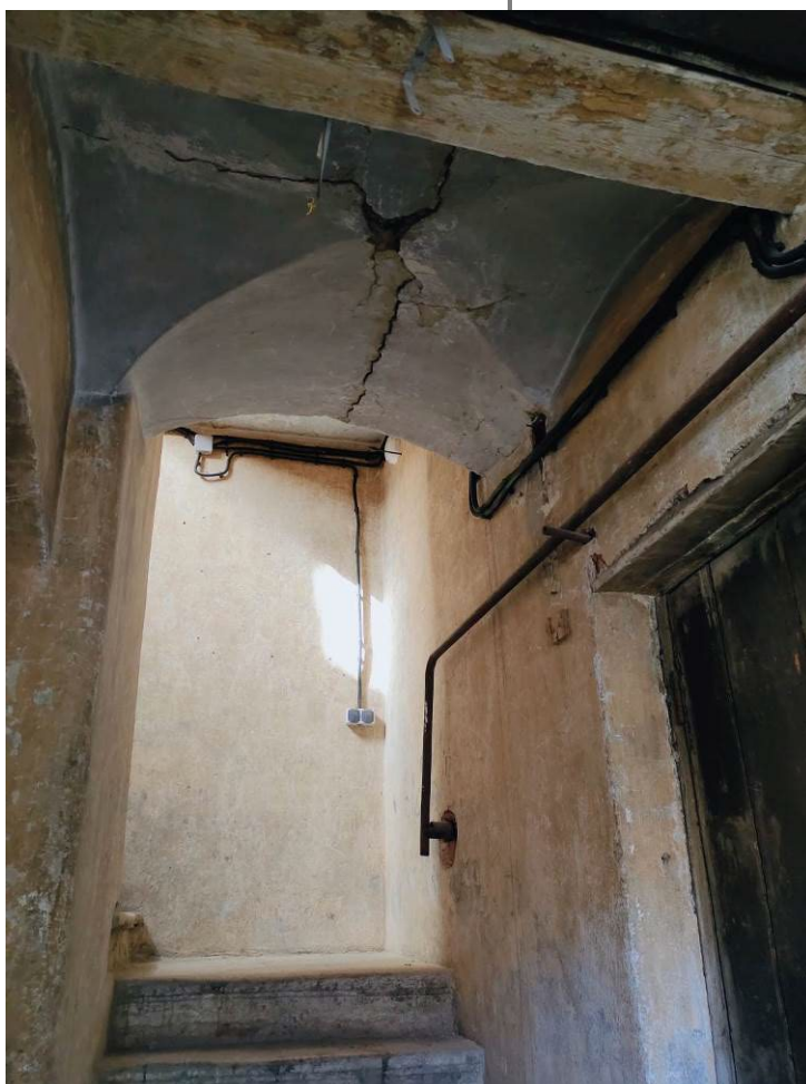
34. Выявленный объект культурного наследия «Дом Альбрехта» ( г. Санкт-Петербург, Центральный район, Правды ул., 1; Разъезжая ул., 11). Черная лестница. Л-5
