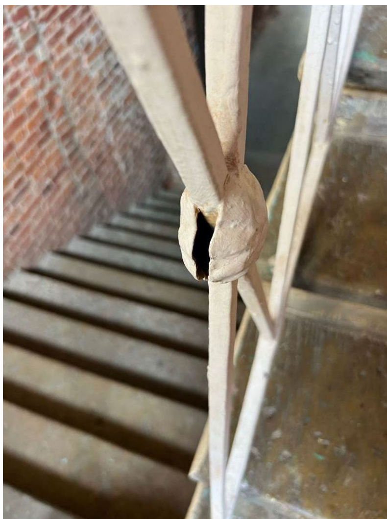
18. Выявленный объект культурного наследия «Дом Альбрехта» ( г. Санкт-Петербург, Центральный район, Правды ул., 1; Разъезжая ул., 11) Парадная лестница. Л-4
