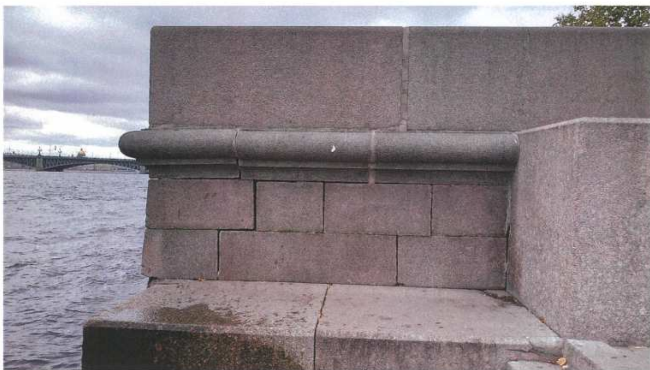
3. Утрата шовного заполнения между гранитными элементами пристани
