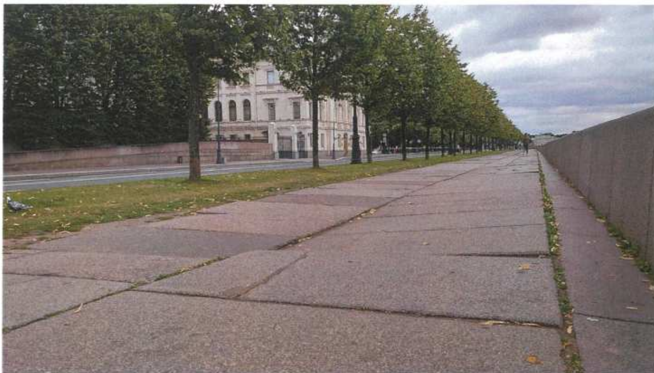
3. Нарушение геометрии гранитного настила набережной
