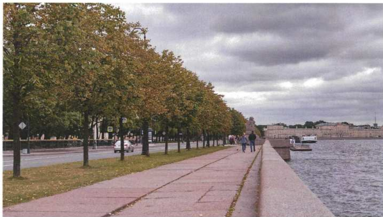
4. Нарушение геометрии ограждения набережной
