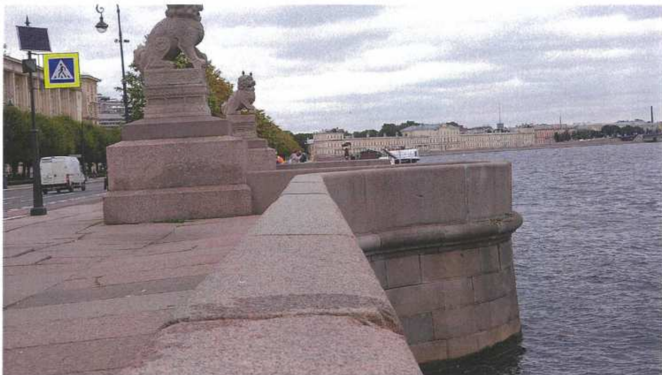
2. Просадка гранитного пастила на прилегающей территории
