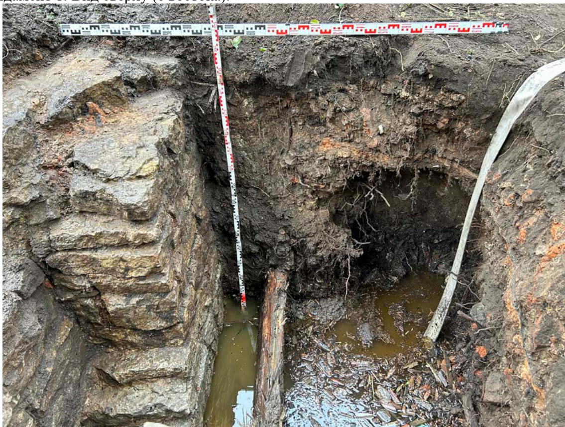
Илл. 42. Санкт-Петербург, набережная Крюкова канала, д. 20-22, литера А. Шурф 1, затопленный грунтовыми водами после откачки. Обрушенный северный борт. Вид с юга.
