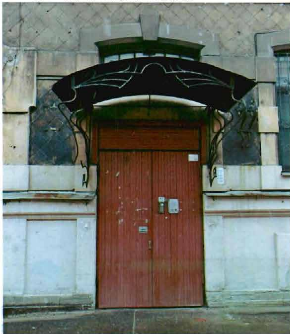
3. Фасад по переулку Макаренко 10. Козырек.
