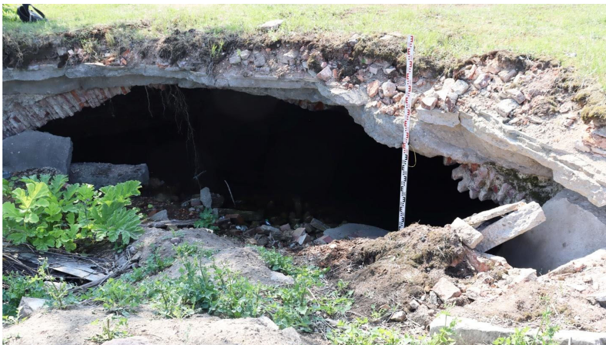
Рис. 30. Церковь Смоленской Божьей матери. Вид с северо-востока на пролом в центральной части пола церкви. (Из Отчёта Фурасьева А.Г., 2023 г.)
