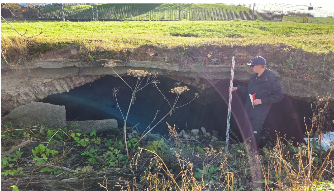
Рис. 37. Церковь Смоленской Божьей матери. Частично обрушенный подвал («подцерковье») храма с арочными кирпичными сводами. Вид с севера. Фотофиксация 2025 г.
