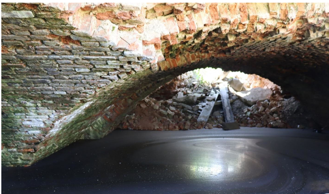
Рис. 31. Церковь Смоленской Божьей матери. Вид сквозь пролом на своды подцерковья в центральной части храма. (Из Отчёта Фурасьева А.Г., 2023 г.)
