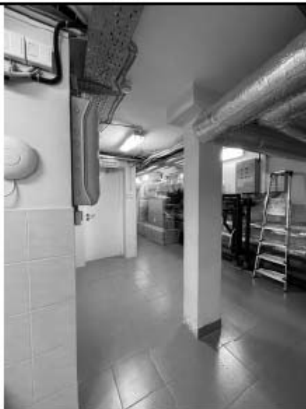
Фото 7.2 Техническое помещение (ч.п.289)
