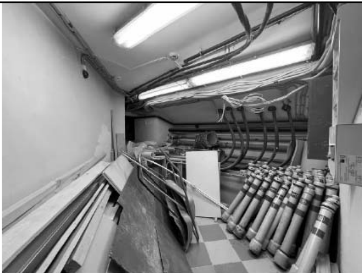
Фото 1.82 Техническое помещение (ч.п.4)
