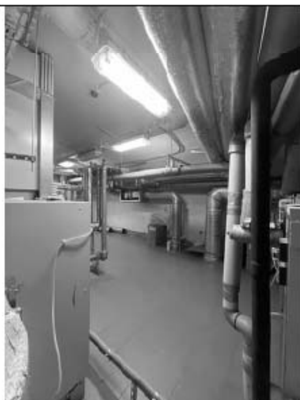
Фото 6.108 Техническое помещение (ч.п.246)
