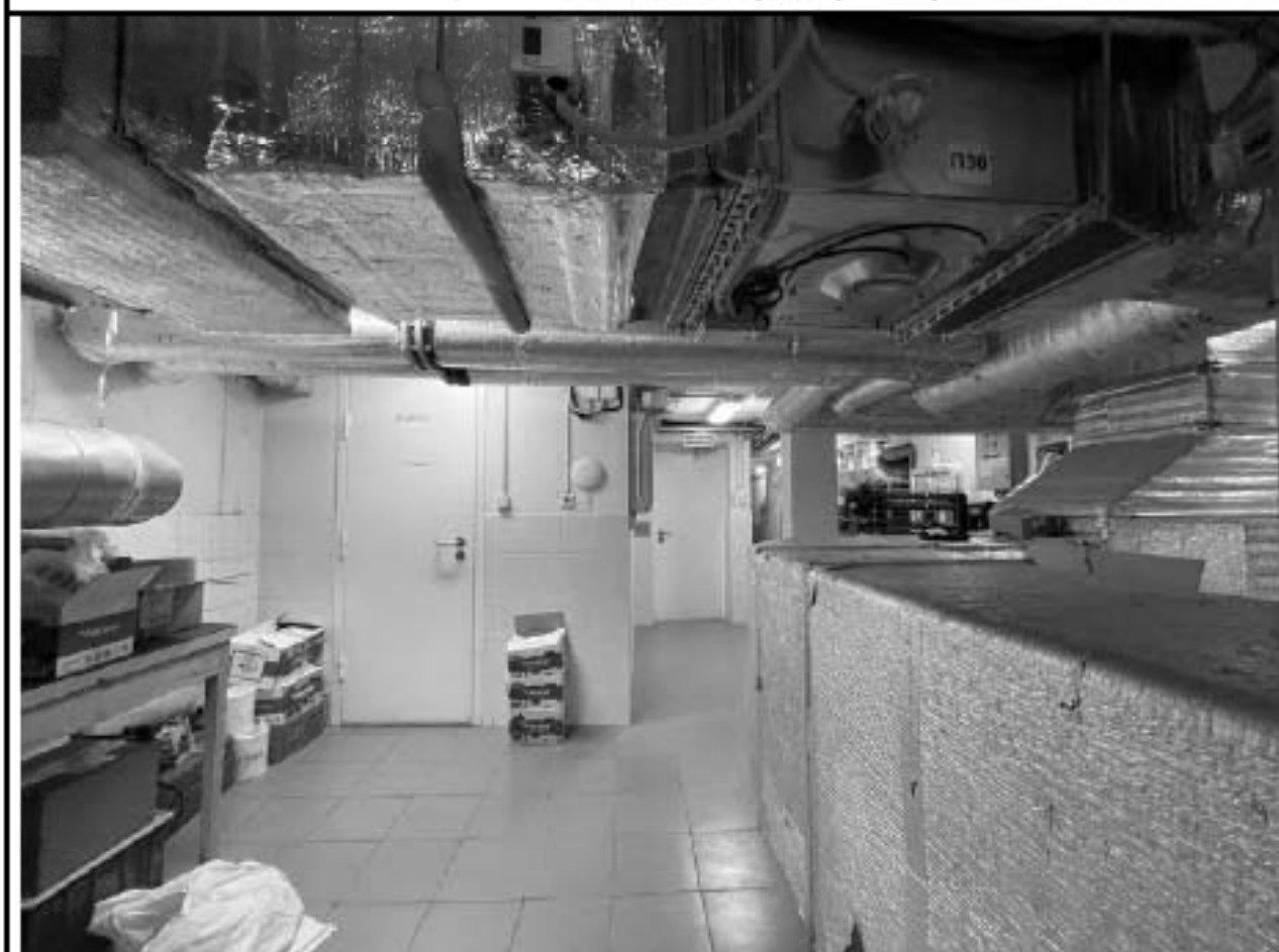
Фото 7.7 Техническое помещение (ч.п.289)
