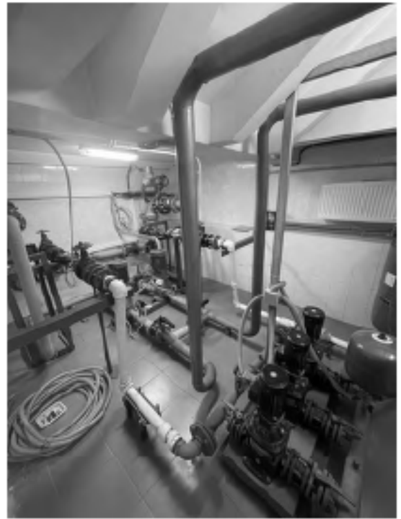
Фото 1.2 Водомерный узел (ч.п.46)
