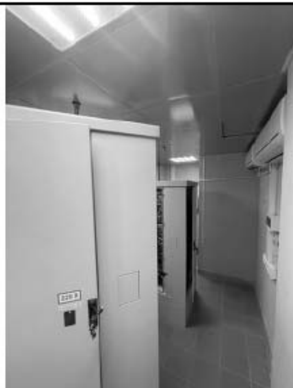
Фото 6.119 Техническое помещение (ч.п.252)
