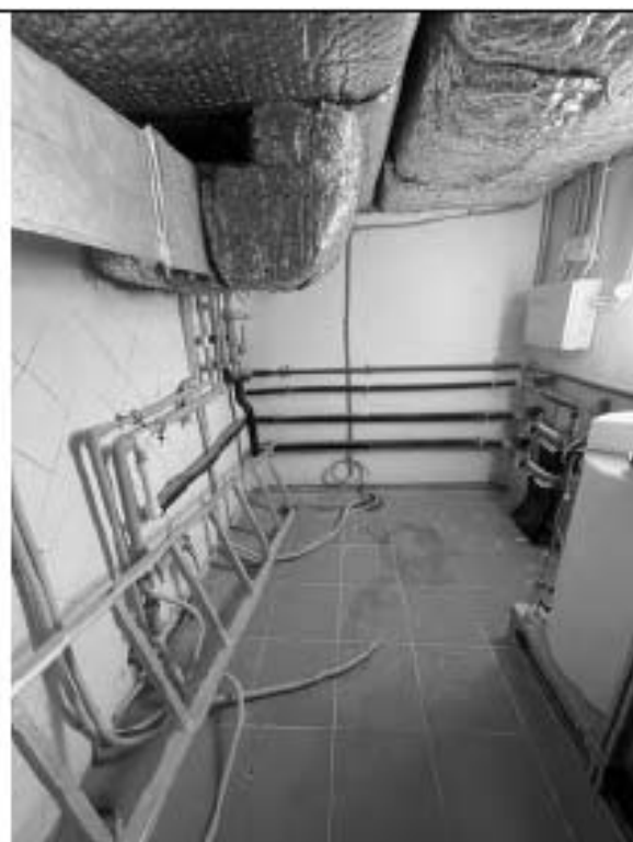
Фото 6.104 Техническое помещение (ч.п.246)
