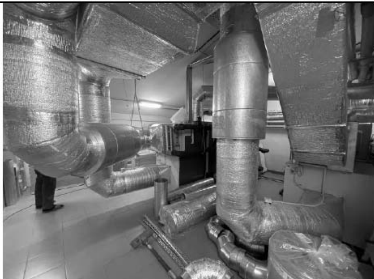
Фото 6.121 Техническое помещение (ч.п.250)
