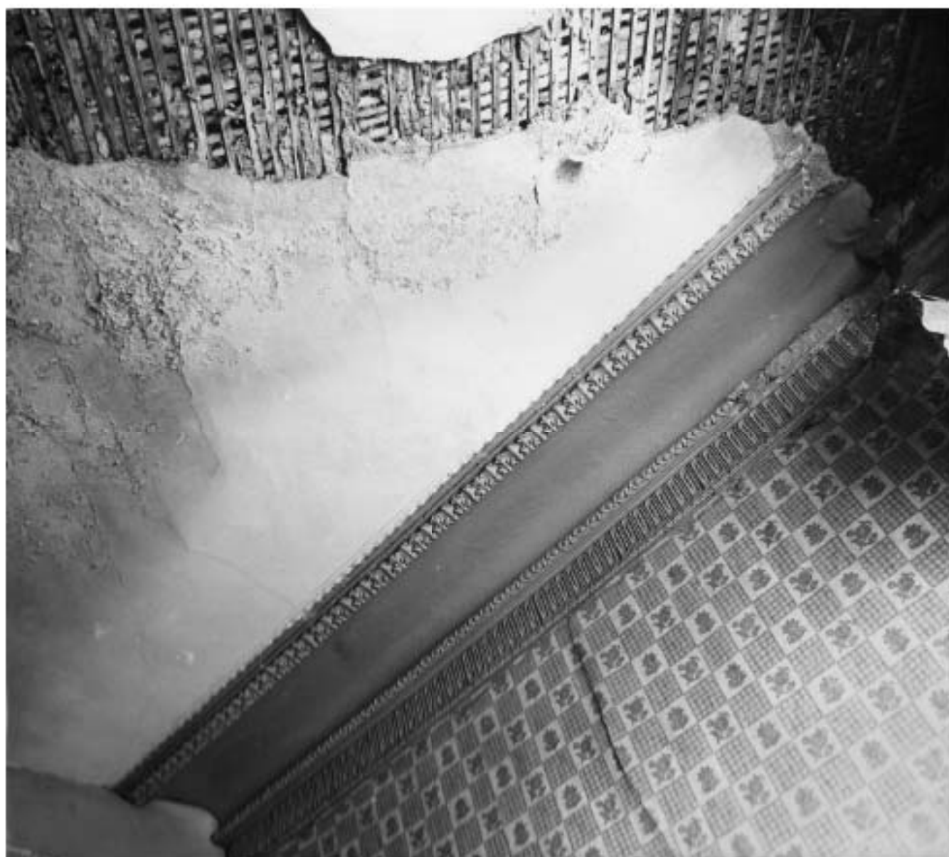
Ил. 95. Дом И.О. Утина. 1857 г. Арх. Р. Кузьмин. Конногвардейский бульвар, 17. Помещение 3-го эт. Лепной карниз. Фрагмент. 1990 г. Фото С.А. Шмидт. Архив КГИОП, шифр 292/7
