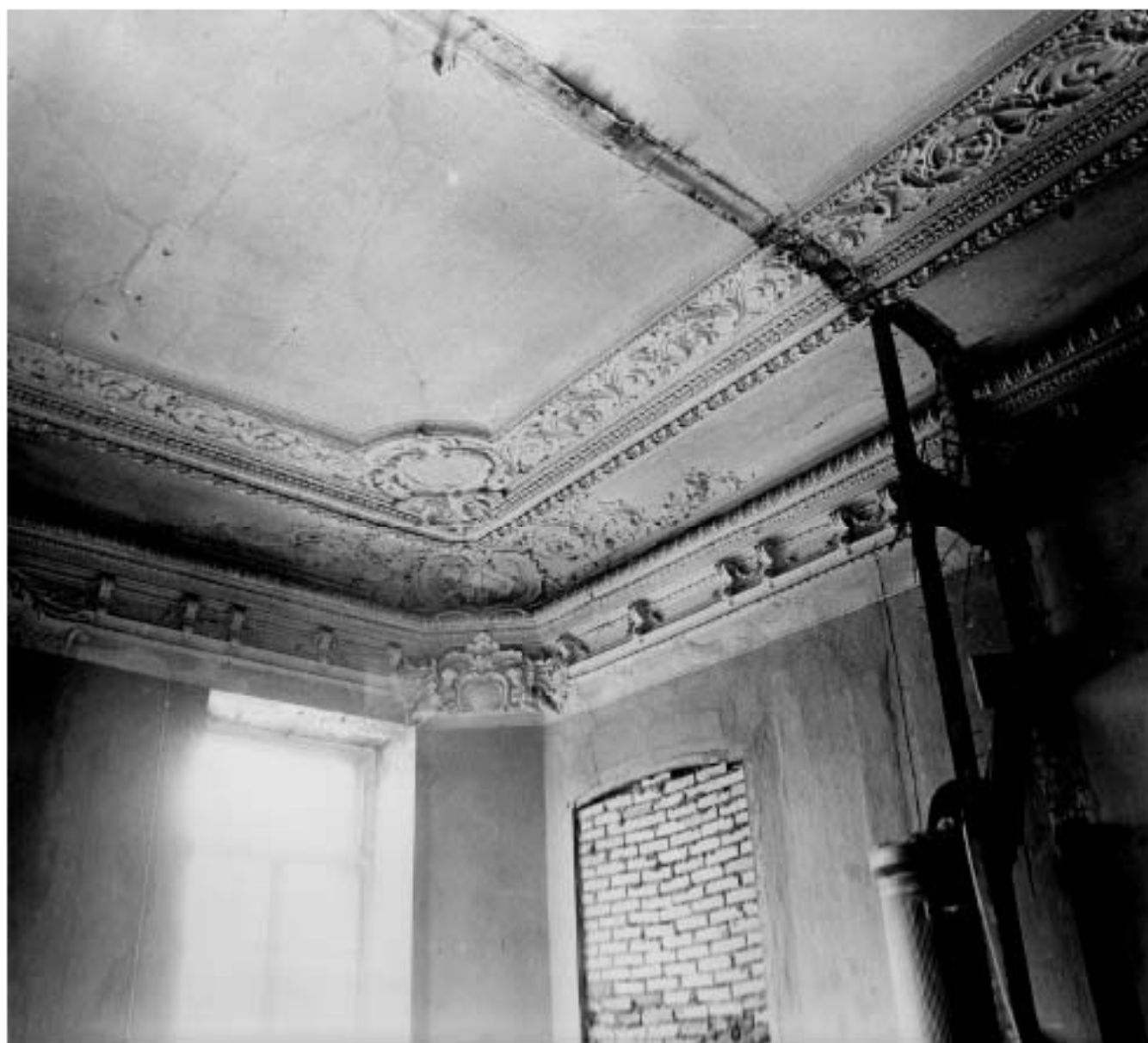
Ил. 98. Дом И.О. Утина. 1857 г. Арх. Р. Кузьмин. Конногвардейский бульвар, 17. Помещение 2-го эт. Фрагмент лепки потолка. 1990 г. Фото С.А. Шмидт. Архив КГИОП, шифр 292/11
