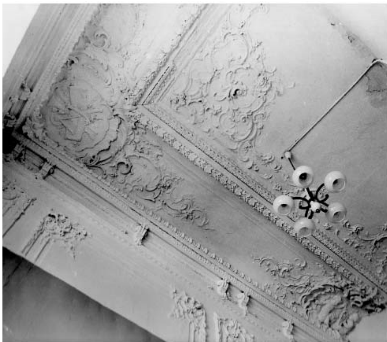
Ил. 92. Дом И.О. Утина. 1857 г. Арх. Р. Кузьмин. Конногвардейский бульвар, 17. Помещение 2-го эт. Лепка плафона. Фрагмент. 1990 г. Фото С.А. Шмидт. Архив КГИОП, шифр 292/3
