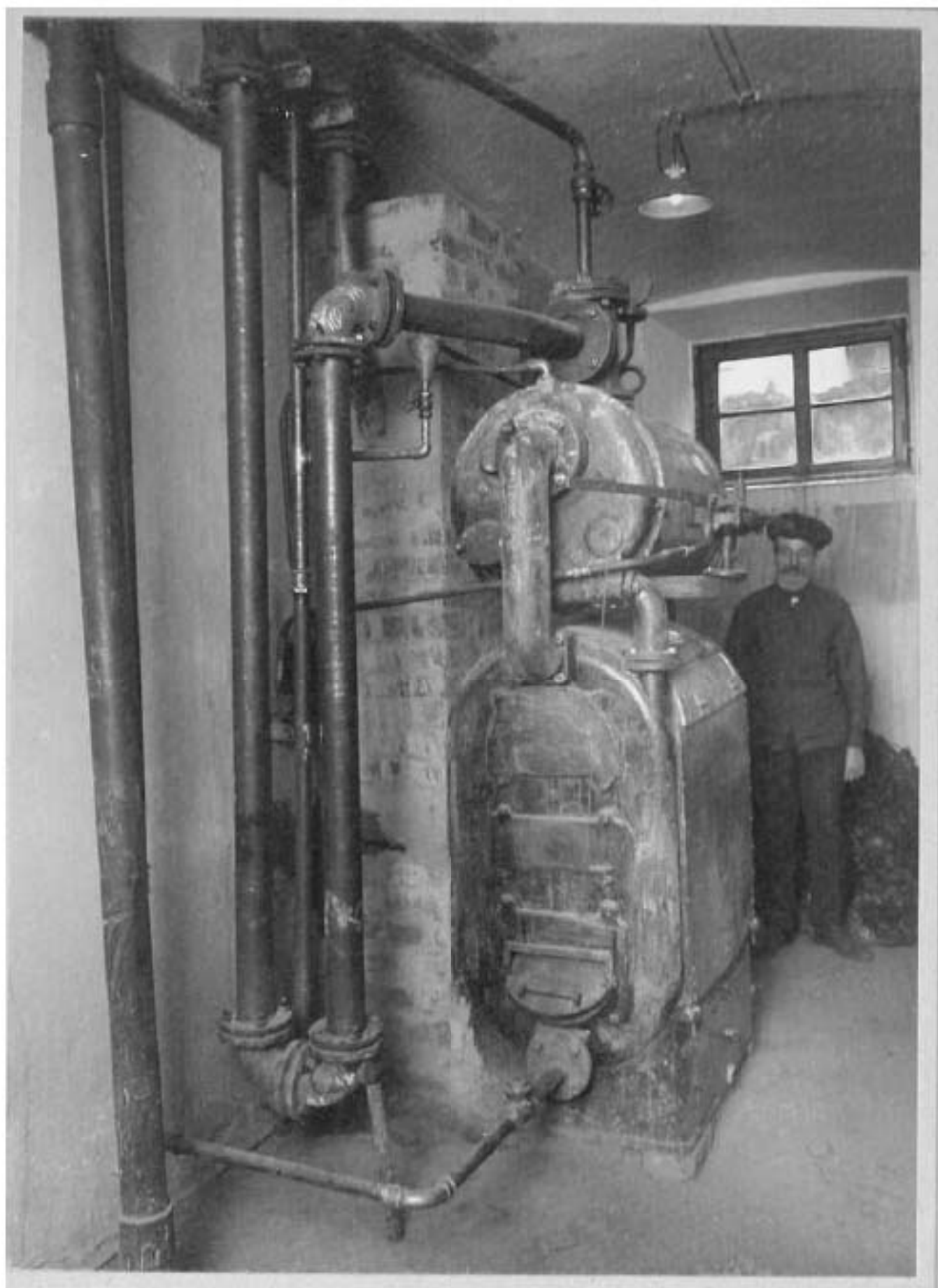
Ил. 75. Рабочий в котельной госпиталя. 1914-1916 гг. ЦГАКФФД СПб П 358 сн.29
