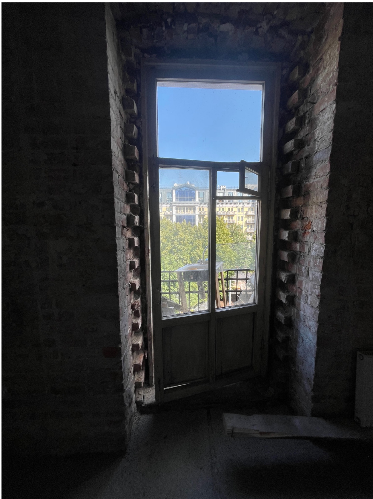
11.Балконное дверное заполнение.
