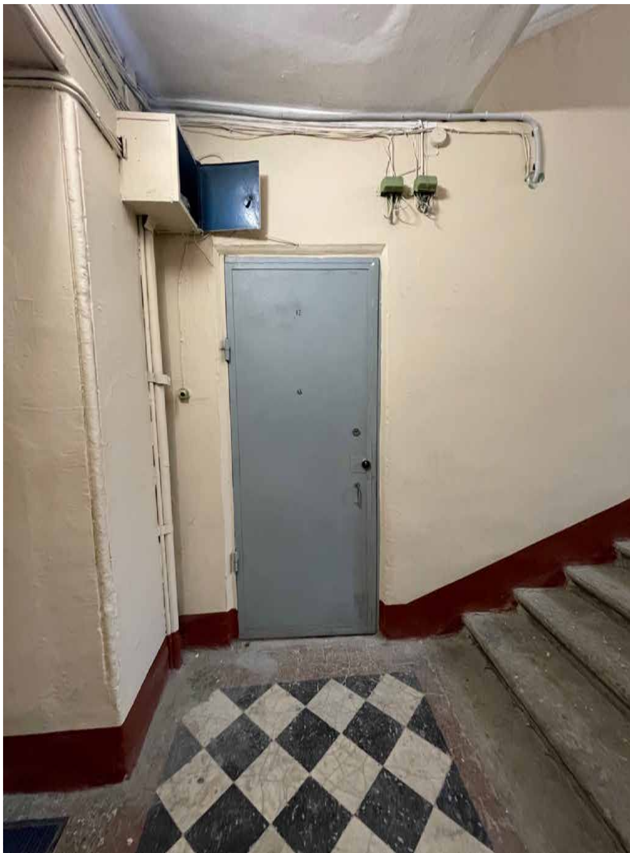
6. Входная дверь квартиры № 12.
