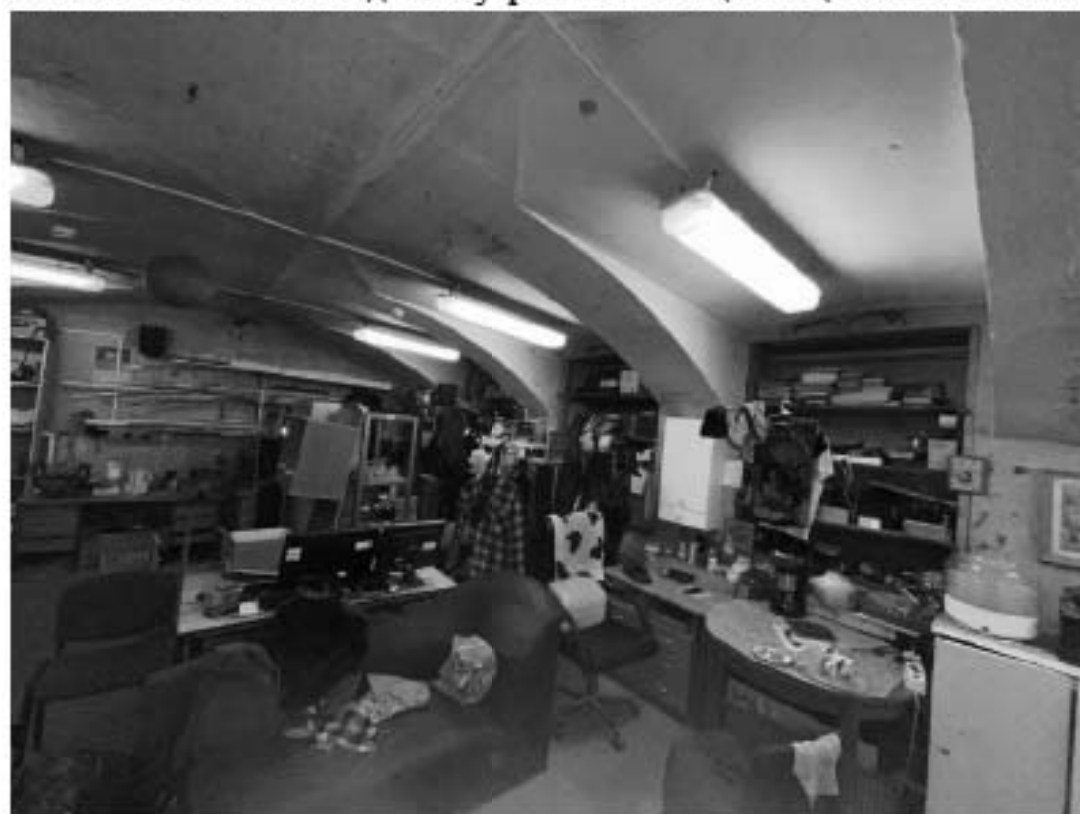
Фото 220. Выявленный объект культурного наследия «Здание Марининской женской гимназии». Вид на внутренние помещения цокольного этажа.
