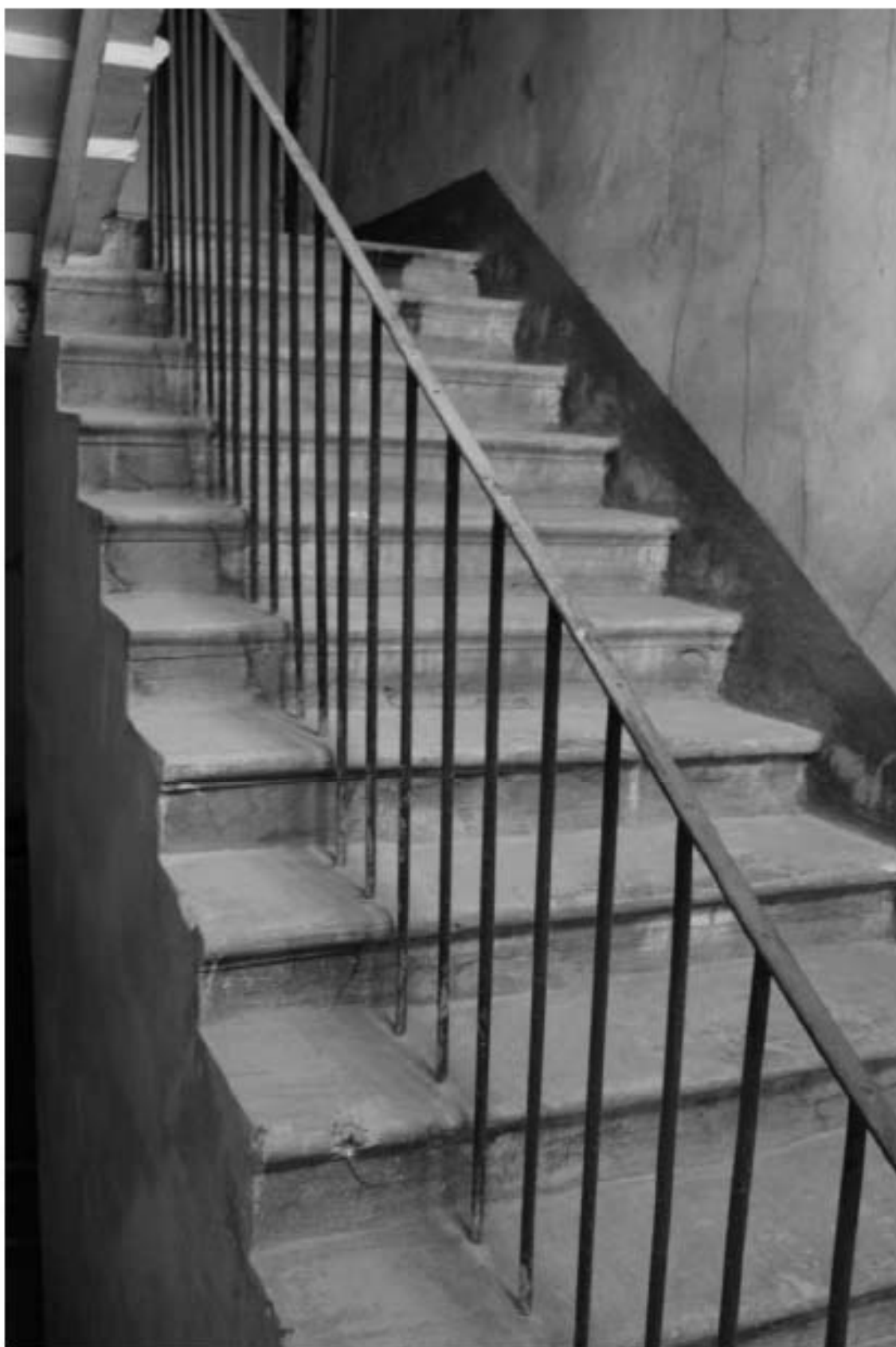
Фото 160. Выявленный объект культурного наследия «Здание Марининской женской гимназии». Вид на лестницу 9ЛК (ул. Ломоносова, д. 11-13, лит. А) в уровне 3-го – 4-го этажей.
