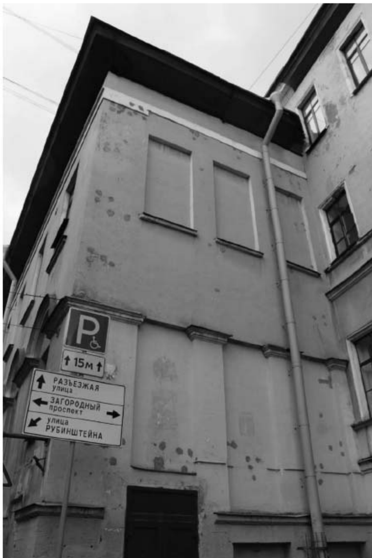
Фото 40. Вид на лицевой (торцевой) фасад двухэтажной части двух-четырёхэтажного корпуса выявленного объекта культурного наследия «Здание Марининской женской гимназии».
