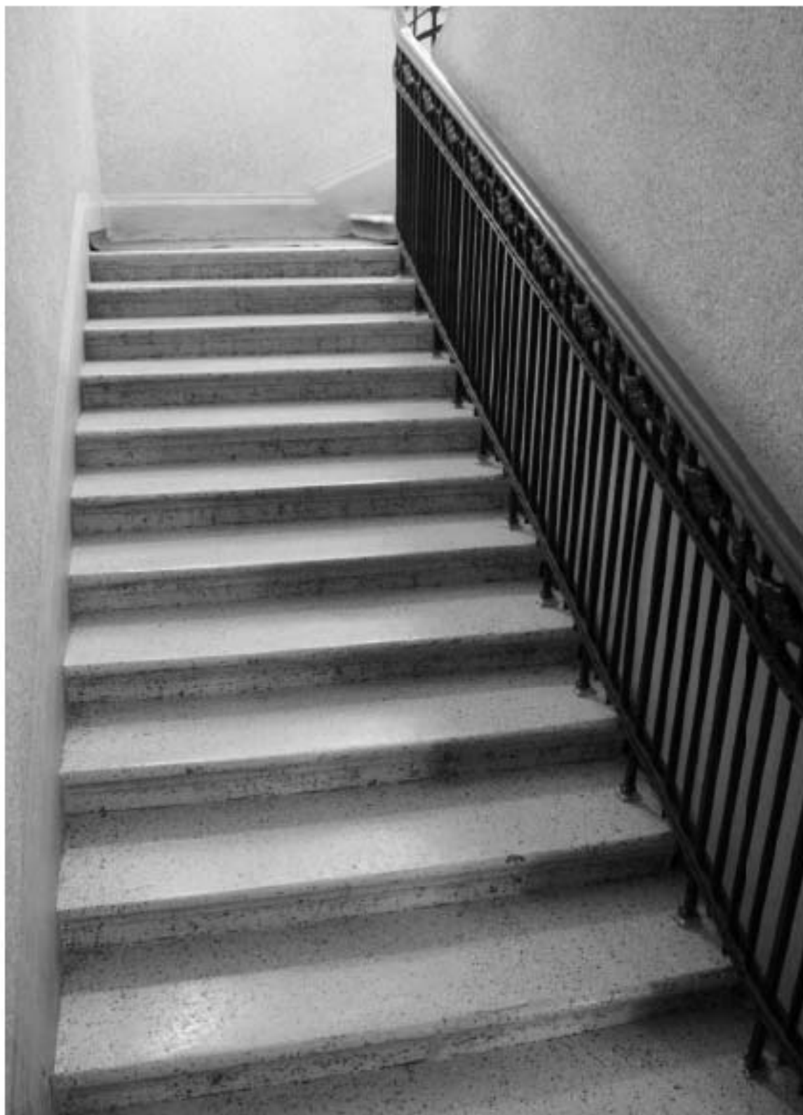
Фото 55. Выявленный объект культурного наследия «Доходный дом». Вид на лестницу 2ЛК в уровне 1-го этажа.
