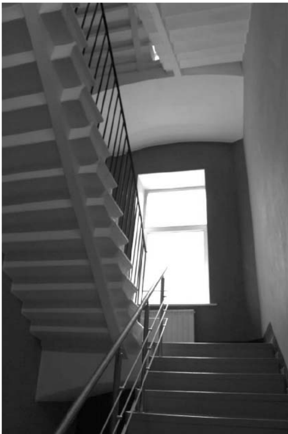
Фото 211. Выявленный объект культурного наследия «Здание Марининской женской гимназии». Вид на лестницу 5ЛК (Загородный пр., д. 13, лит. А) в уровне 1-го – 2-го этажей.
