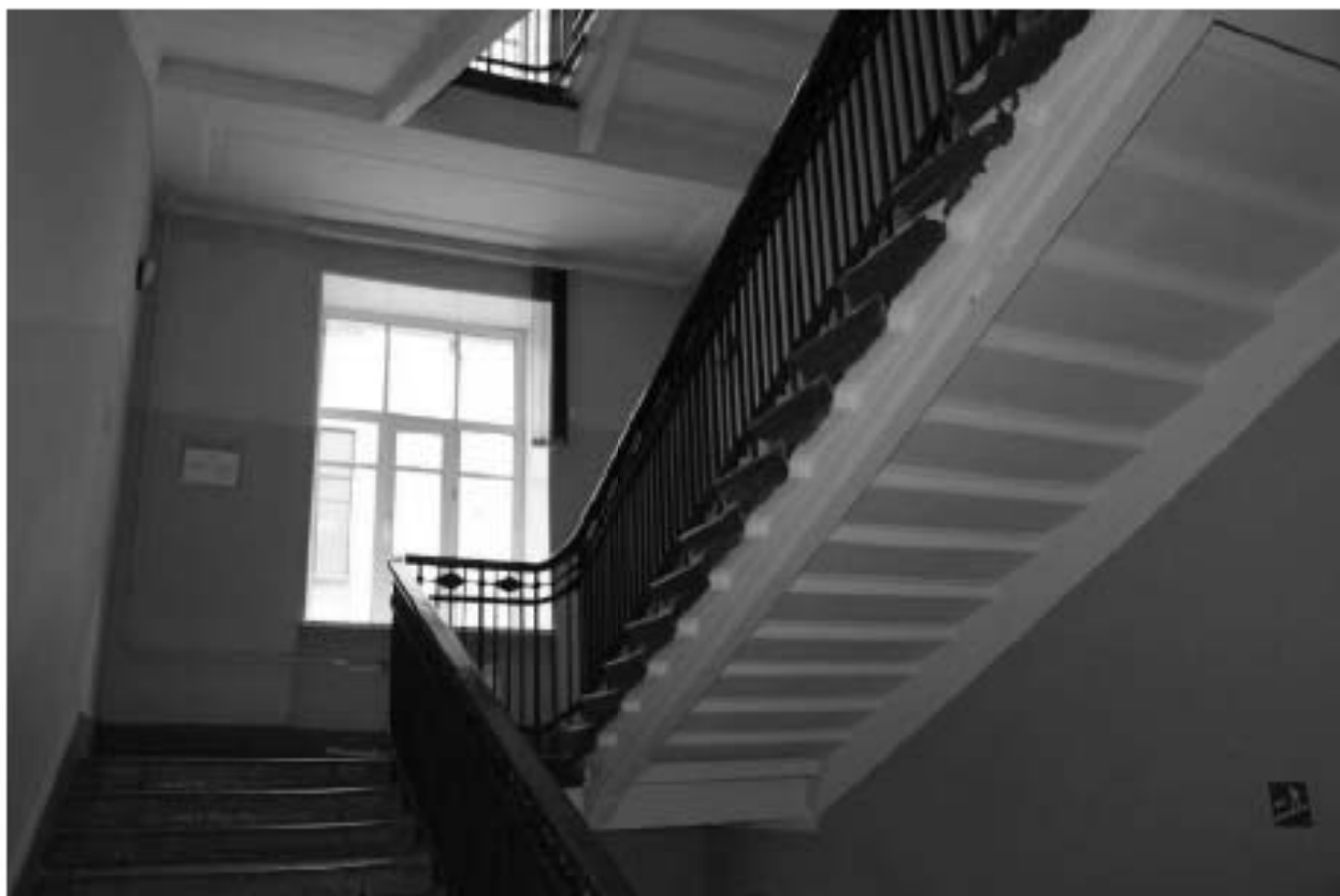
Фото 92. Выявленный объект культурного наследия «Доходный дом». Вид на лестницу 4ЛК в уровне 2-го – 3-го этажей.
