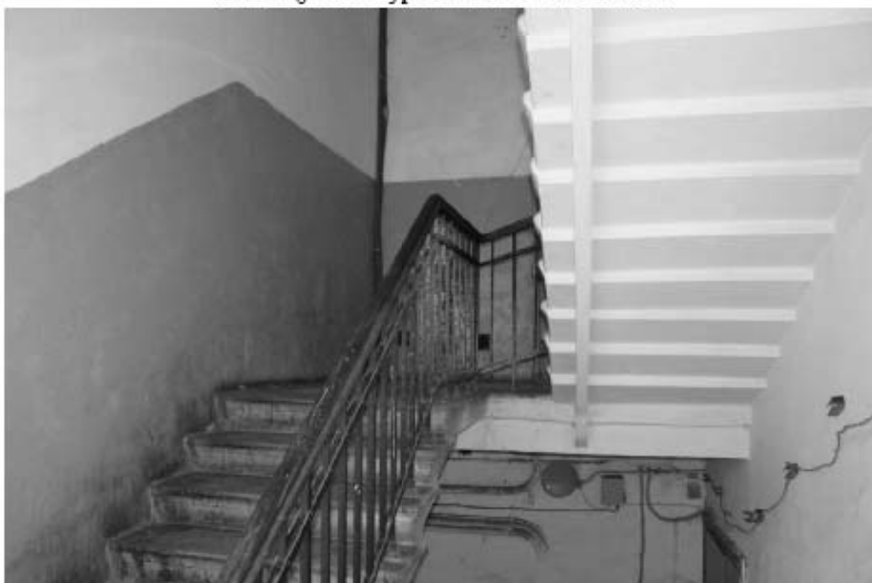
Фото 114. Выявленный объект культурного наследия «Доходный дом». Вид на лестницу БЛК в уровне 2-го этажа.
