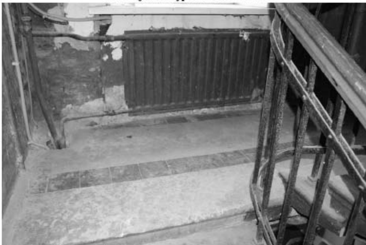
Фото 71. Выявленный объект культурного наследия «Доходный дом». Вид на лестницу 3ЛК в уровне 1-го – 2-го этажей.
