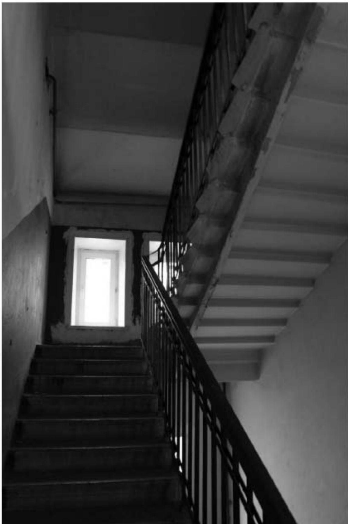
Фото 106. Выявленный объект культурного наследия «Доходный дом». Вид на лестницу 5ЛК в уровне 5-го – чердачного этажей.
