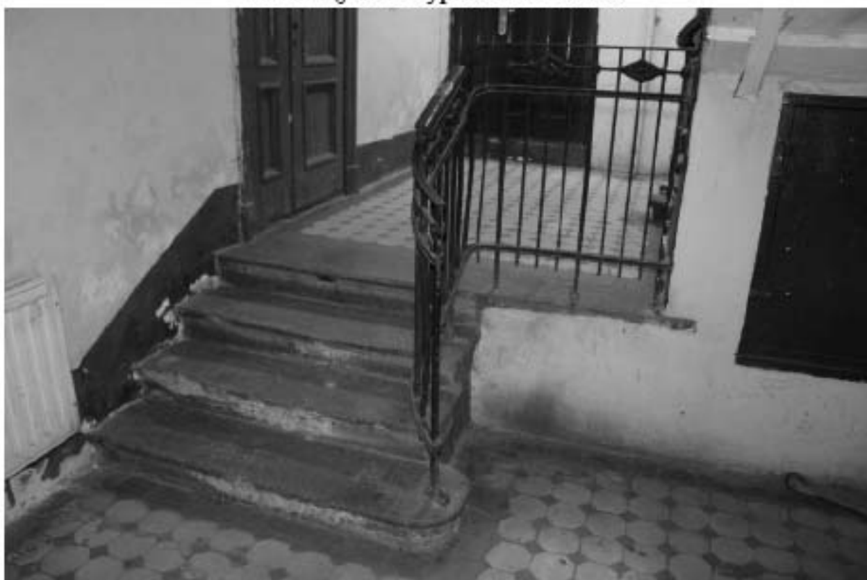
Фото 124. Выявленный объект культурного наследия «Доходный дом». Вид на лестницу 7ЛК в уровне 1-го этажа.
