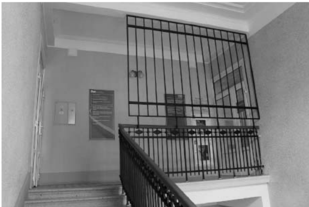
Фото 64. Выявленный объект культурного наследия «Доходный дом». Вид на лестницу 2ЛК в уровне 5-го этажа.
