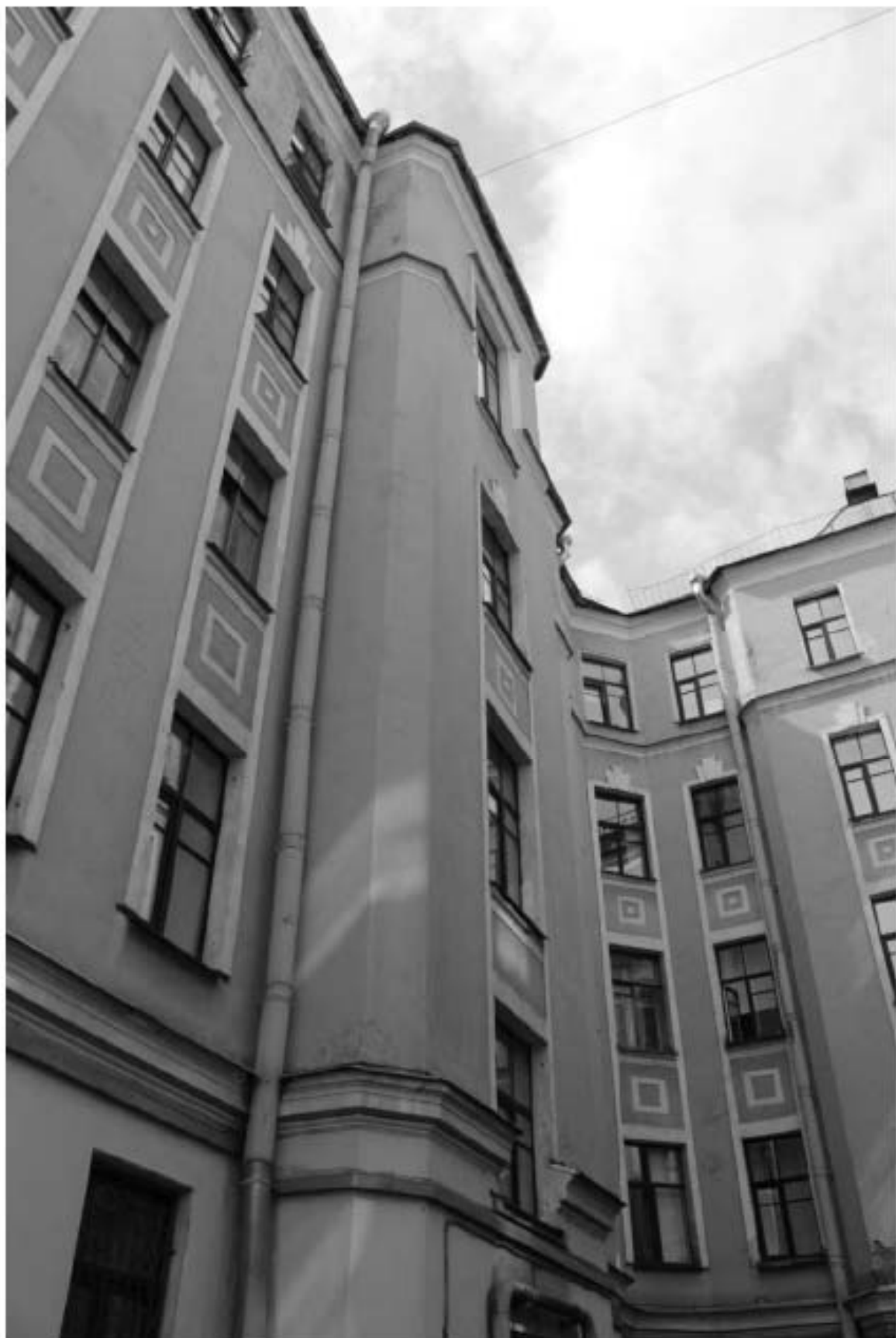
Фото 22. Вид на фасады выявленного объекта культурного наследия «Доходный дом», обращенные во внутренний двор.
