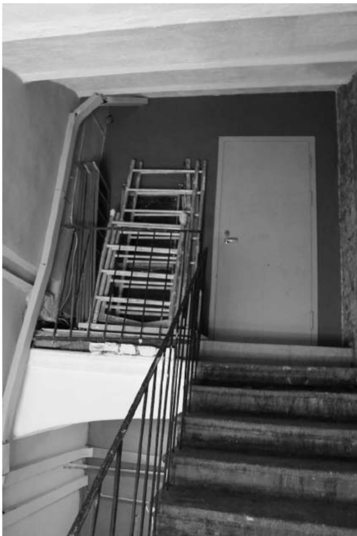
Фото 216. Выявленный объект культурного наследия «Здание Марининской женской гимназии». Вид на лестницу 5ЛК (Загородный пр., д. 13, лит. А) в уровне мансардного этажа.
