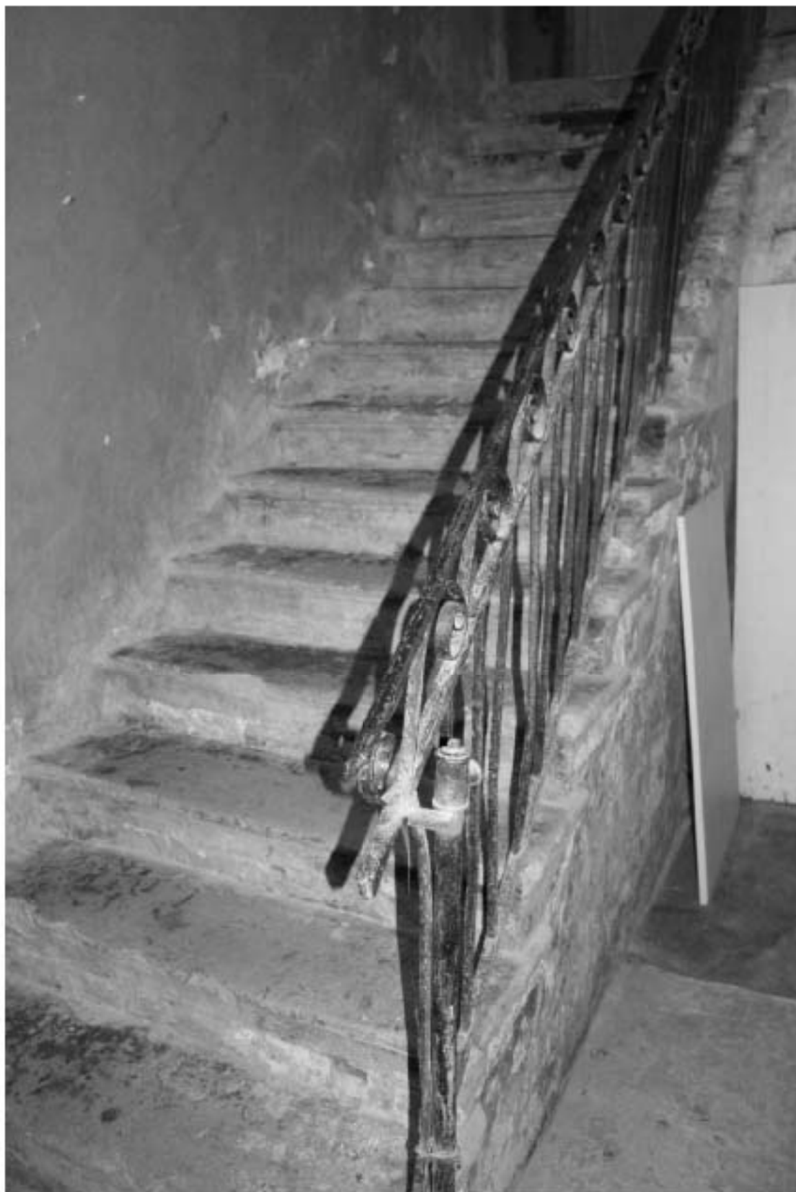
Фото 173. Выявленный объект культурного наследия «Здание Марининской женской гимназии». Вид на лестницу 12ЛК (ул. Ломоносова, д. 11-13, лит. А) в уровне 1-го этажа.
