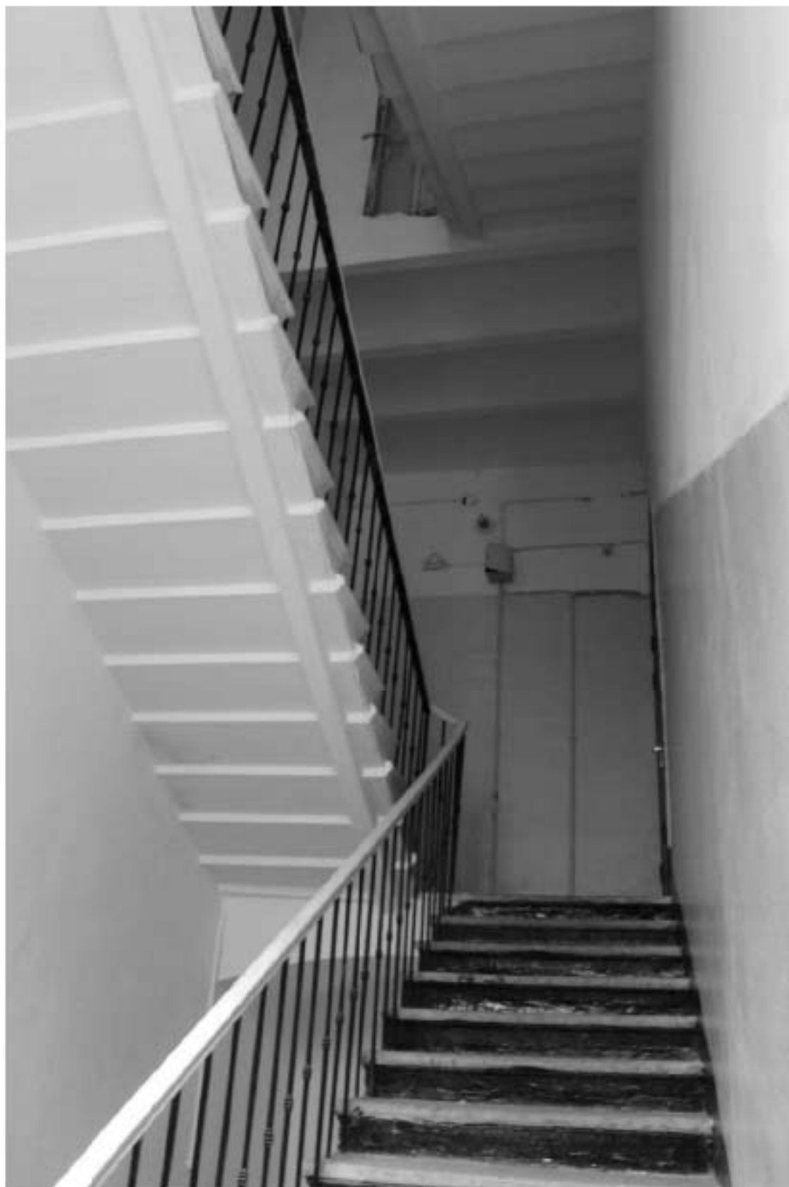
Фото 186. Выявленный объект культурного наследия «Здание Марининской женской гимназии». Вид на лестницу 11ЛК по ул. Ломоносова, д. 11-13, лит. А, 6ЛК по Загородному пр., д. 13, лит. А в уровне 3-го этажа.
