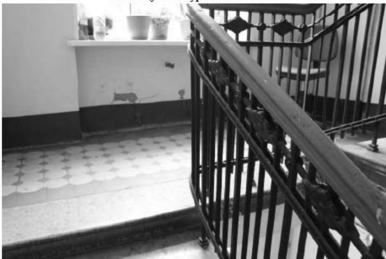
Фото 132. Выявленный объект культурного наследия «Доходный дом». Вид на лестницу 7ЛК в уровне 4-го – 5-го этажей.
