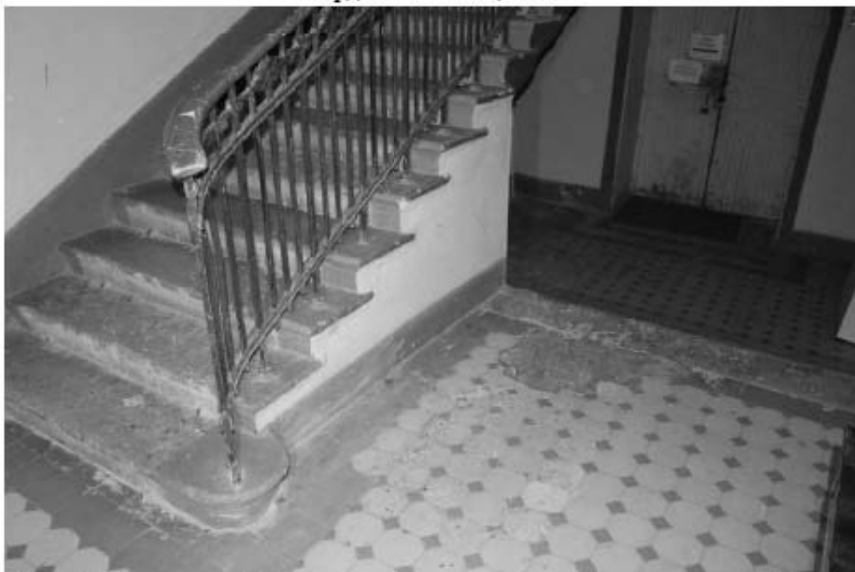
Фото 86. Выявленный объект культурного наследия «Доходный дом». Вид на лестницу 4ЛК в уровне 1-го этажа.
