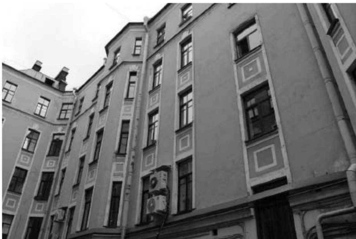
Фото 20. Вид на фасады выявленного объекта культурного наследия «Доходный дом», обращенные во внутренний двор.
