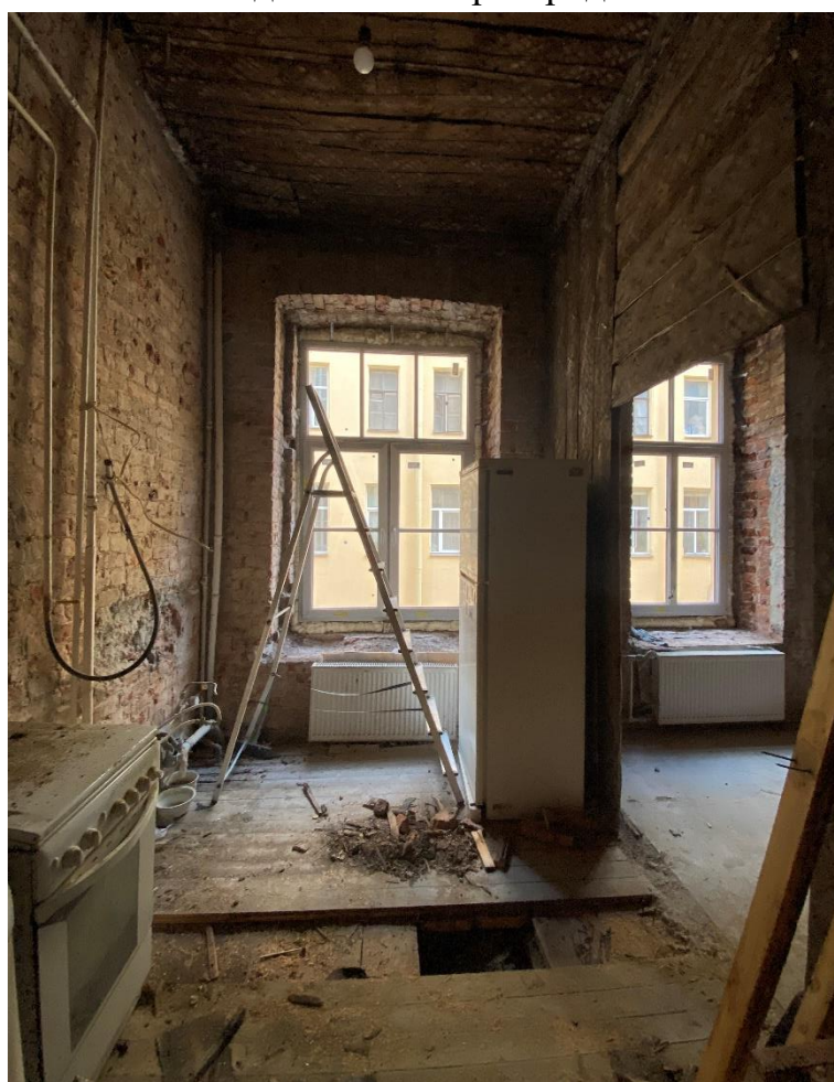
Фото 18. Помещение 1, вид на окно – нарушена расстекловка.
