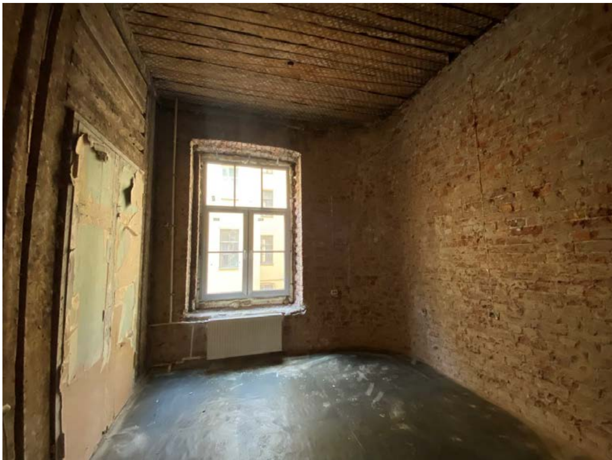
Фото 11. Помещение 7, вид на окно – нарушена расстекловка.
