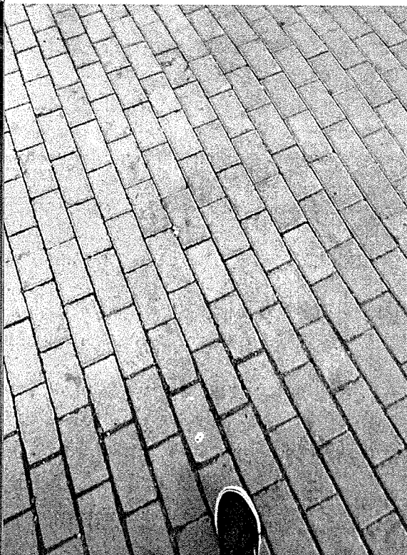
Фрагмент тротуарной плитки на территории объекта
