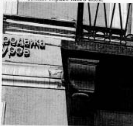
13. Южный лицевой фасад. Фрагмент. Повреждения окрасочного слоя.
