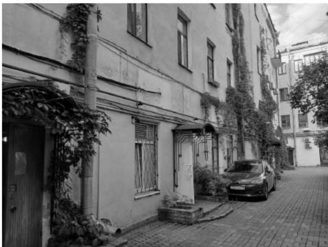
47. «Дом Яковлевых» (ул. Маяковского, д. 1/96, лит. А). Дворовые фасады. Фото мест установки оборудования и прокладки кабельных трасс. Штиглиц М.С. 05.08.2025.
