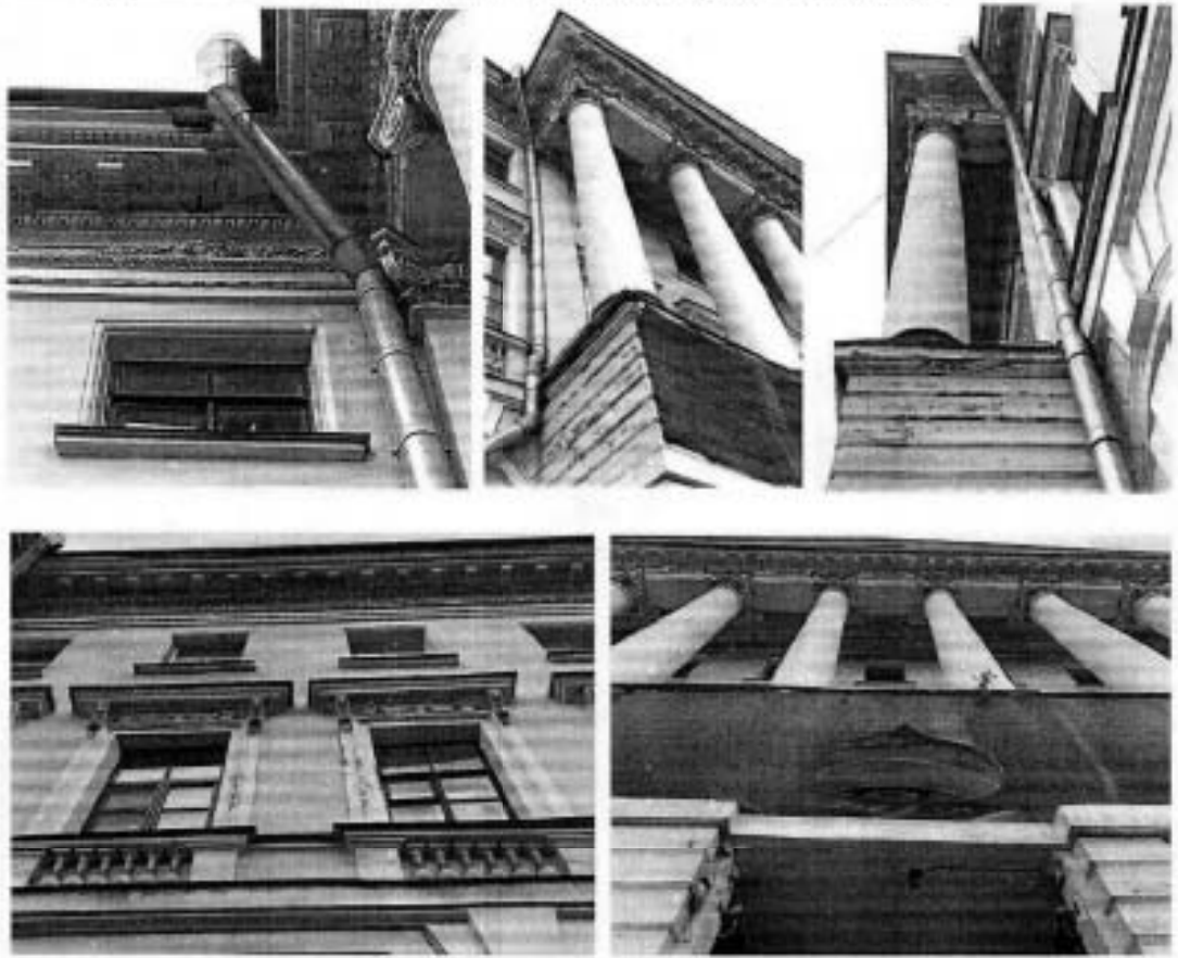
23-27. Дефекты восточного лицевого фасада по Марсовому полю (17.11.2021).
