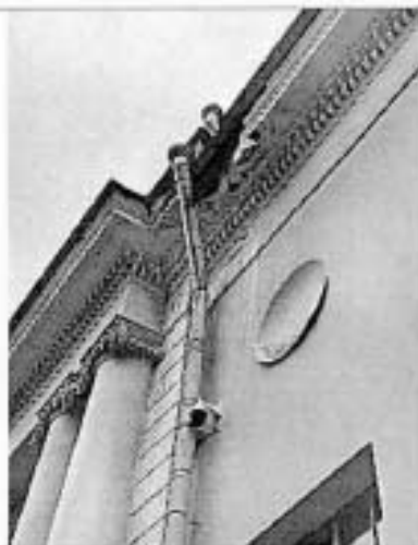
Фото 5. Фрагмент разрушения карнизного свеса (по Инженерной ул.)
